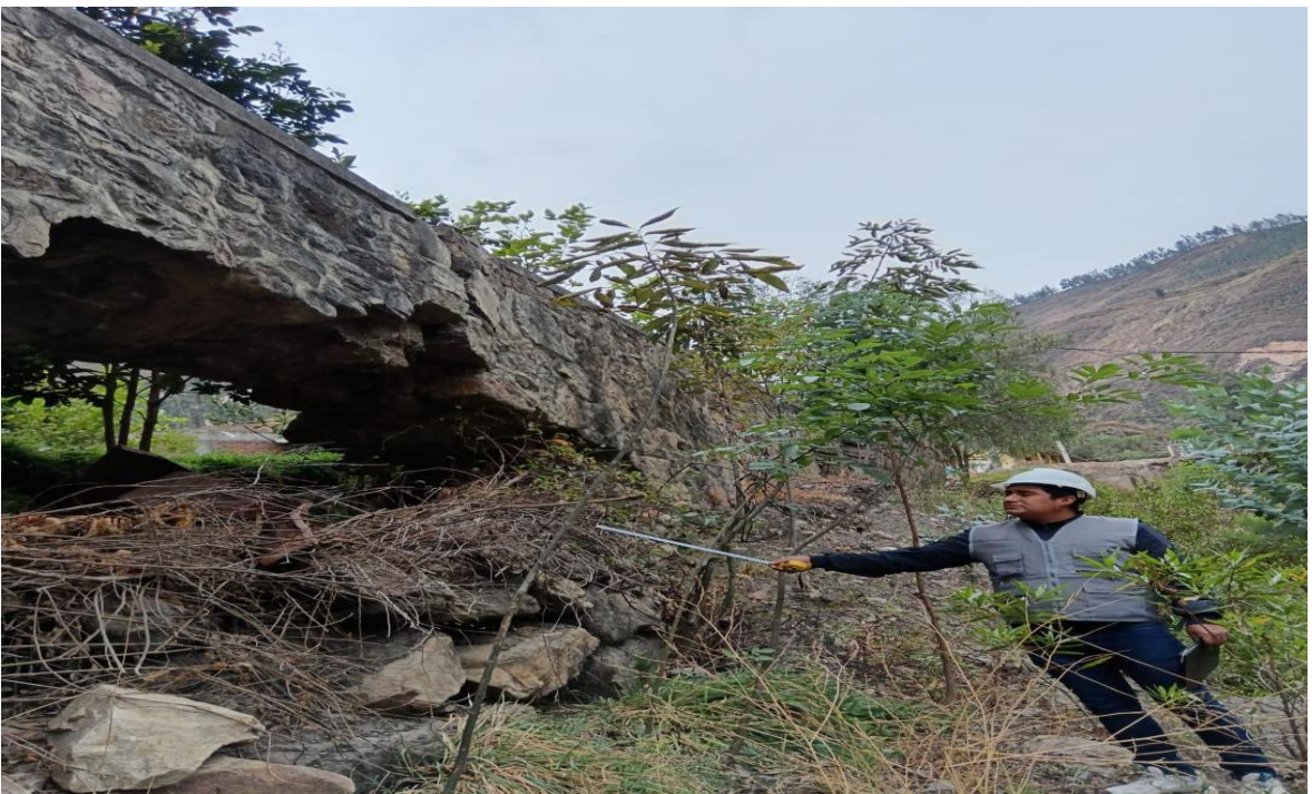
Figura N°13: En la imagen se puede apreciar la falla del muro de mampostería de piedra.
