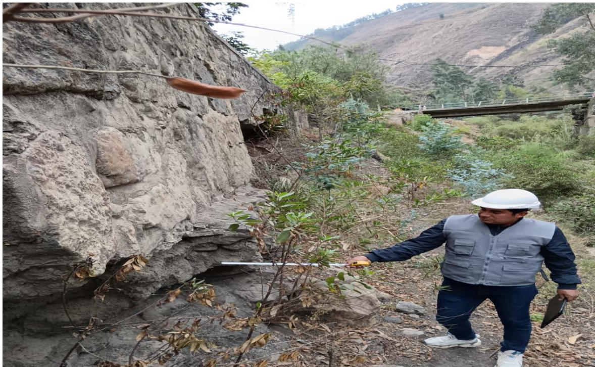
Figura N° 15: Se aprecia falla en la base del muro.
