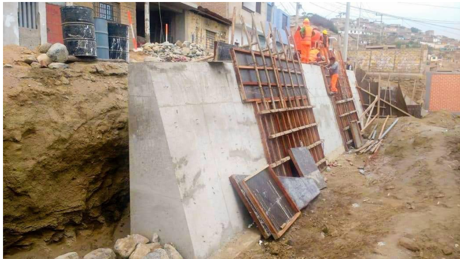
Figura 7: Vulnerabilidad de un muro de contención
