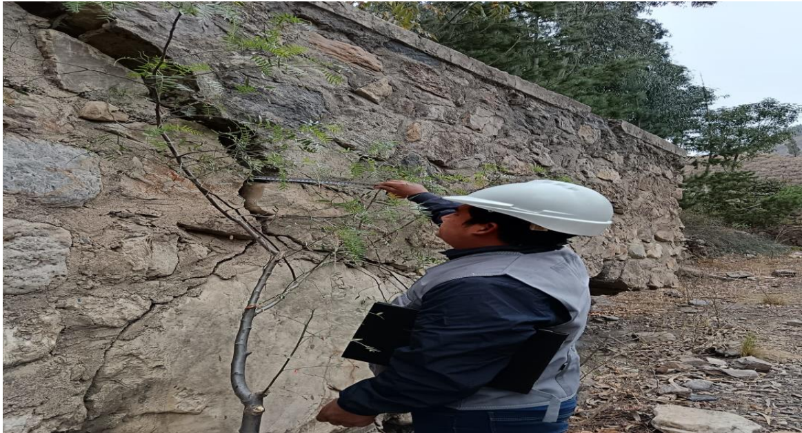
Figura N° 14: En la imagen se puede apreciar que el muro de mampostería presenta grieta.
