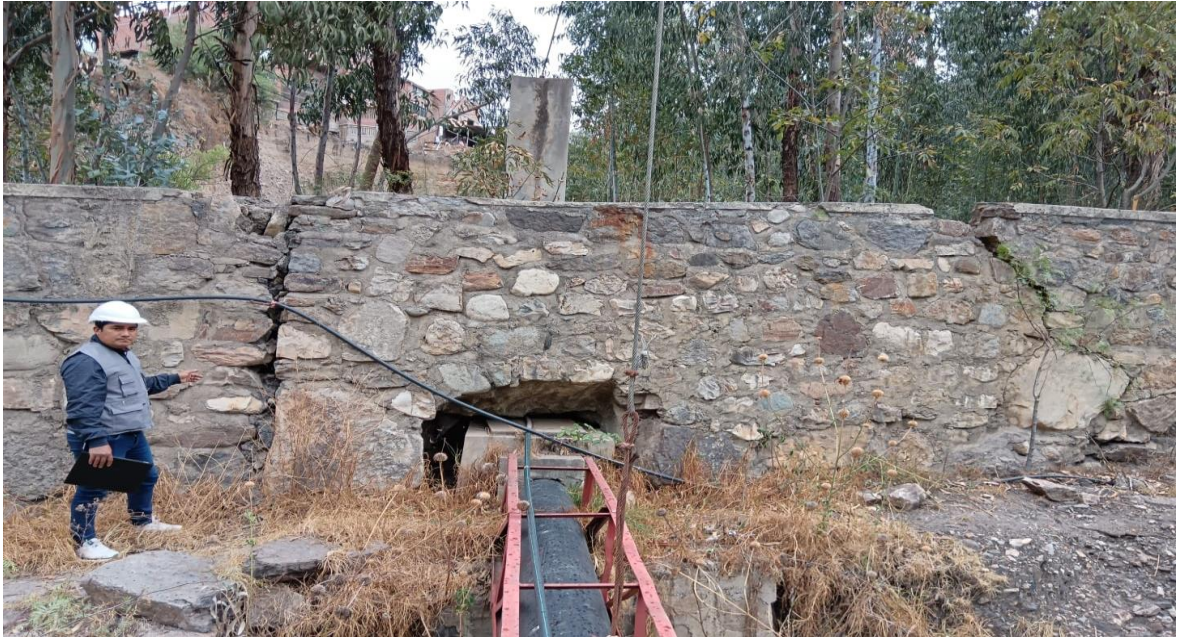
Figura N°12: En la imagen se puede apreciar que se realizó una perforación al muro debilitando la estructura.
