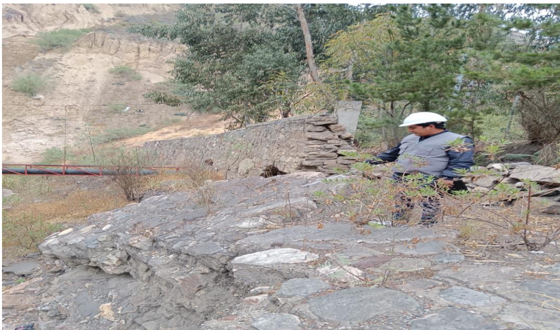
Figura N°9: En la imagen se puede apreciar el colapso del muro de la defensa ribereña
