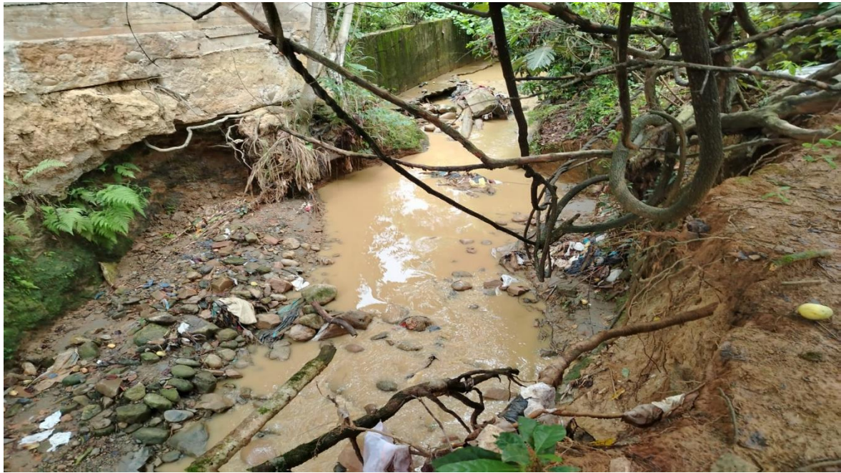
Figura 55 Socavación en vivienda
