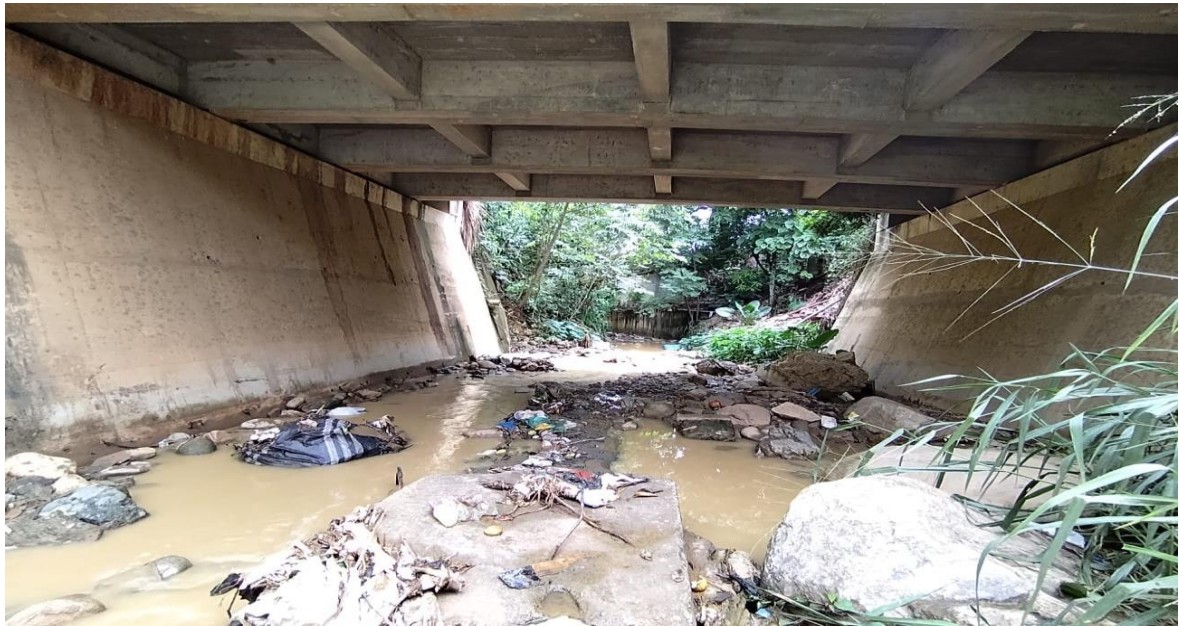
Figura 49 Acumulación de materiales
