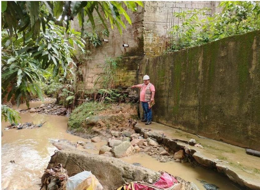
Figura 18 Socavación en bases de una vivienda y la defensa ribereña existente
