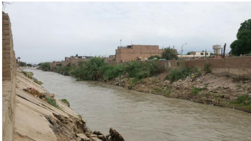
Figura 2 Caída de defensa ribereña en río Ica por erosión
