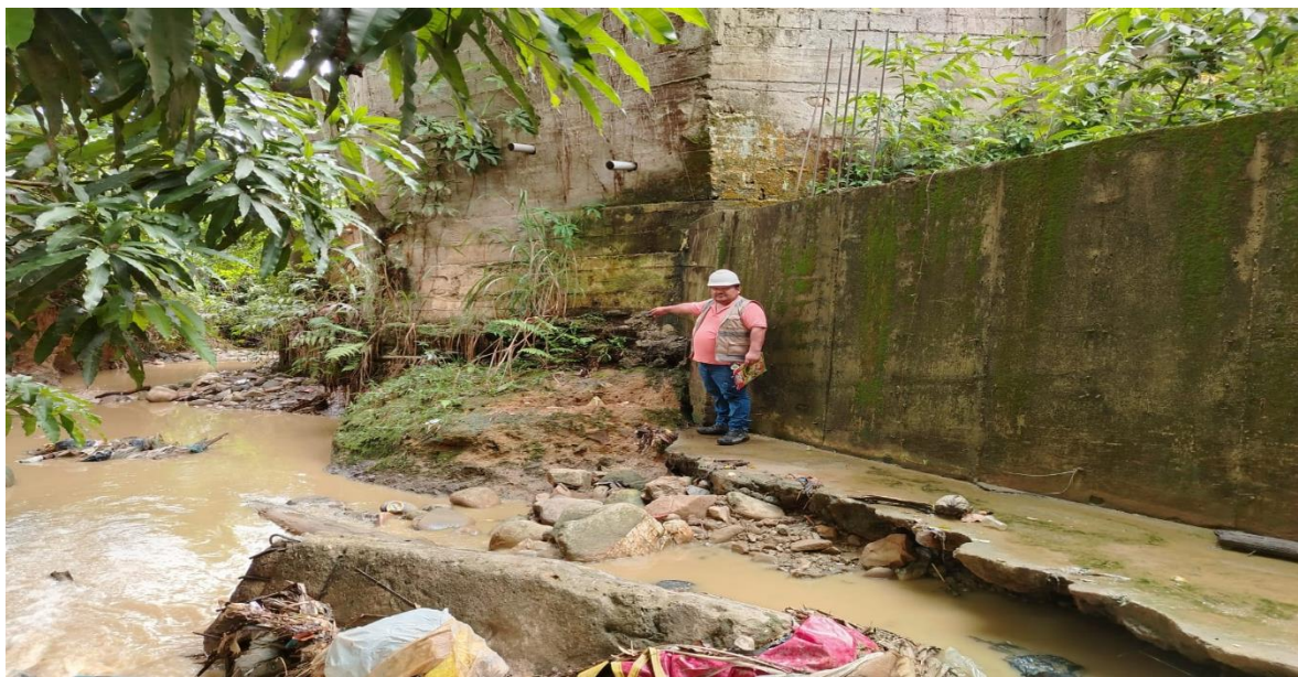
Figura 54 Socavación en la defensa ribereña
