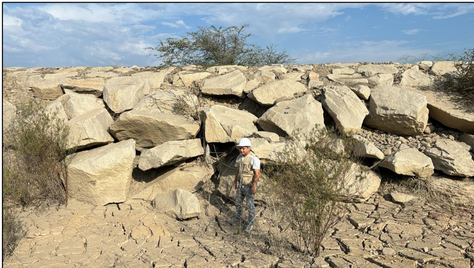
Figura 26: Desprendimiento de rocas en el tramo 1+100 km Fuente: Elaboración propia 2024
