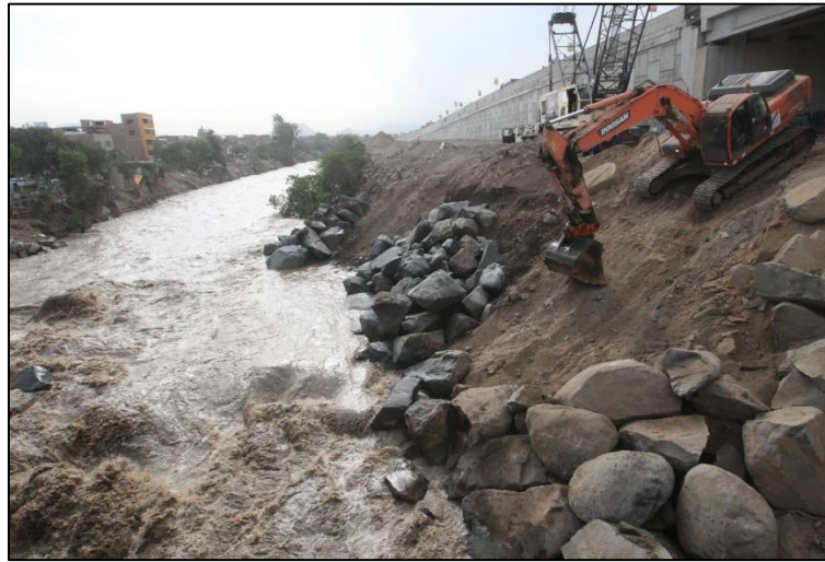
Figura 10: Erosión del río Rímac Fuente: Andina, 2019
