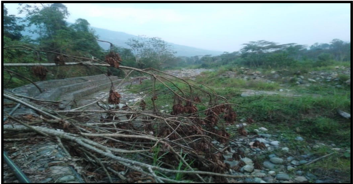
Figura 6: Árbol caído sobre los gaviones
