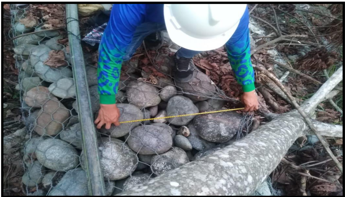
Figura 12: Rotura de malla
