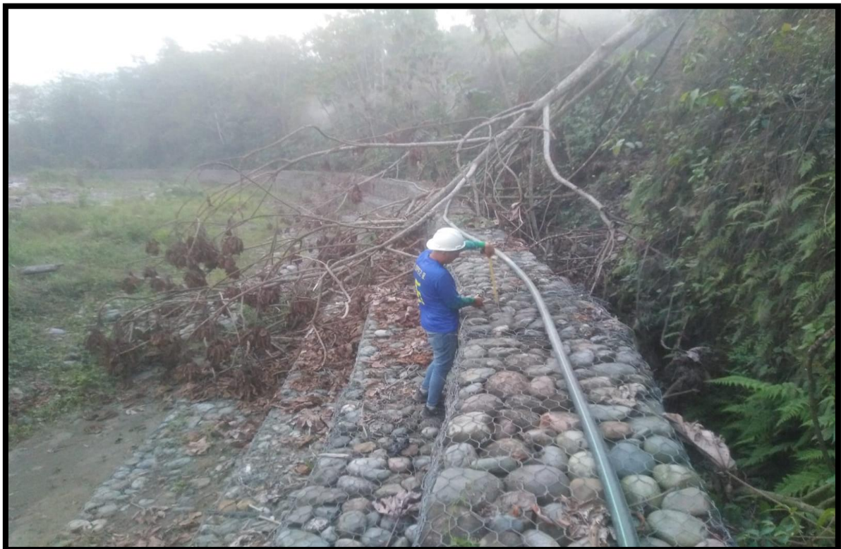
Figura 14: Medición de los vacíos entre roca y malla
