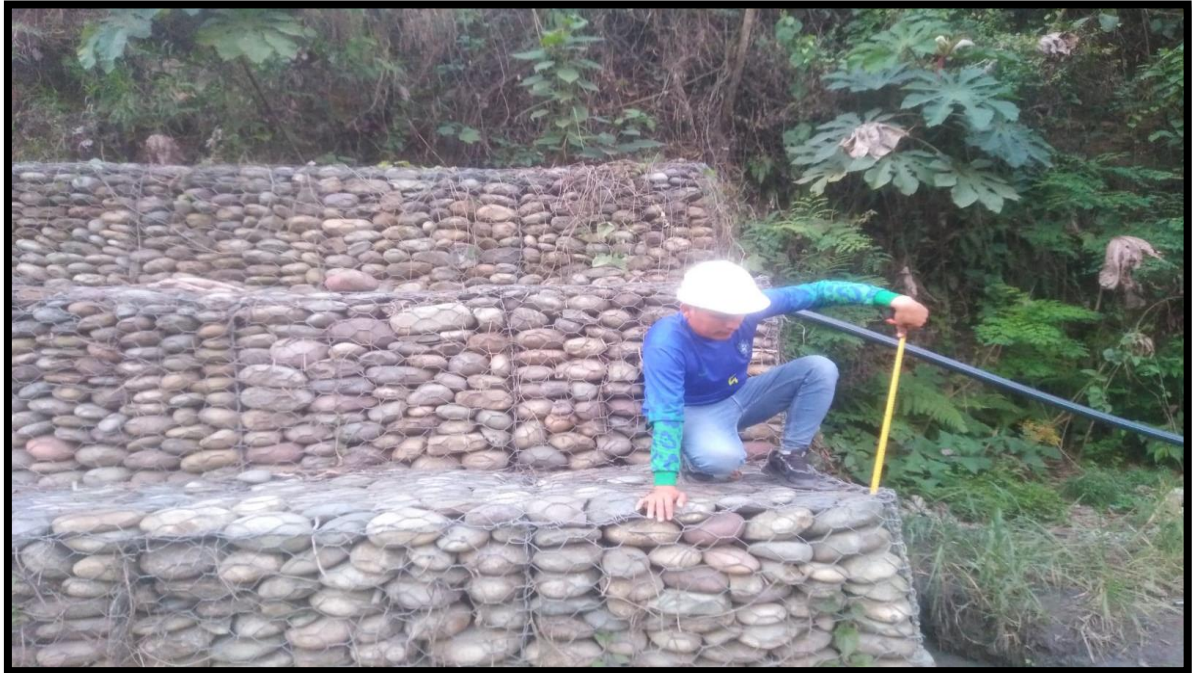
Figura 15: Escombros sobre los gaviones
