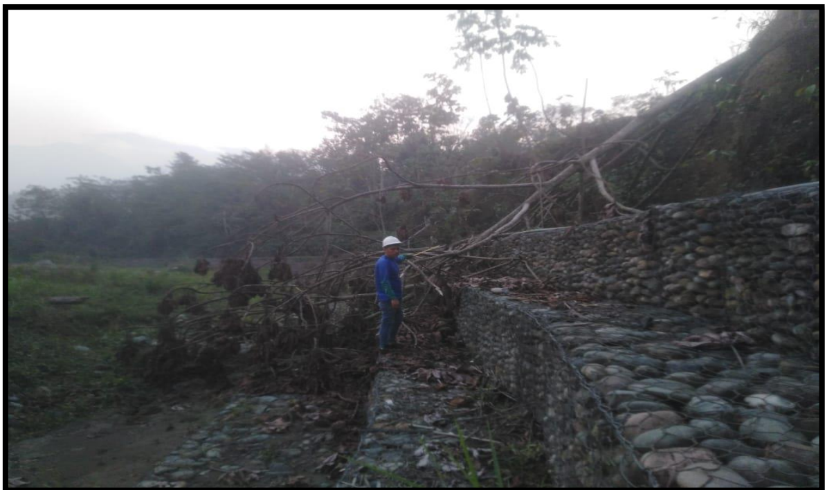
Figura 4: Escombros sobre los gaviones
