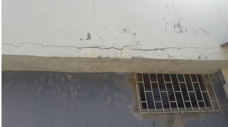
Fig. 07 Presencia de Fisuras en Fachada en el A.H María Goretti Mz H lote 8
