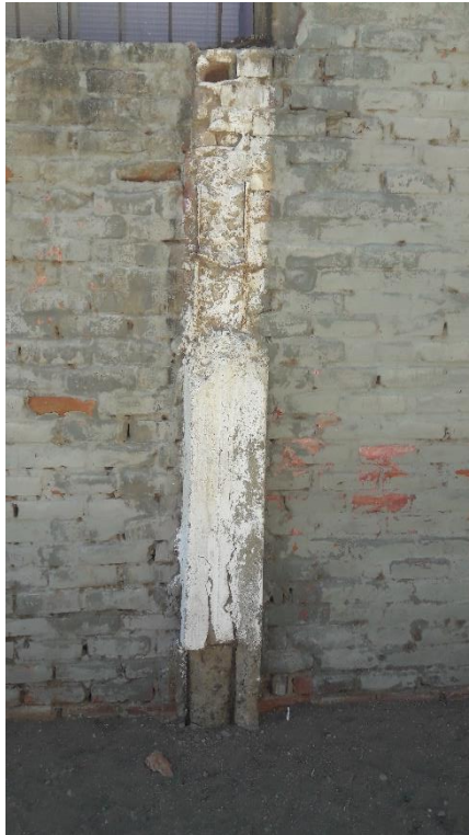
Fig.05 Acero expuesto y Corroído en columna del cerco perimétrico de la I.E 15511 “San Martín de Porras” Pariñas Talara-Piura
