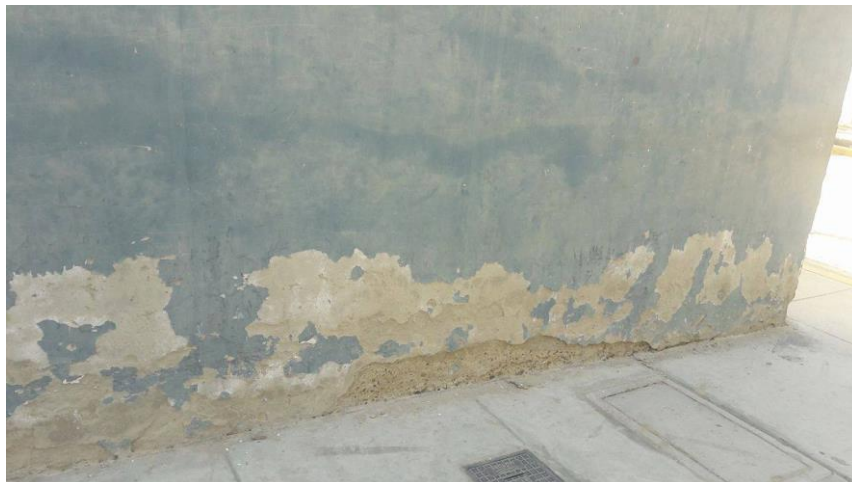
Fig. 06 Desprendimiento de Concreto y Pintura de Fachada en el A.H María Goretti Mz H lote 8 Fam. Campos Ojeda
