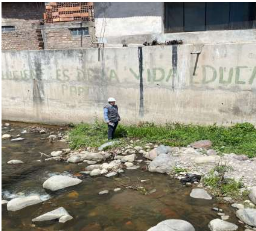
VISTA ATRAS PROGRESIVA 2+600- 2+650 MARGEN IZQUIERDO:SE PUEDE OBSERVAR EL MURO DE CONCRETO ARMADO EXISTENTE Y POCO VEGETACION. EL RIO LLEVANDOSE POCO ALGUNOS RESTANTES CONCRETO DE AÑOS
