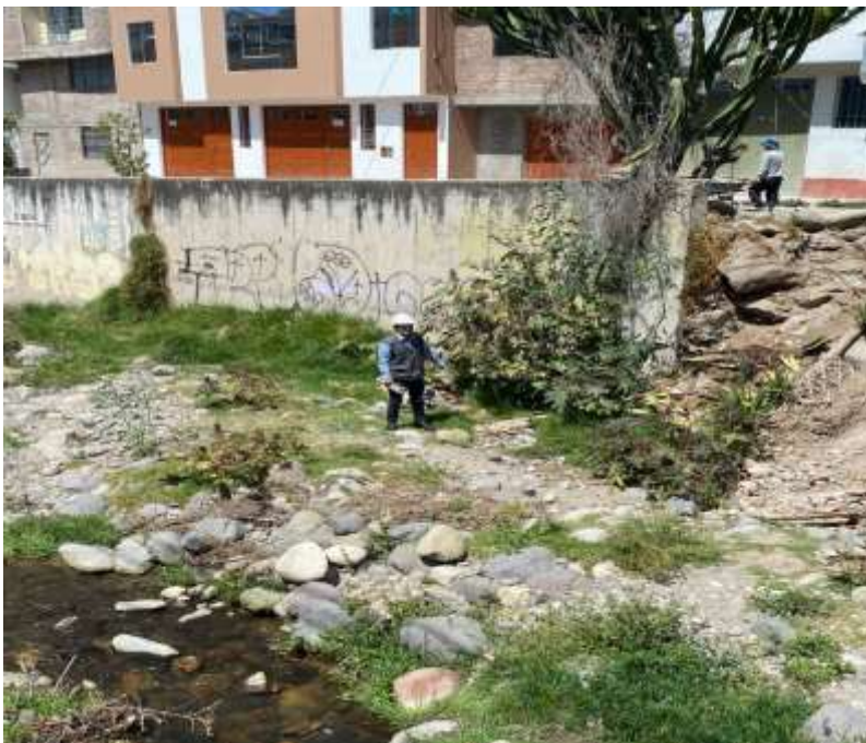
VISTA ATRAS PROGESIVA 2+700- 2+750 MARGEN IZQUIERDO:SE PUEDE OBSERVAR EL MURO DE CONCRETO ARMADO EN UNA PARTE Y EL OTRO YA DERRUMBADO Y POCO VEGETACION
