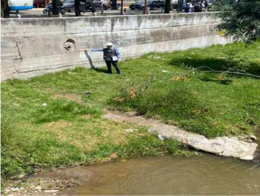
VISTA ADELANTE PROGESIVA 2+350- 2+400 MARGEN IZQUIERDO:SE PUEDE OBSERVAR EL MURO DE CONCRETO ARMADO EXISTENTE Y MUCHA VEGETACION
