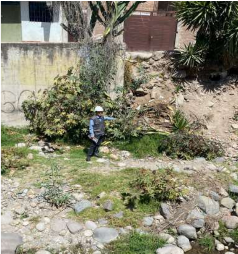
VISTA ADELANTE PROGESIVA 2+700- 2+750 MARGEN IZQUIERDO:SE PUEDE OBSERVAR EL MURO DE CONCRETO ARMADO EN UNA PARTE Y EL OTRO YA DERRUMBADO Y POCO VEGETACION
