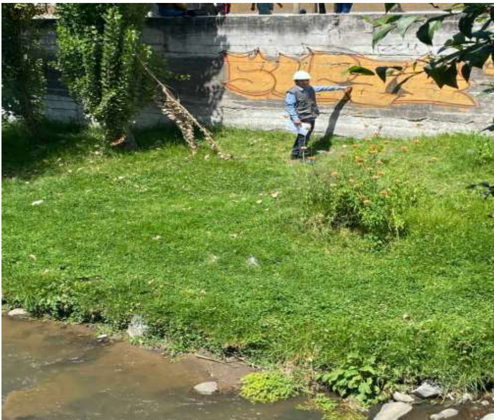
VISTA ATRAS PROGRESIVA 2+400- 2+450 MARGEN IZQUIERDO:SE PUEDE OBSERVAR EL MURO DE CONCRETO ARMADO EXISTENTE Y MUCHA VEGETACION CON ACERCAMIENTO DEL RÍO
