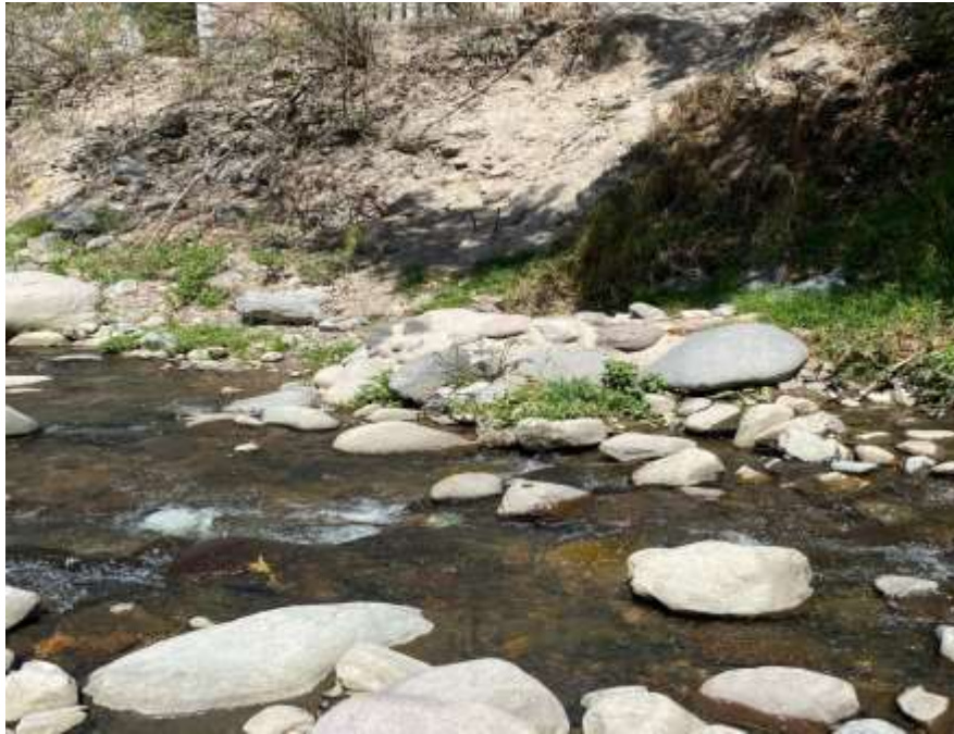
VISTA ATRÁS PROGRESIVA MARGEN IZQUIERDO: DESPRENDIMIENTO DEL MURO DE CONCRETO ARMADO POR LOS AÑOS DE ANTIGÜEDAD
