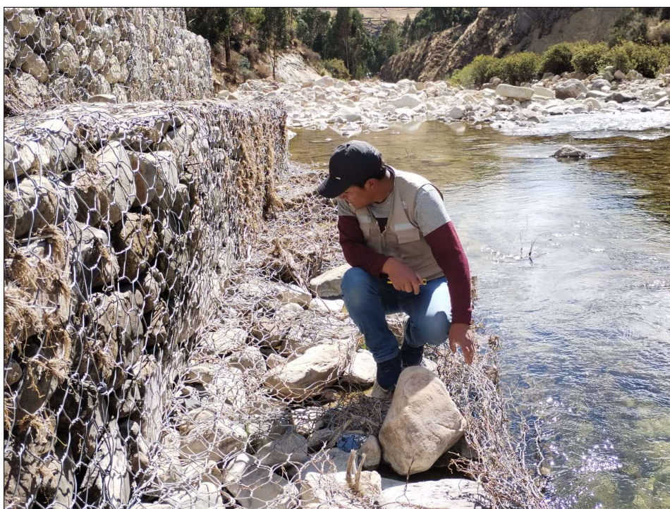
Fotografía N° 23: Evaluación de mallas deterioradas del colcho reno Fuente: Elaboración propia 2025
