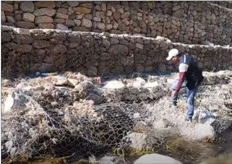
Fotografía N° 21: Perdida de material de relleno del colcho reno Fuente: Elaboración propia 2025
