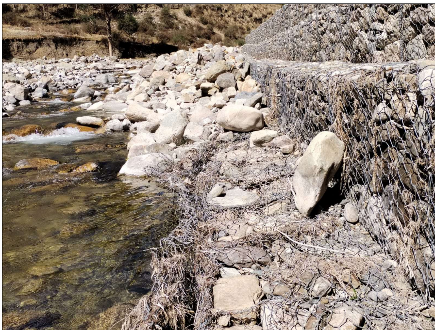
Fotografía N° 14: presencia de mallas deterioradas del colcho reno Fuente: Elaboración propia 2025
