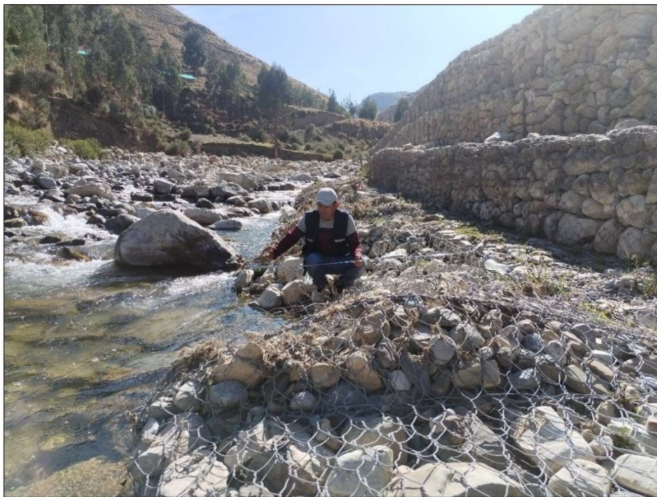
Fotografía N° 22: Perdida de material de relleno del colcho reno Fuente: Elaboración propia 2025
