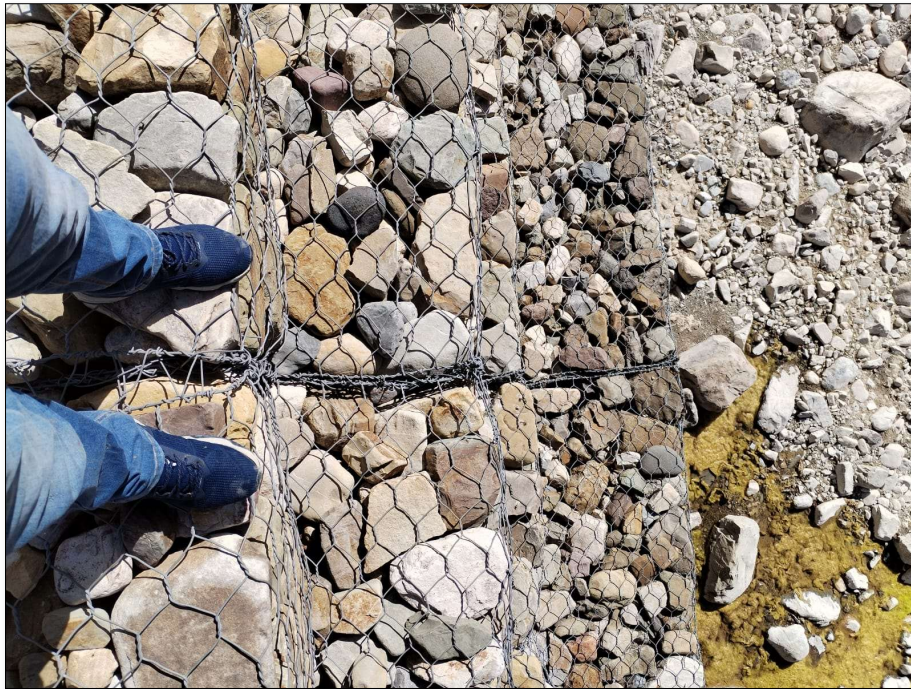
Fotografía N° 28: Evaluación de mallas deterioradas del colcho reno Fuente: Elaboración propia 2025
