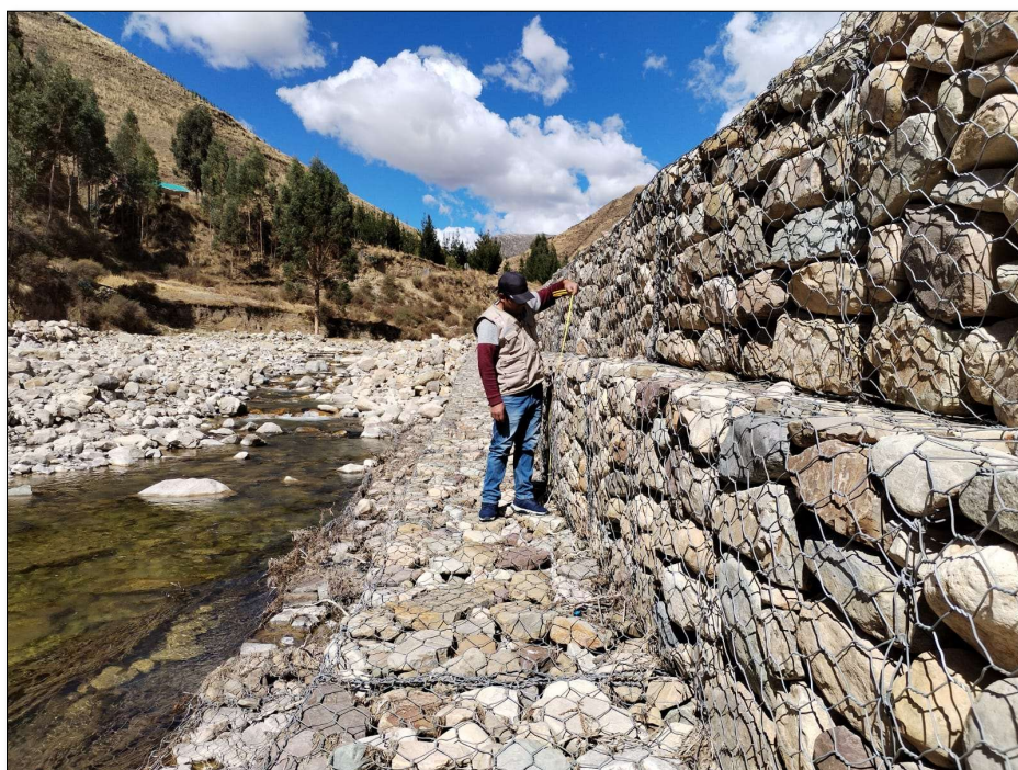
Fotografía N° 27: Evaluación de mallas deterioradas del colcho reno Fuente: Elaboración propia 2025
