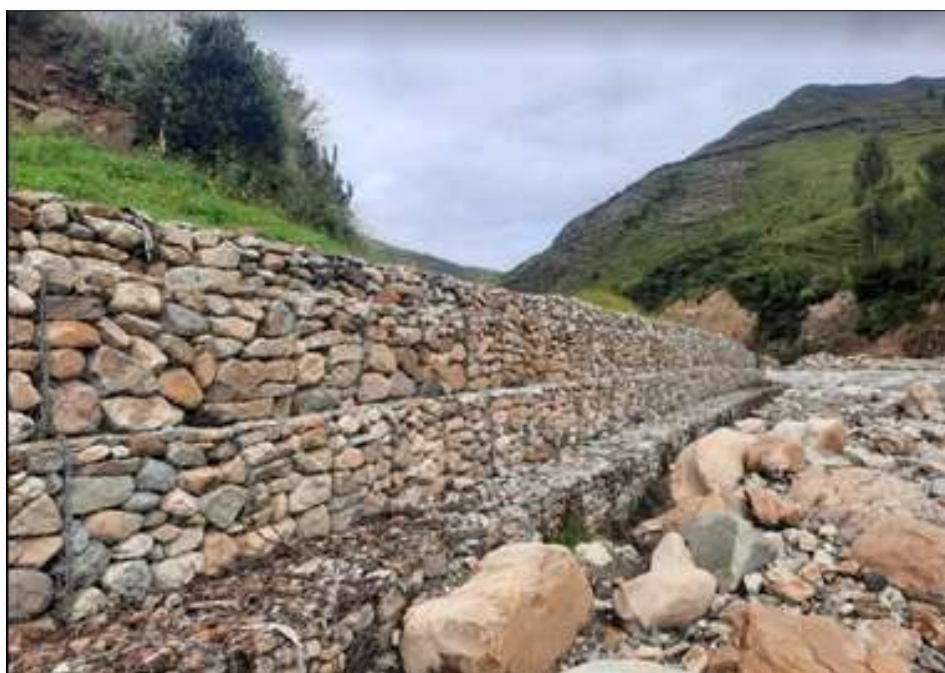
Fotografía N° 11: verificación de los daños que sufre los gaviones Fuente: Elaboración propia 2025
