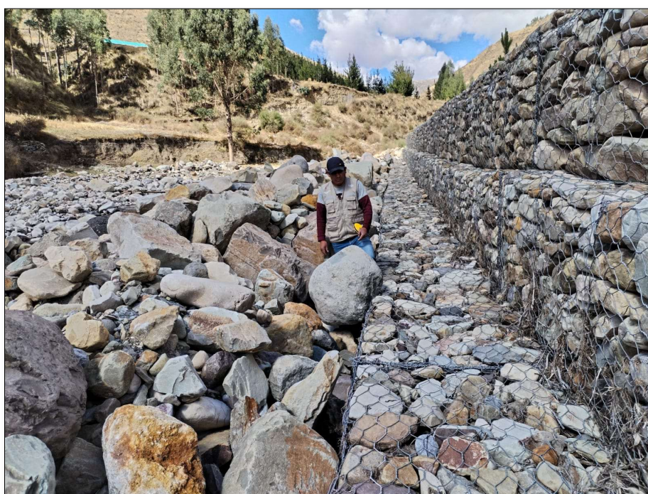
Fotografía N° 12: verificación de los daños que sufre los gaviones Fuente: Elaboración propia 2025
