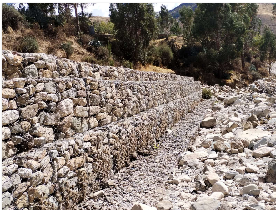
Fotografía N° 25: Evaluación de mallas deterioradas del colcho reno Fuente: Elaboración propia 2025
