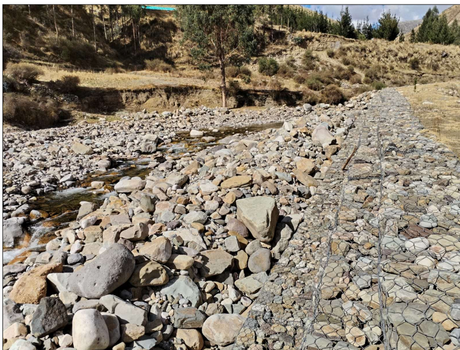
Fotografía N° 15: verificación de los daños que sufre los gaviones Fuente: Elaboración propia 2025
