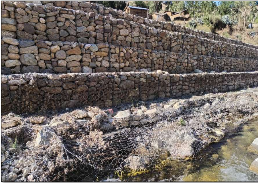
Fotografía N° 20: Mallas deterioradas del colcho reno Fuente: Elaboración propia 2025
