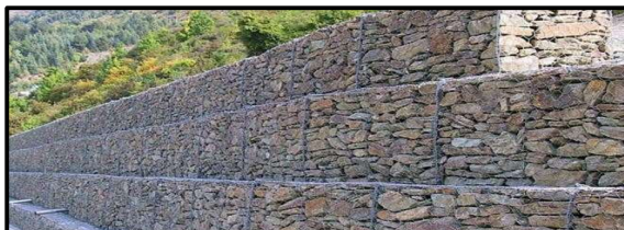
Figura 9. Muro de gaviones
