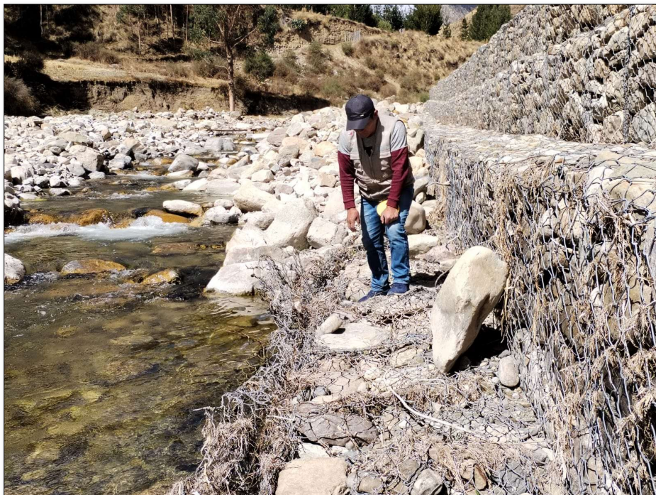
Fotografía N° 19: Evaluación de mallas deterioradas del colcho reno Fuente: Elaboración propia 2025
