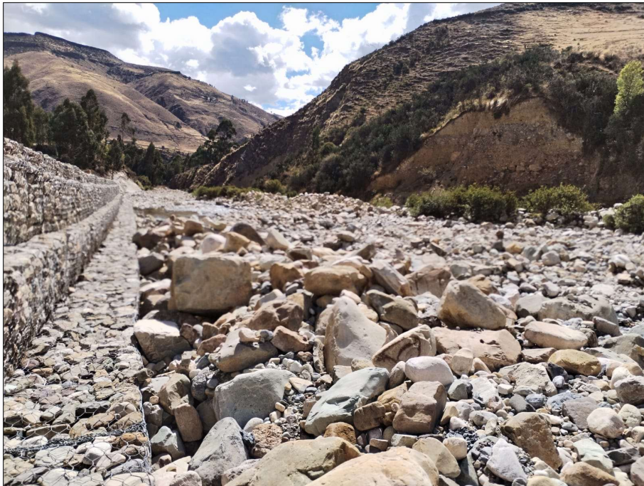
Fotografía N° 13: verificación de los daños que sufre los gaviones Fuente: Elaboración propia 2025
