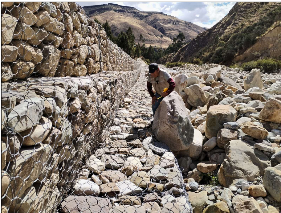
Fotografía N° 14: verificación de los daños que sufre los gaviones Fuente: Elaboración propia 2025
