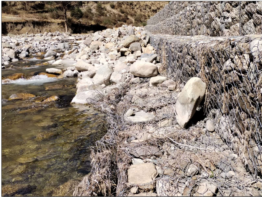
Fotografía N° 18: Evaluación de mallas deterioradas del colcho reno Fuente: Elaboración propia 2025
