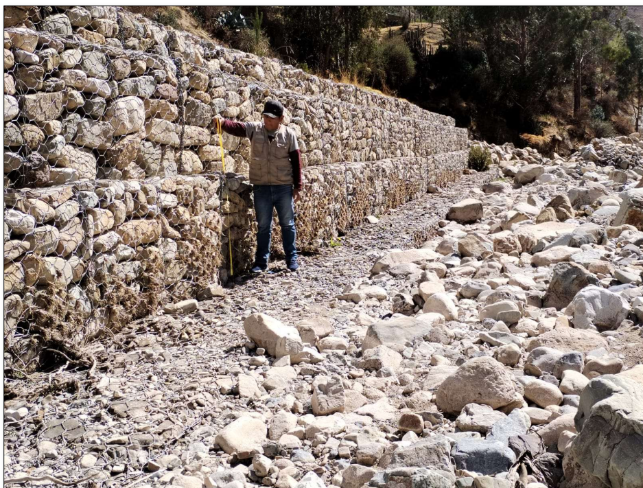
Fotografía N° 26: Evaluación de mallas deterioradas del colcho reno Fuente: Elaboración propia 2025
