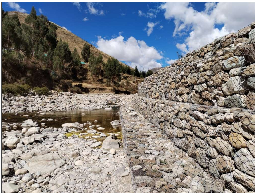
Fotografía N° 24: Evaluación de mallas deterioradas del colcho reno Fuente: Elaboración propia 2025
