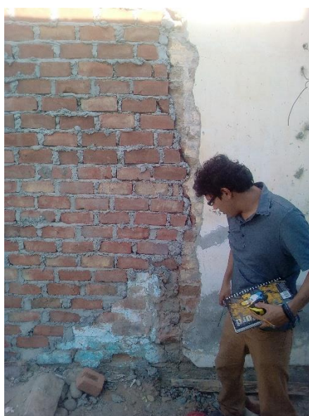
Fotografía 15: Agrietamiento en Sentido Vertical en Cerco Perimétrico de la Educativa 15029 Santa Teresa de Jesús.
