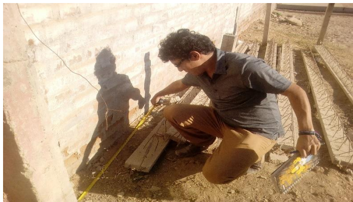
Fotografía 13: Medición horizontal de las patologías del Cerco Perimétrico de la Educativa 15029 Santa Teresa de Jesús.
