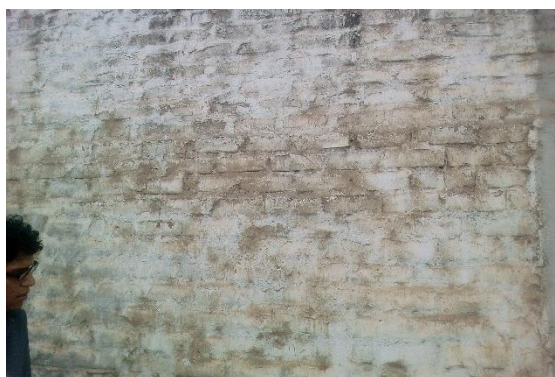
Fotografía 14: Presencia de Suciedad y Organismos en Cerco Perimétrico de la Educativa 15029 Santa Teresa de Jesús.
