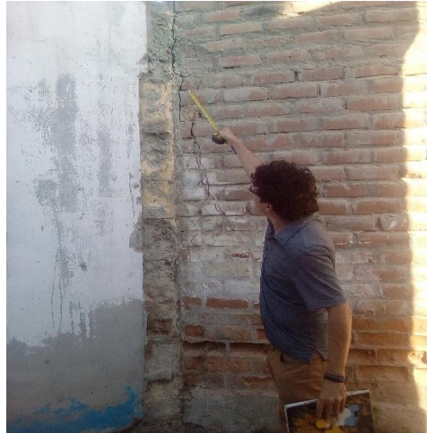
Fotografía 05: Agrietamiento en el Cerco Perimétrico.
