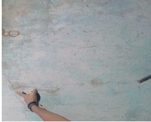
Fotografía 03: Presencia de Fisuras en el Cerco Perimétrico.
