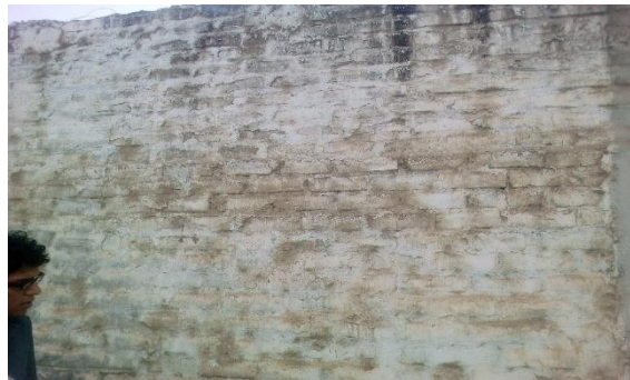
Fotografía 02: Presencia de Suciedad en el Cerco Perimétrico.
