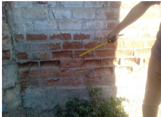
Fotografía 9: Desintegración de Ladrillos del Cerco Perimétrico.
