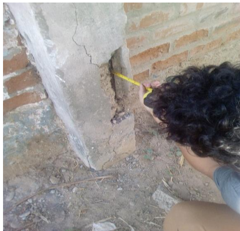
Fotografía 08: Oxidación del Acero en Columnas del Cerco Perimétrico.
