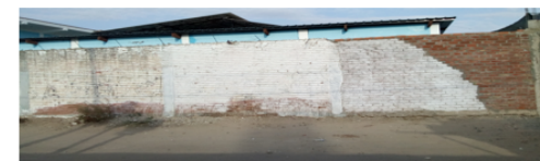
ÁREA DE PATOLOGÍA POR ELEMENTO
