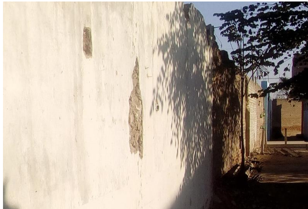
Fotografía 04: Desprendimiento de Concreto en el Cerco Perimétrico.
