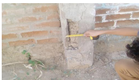
Fotografía 06: Corrosión del Acero en el Cerco Perimétrico.
