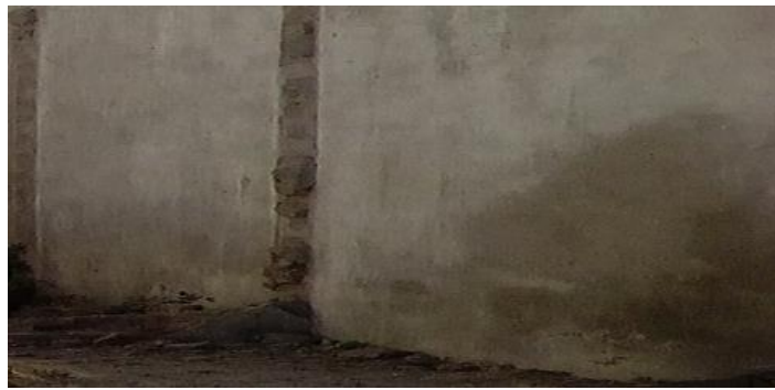
Fotografía 01: Presencia de Humedad en el Cerco Perimétrico.
