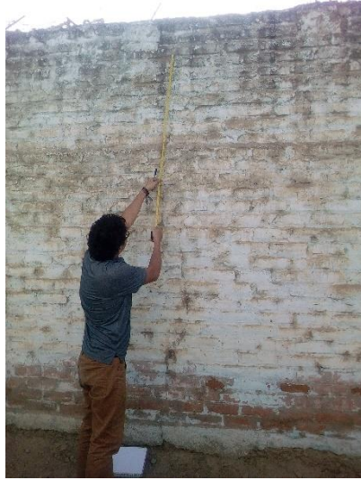
Fotografía 16: Medición de la longitud de las Grietas en Cerco Perimétrico de la Educativa 15029 Santa Teresa de Jesús.
