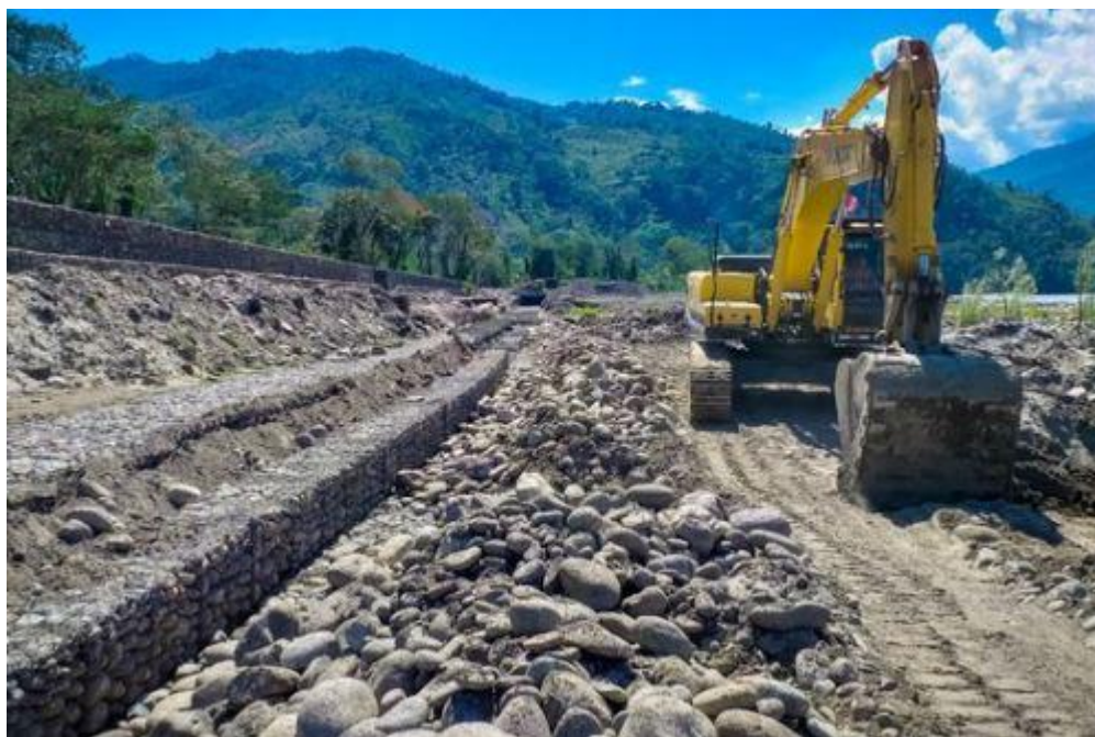
Figura 10: protección de cultivos con muro de gavión
