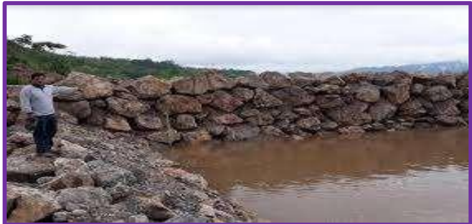
Figura 02. Estabilidad del enrocado.
