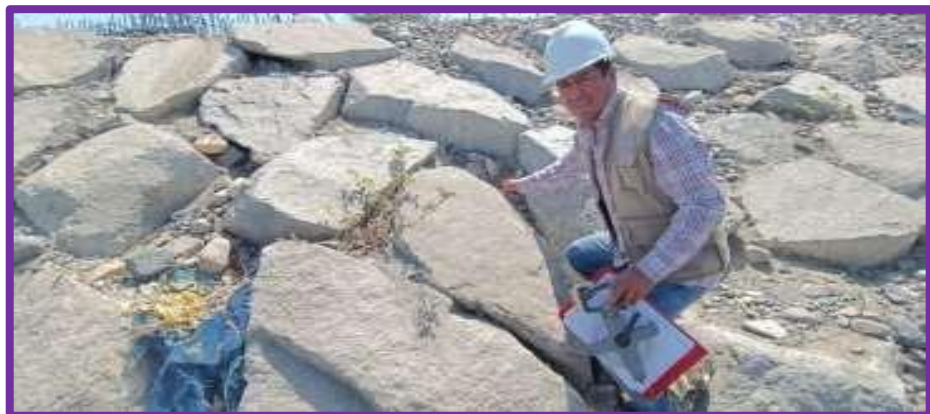
Figura 07. Evaluación de deterioro de juntas.
