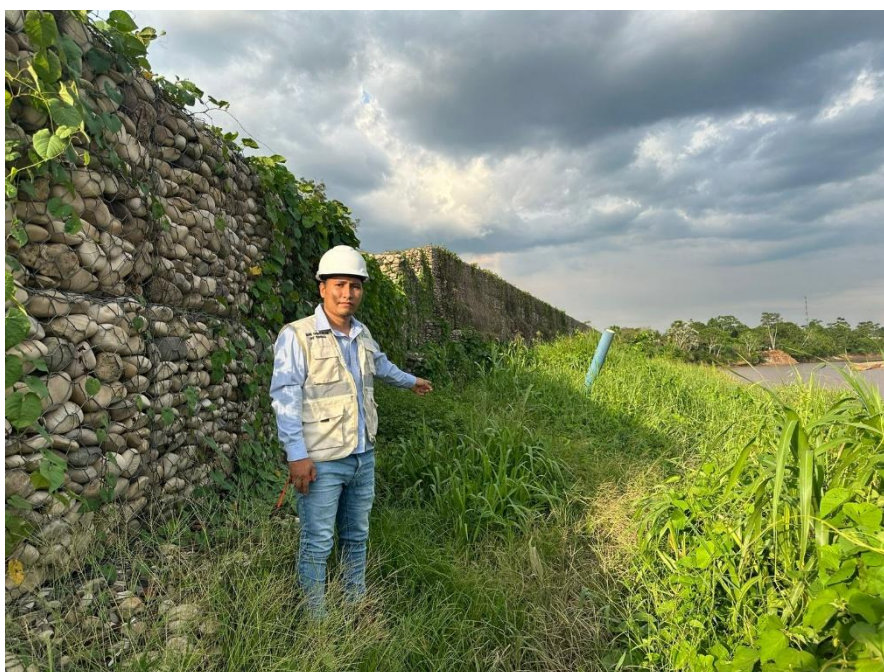
Figura 13: Presencia de vegetación en muro de gaviones parte baja
