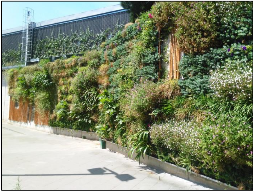
Figura 5: Vegetación densa en muro de gaviones
