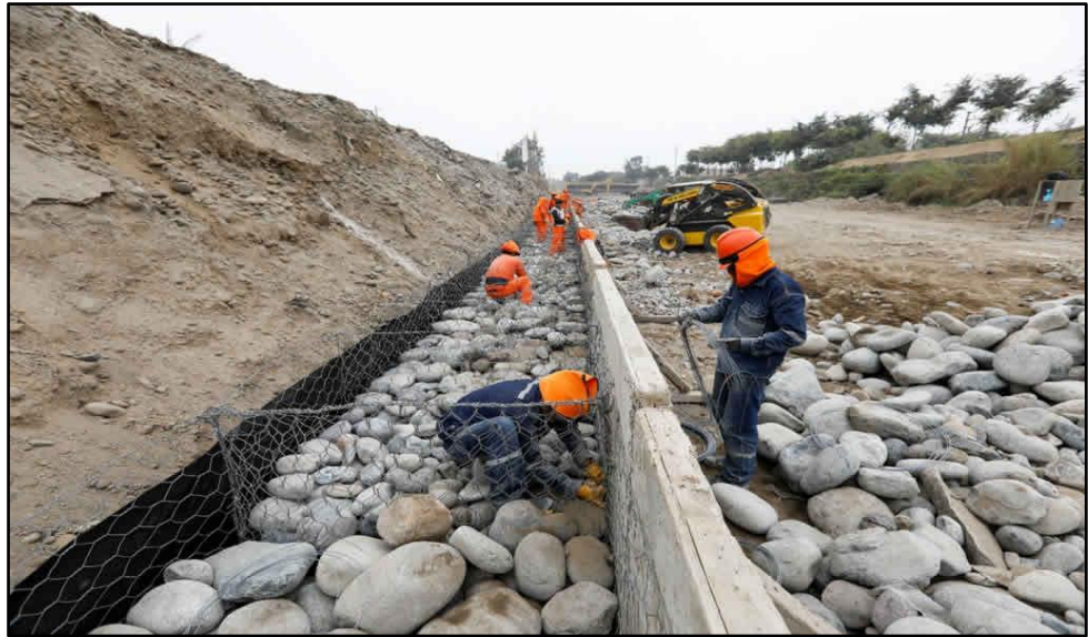
Figura 6: Defensa ribereña Muro de gaviones
