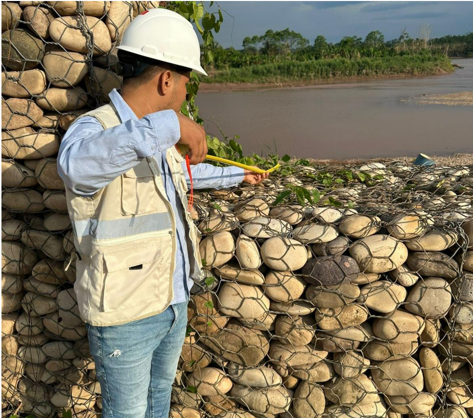
Figura 16: Medición de ancho de gavión en tramo 1+400 a 1+450 Fuente: Evidencia de campo 2025
