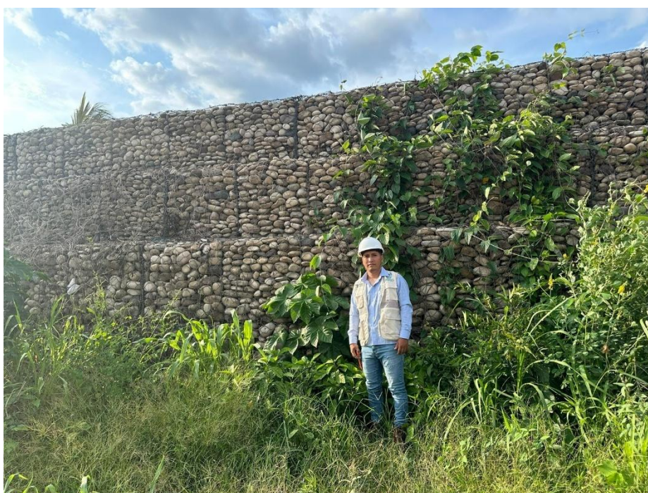
Figura 11: Presencia de vegetación en muro de gaviones
