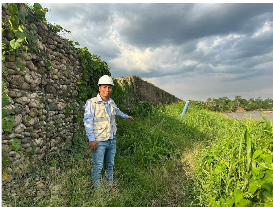
Figura 7: Zona vulnerable en el muro de gaviones
