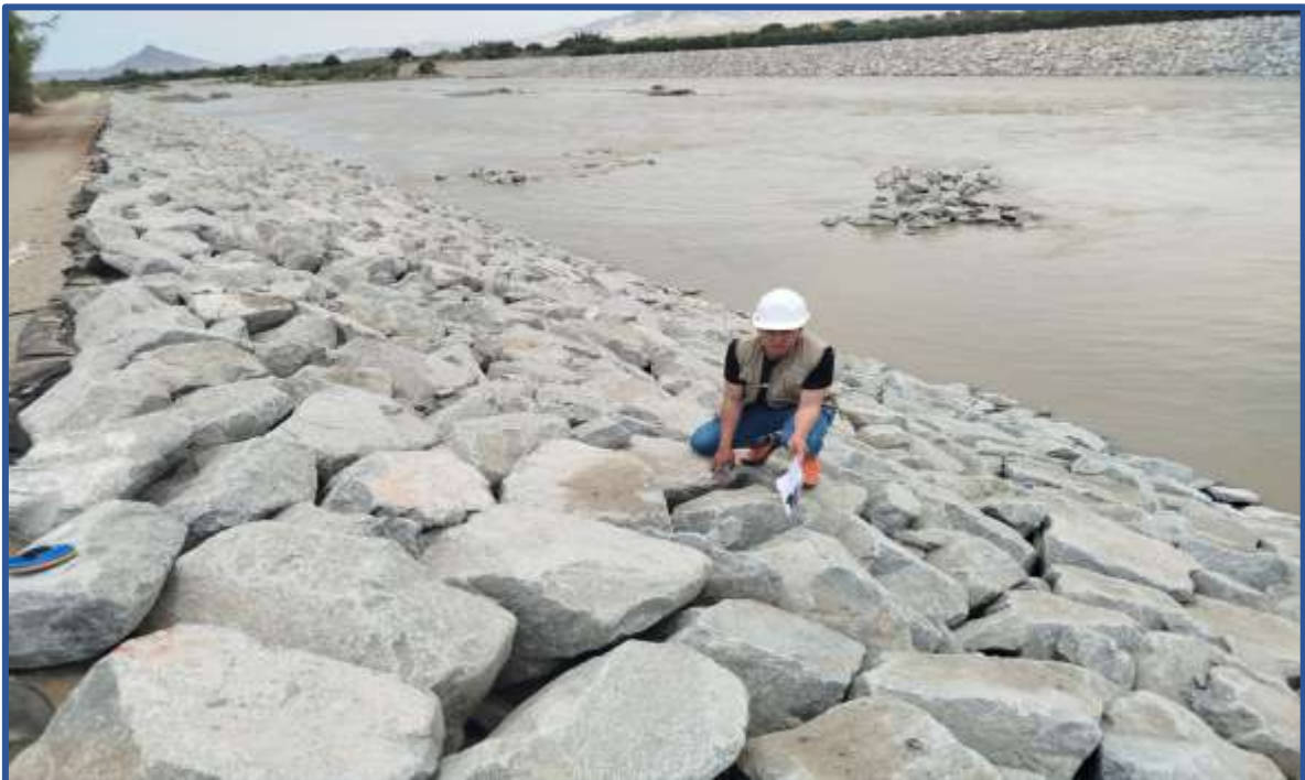
Figura 2: Se evidencian amplios espaciamientos y una deficiente conexión entre las rocas en la progresiva 0+050.
