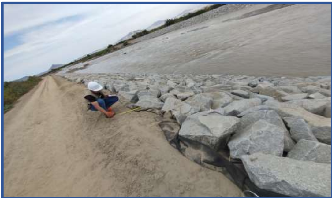
Figura 8: Se muestra la toma de medida de cuanto fue el desplazamiento de la estructura, lo cual sea por socavación de la misma base, estamos situado en la progresiva 0+250.
