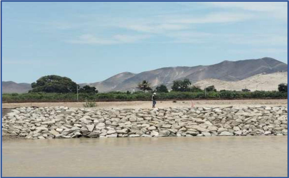
Figura 13: En esta figura se observa que parte de esta a sufrido hundimiento por presentar un talud que, ha sufrido erosión, esta foto fue tomada en la progresiva 0+350.
