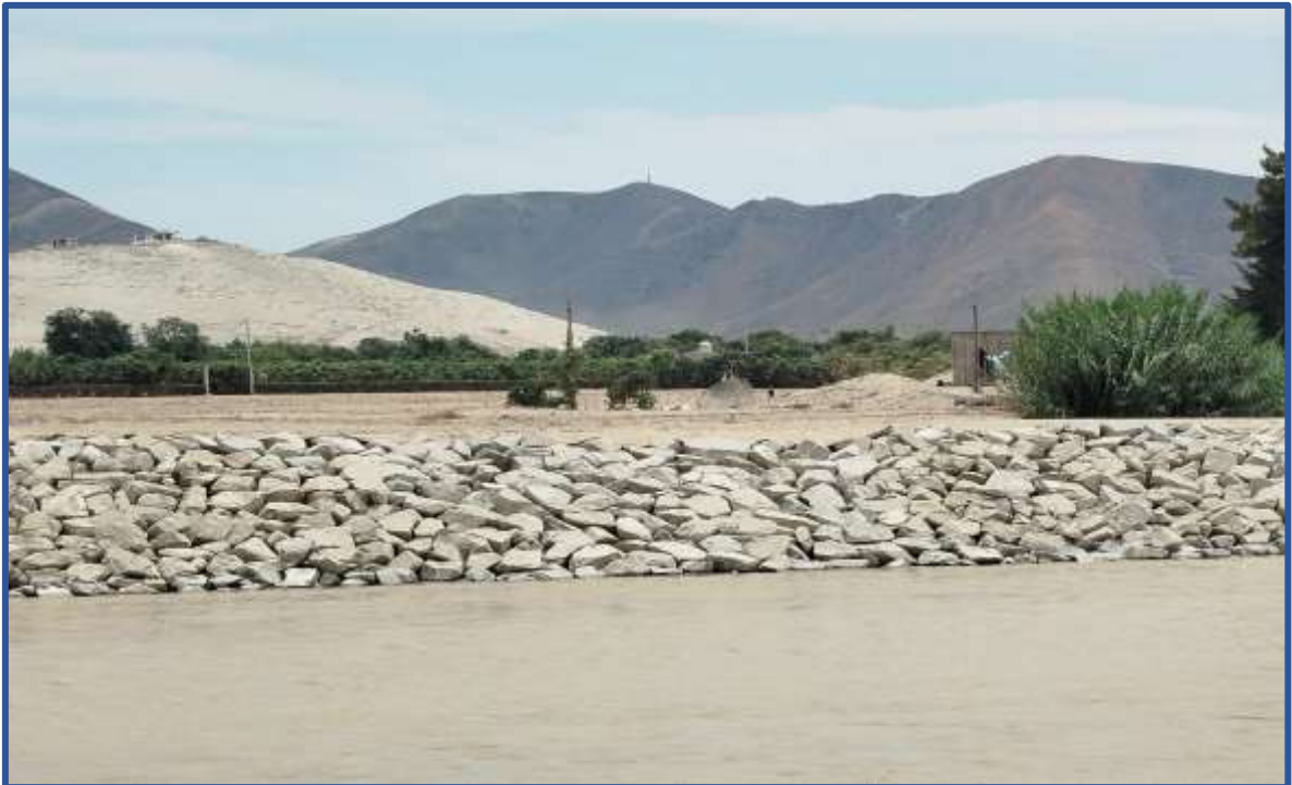
Figura 14: En esta figura se observa que parte de esta a sufrido hundimiento por presentar un talud que, ha sufrido erosión, esta foto fue tomada en la progresiva 0+400.
