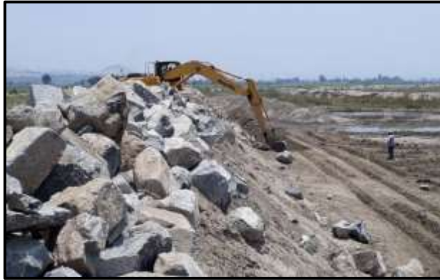
Figura 10: Desplazamiento de rocas en el enrocado
