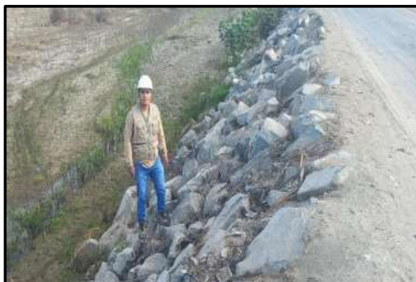
Figura 06: Inestabilidad del enrocado
