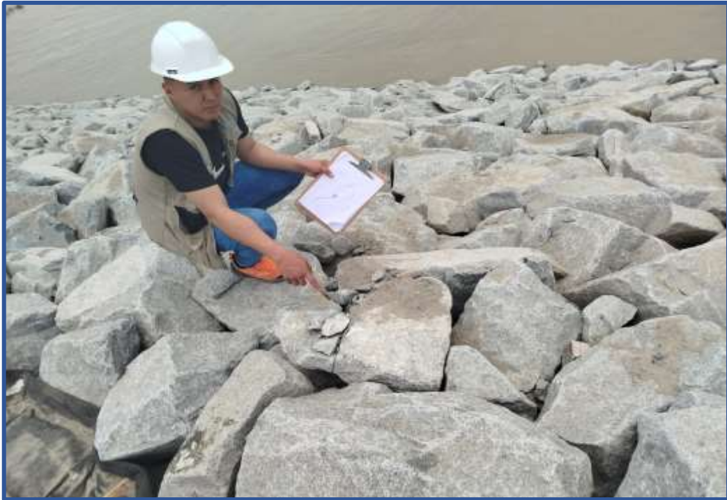
Figura 3: Se observan rocas parcialmente deterioradas que presentan fisuras, muchas de ellas originadas por variaciones climáticas, en la progresiva 0+120.
