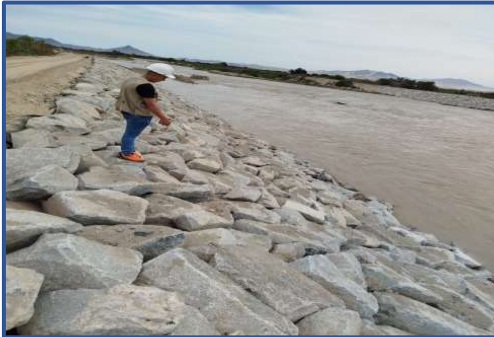
Figura 9: Se muestra la mala conexión que hay roca con roca lo cual genera que la estructura se vuelva inestable, estamos situado en la progresiva 0+260.
