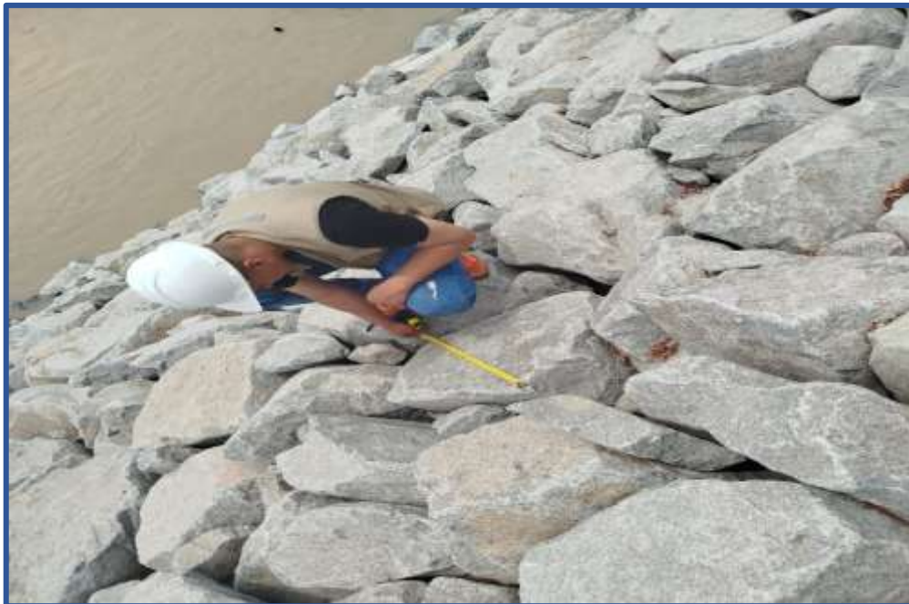
Figura 4: Se muestra realizando la toma de medidas de las rocas, las cuales están entre 0.30 y 0.70 metros, la mayoría de estas no cumplen con las medidas adecuadas, estamos situado en la progresiva 0+150.
