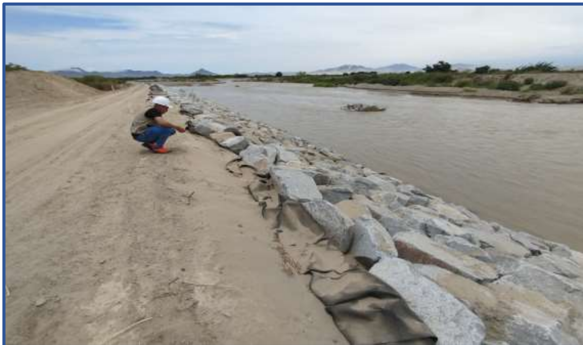
Figura 11: Se muestra que esta parte de la estructura ha sufrido desplazamiento para la parte de abajo, lo cual sea por socavación de la misma base, estamos situado en la progresiva 0+300.
