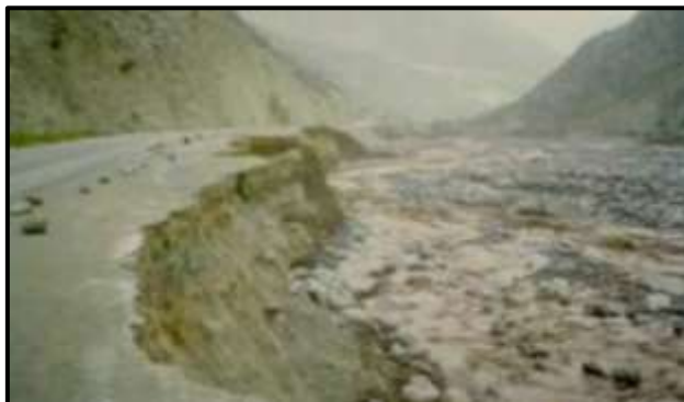
Figura 09: Socavación en la margen de un río.
