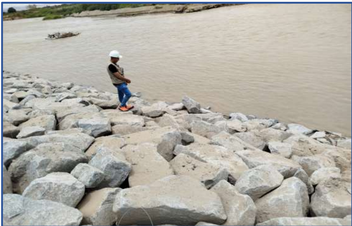
Figura 10: En esta figura observamos que por la mala conexión que hay de roca con roca unas de estas ya ha sufrido volteo, esta foto fue tomada en la progresiva 0+280.
