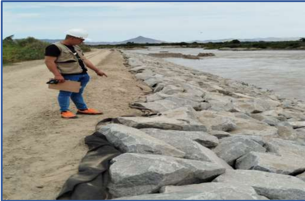
Figura 7: Se muestra que esta parte de la estructura a sufrido desplazamiento para la parte de abajo, lo cual sea por socavación de la misma base, estamos situado en la progresiva 0+230.
