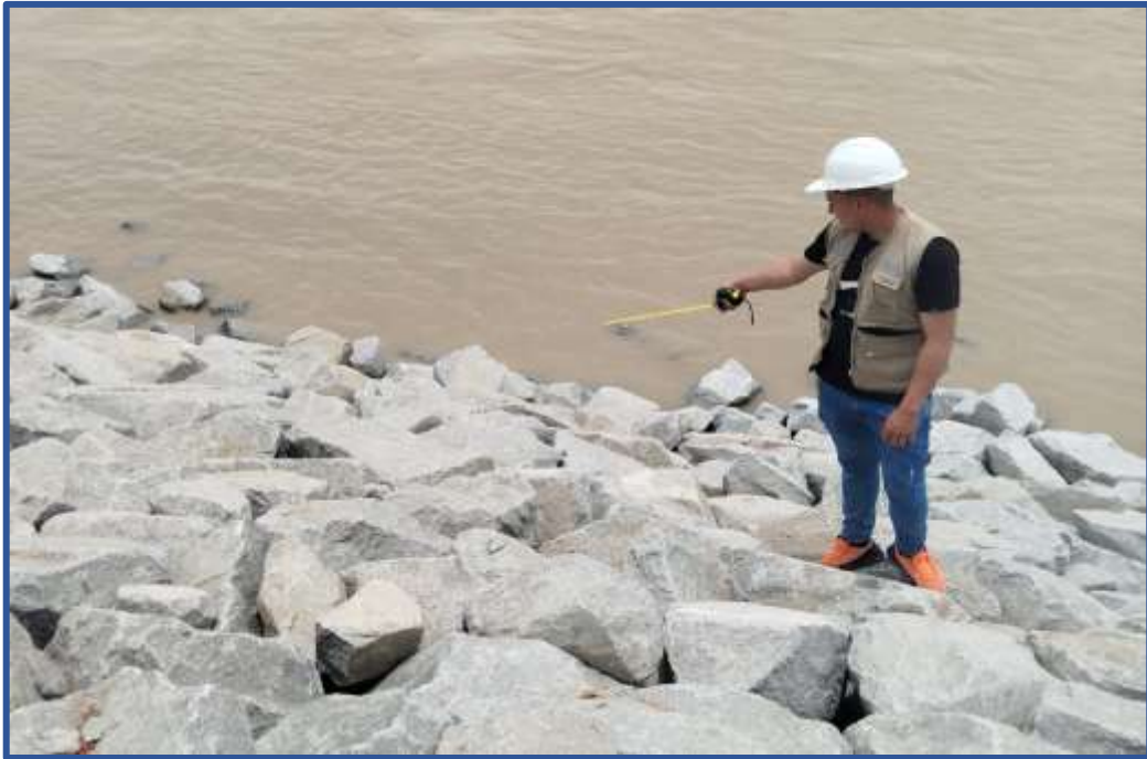
Figura 5: Se observan rocas que han experimentado volteo, ubicadas en la base de la estructura, en la progresiva 0+180.
