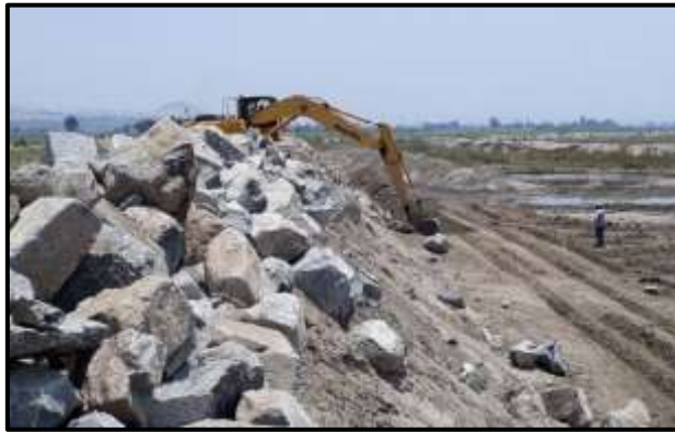
Figura 10: Desplazamiento de rocas en el enrocado
