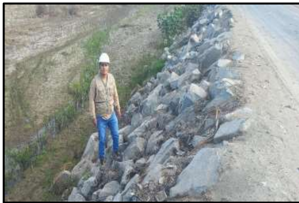
Figura 06: Inestabilidad del enrocado
