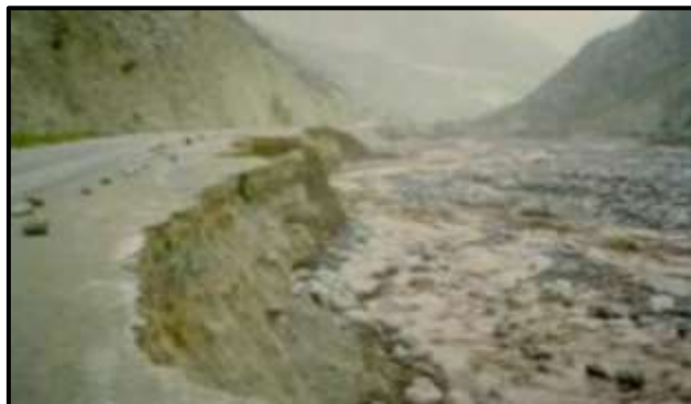
Figura 09: Socavación en la margen de un río.
