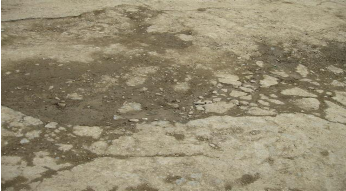
Grafico 19: Jr. San Martin Cuadra 3; Fisura Tipo Hundimiento y Tipo Malla.
