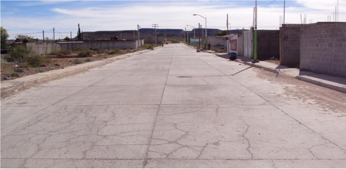
Gráfico 1: Fisuración Tipo malla
