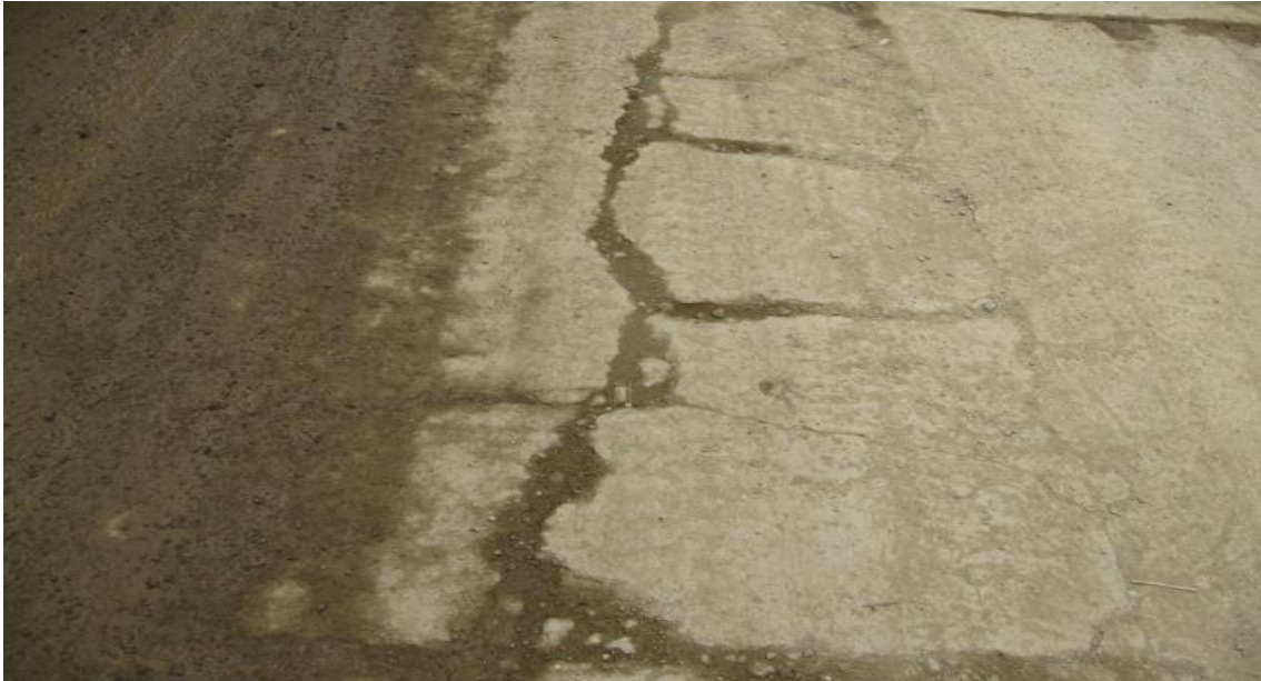
Grafico 17: – Jr. San Martin Cuadra 1; Fisura Transversales y Longitudinales
