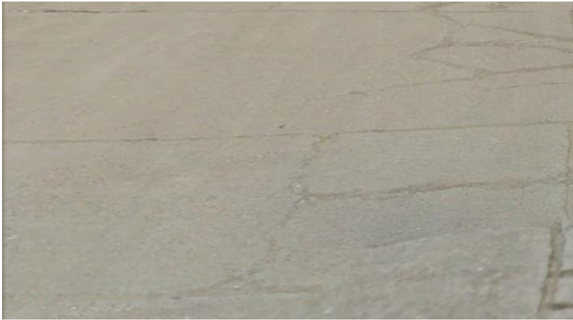
Grafico 23: Calle 22 de Agosto Cuadra 6; Fisuras Transversales y Longitudinales.
