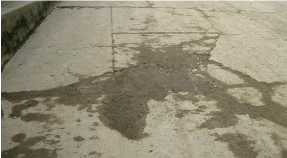
Grafico 24: Jr. Francisco Ocaña Cuadra 2; Fisuras por Hundimiento.
