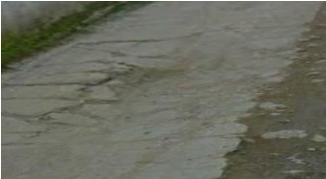
Grafico 26: Ruta de penetración 2A Piura – Huancabamba; Fisura Por Hundimiento.
