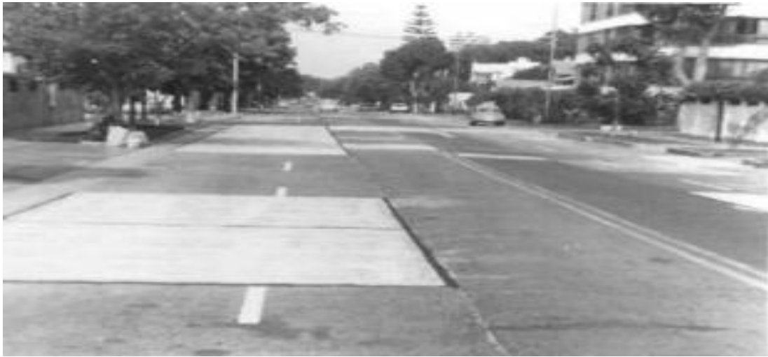
Grafico 3: Deterioros en pavimentos flexibles y rígidos
