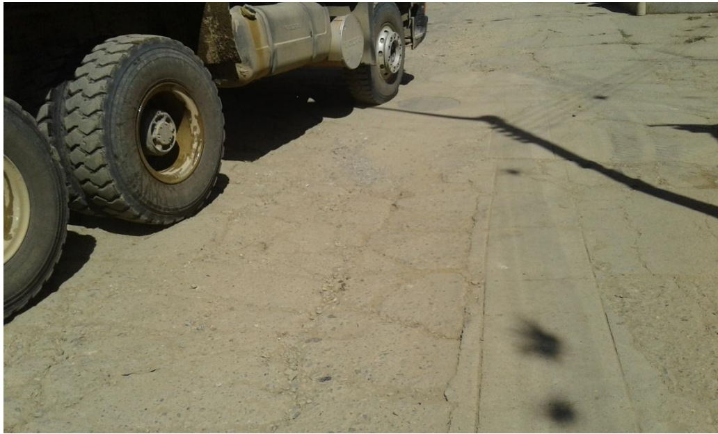
Grafico 21: Calle 22 de Agosto Cuadra 4, Fisura por Hundimiento
