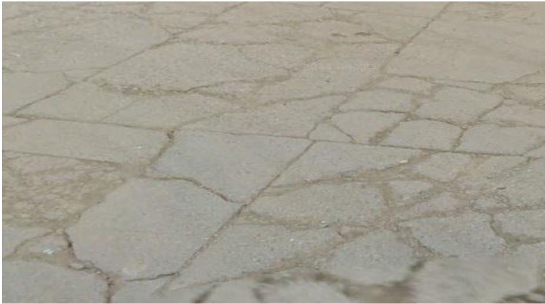
Grafico 25: Ruta de penetración 2A Piura – Huancabamba; Fisuras Tipo Malla.
