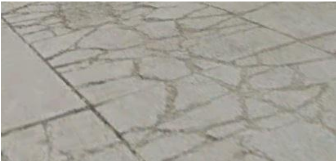
Grafico 18: Jr. San Martin Cuadra 2; Fisura Tipo Malla.
