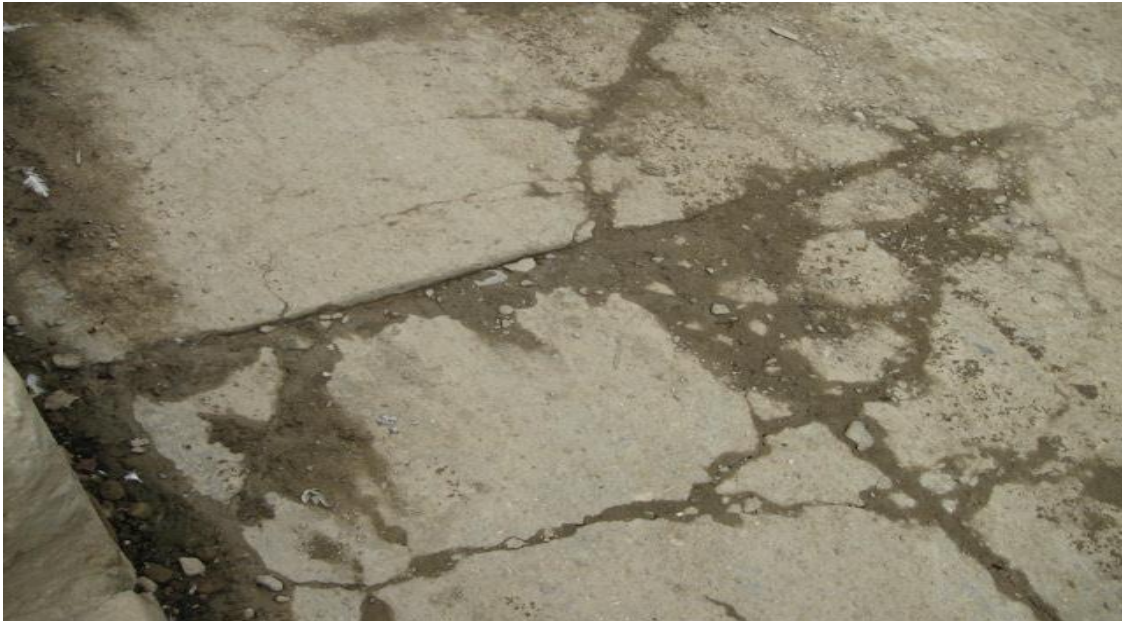
Grafico 22: Calle 22 de Agosto Cuadra 4, Fisura de Esquina
