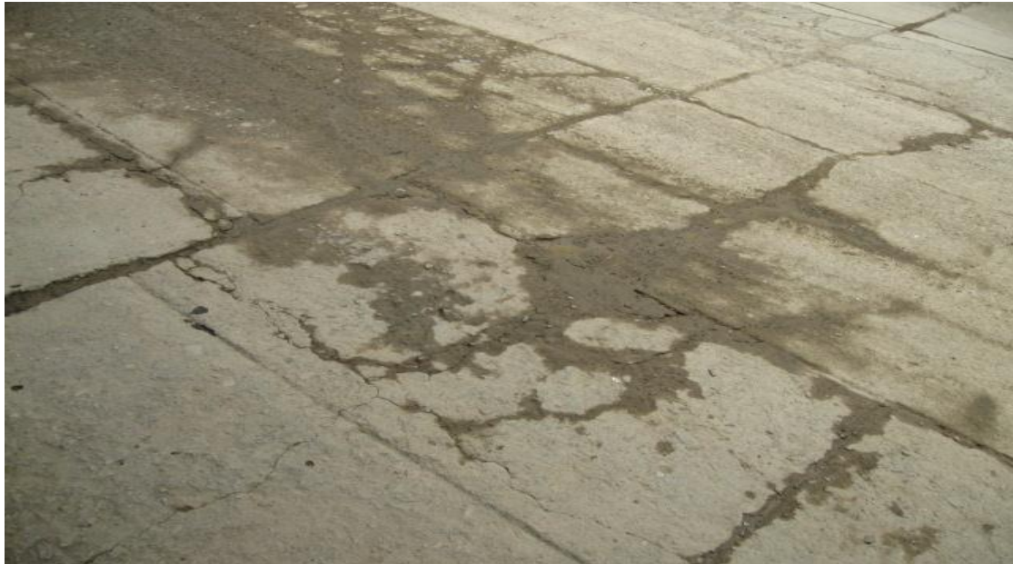
Grafico 20: Jr. Chiclayo; Fisura transversal y Fisura Malla.
