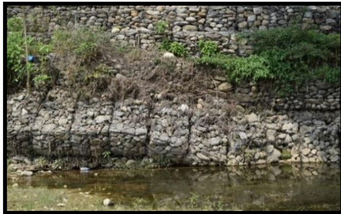
Figura 15. Socavación en muro de gaviones.
