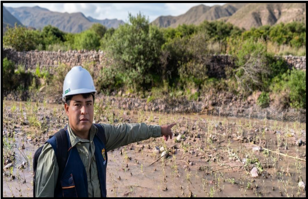
Fotografía 08: Excesiva acumulación de sedimentos en la parte central del cauce.
