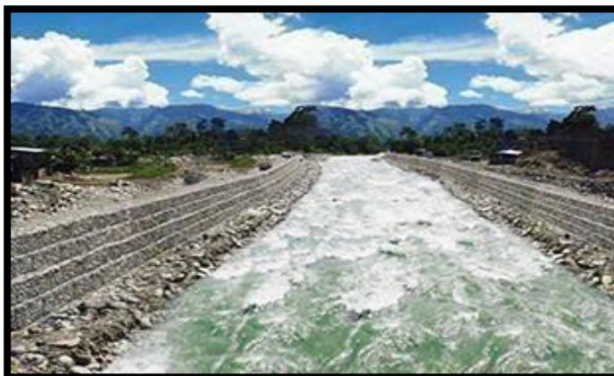
Figura 1. Defensa ribereña con gaviones.
