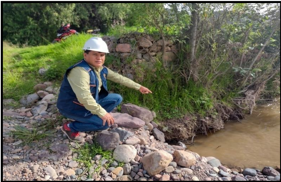
Fotografía 02: Socavación al inicio de la progresiva 0+000, con erosión lateral y deficiente contención.
