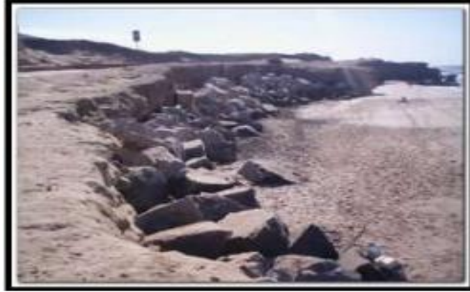
Figura 16. Erosión en defensa ribereña.
