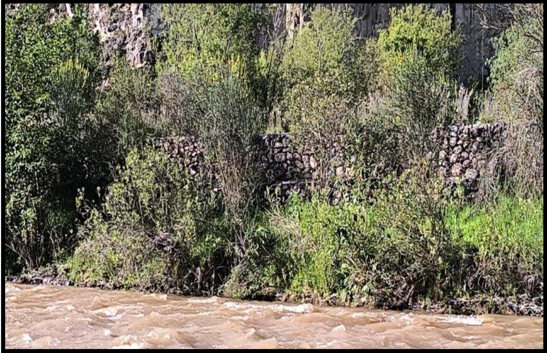
Fotografía 07: Se aprecia vegetación silvestre acumulada al pie del muro de gaviones.
