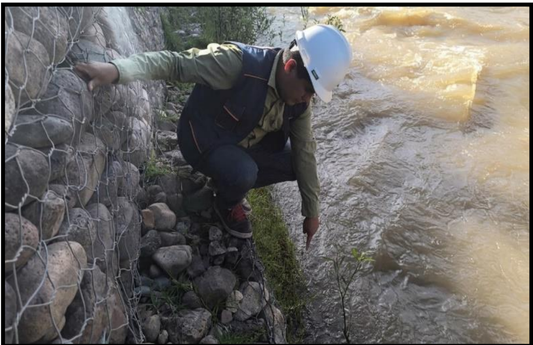
Fotografía 04: Inspección de socavación al pie del muro de gavión.
