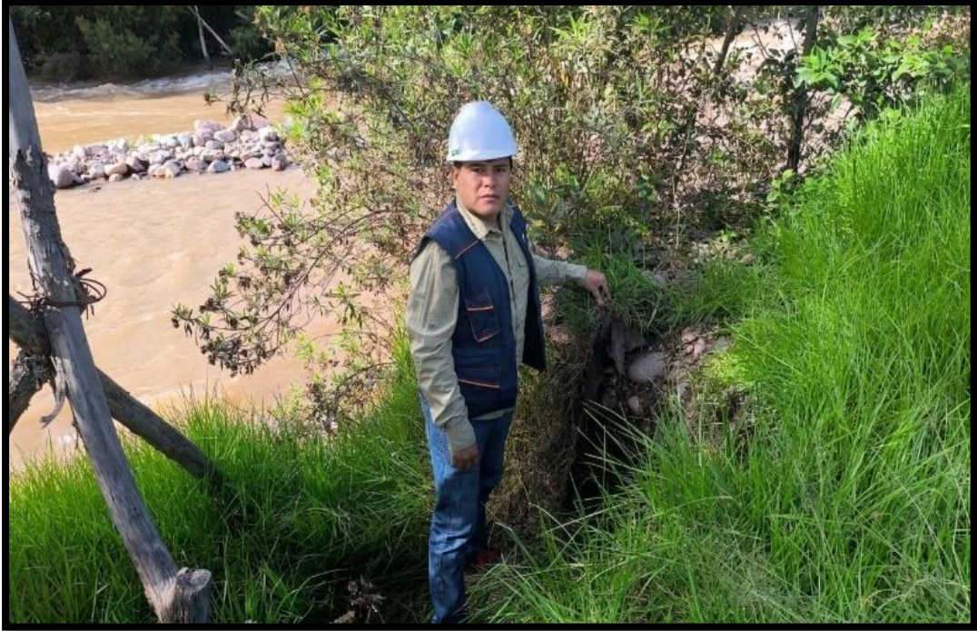
Fotografía 03: Falla por corte en muro de gavión y geomembrana deteriorada.
