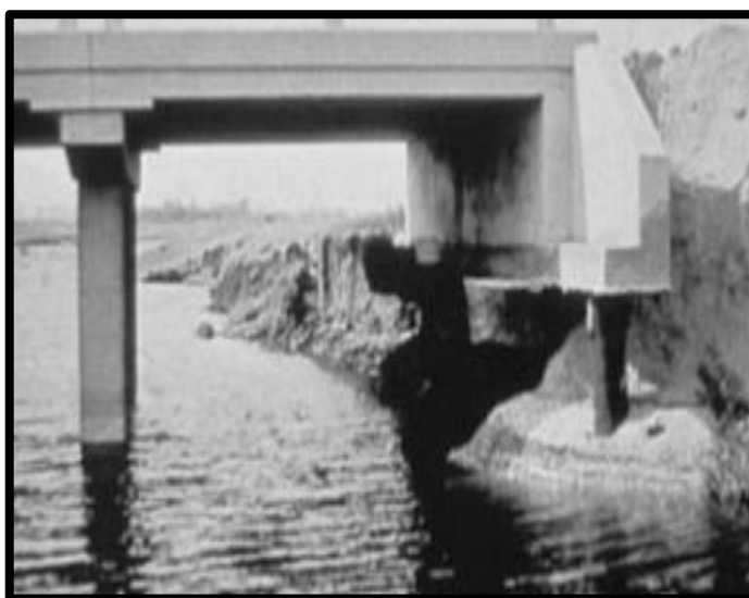
Figura 08: Socavación de pilar.
