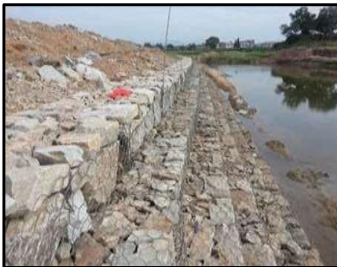
Figura 12: Integridad del enrocado.
