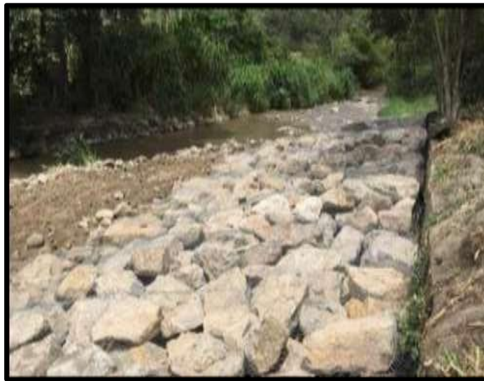
Figura 11: Desgaste del enrocado.
