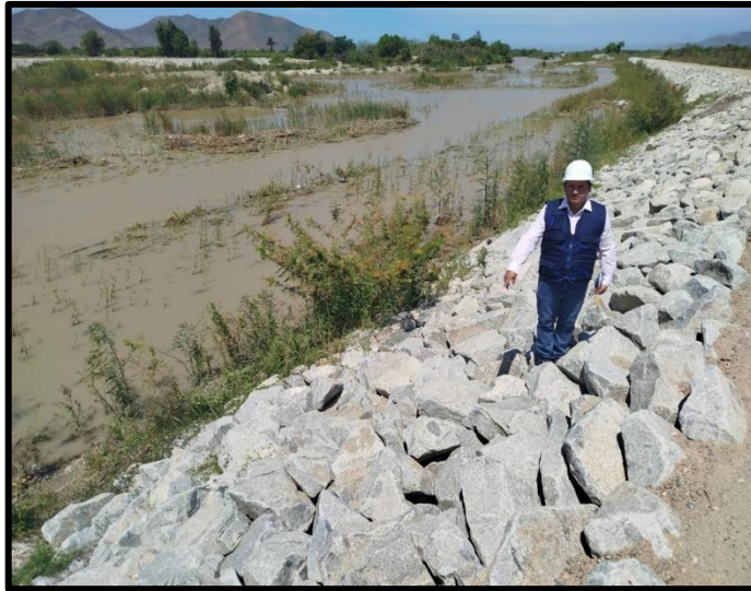
Figura 09: Mala conexión de rocas
