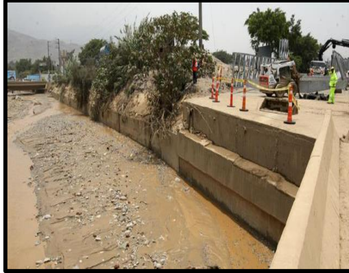
Figura 17: Muro de contención en el Río Huaycoloro.
