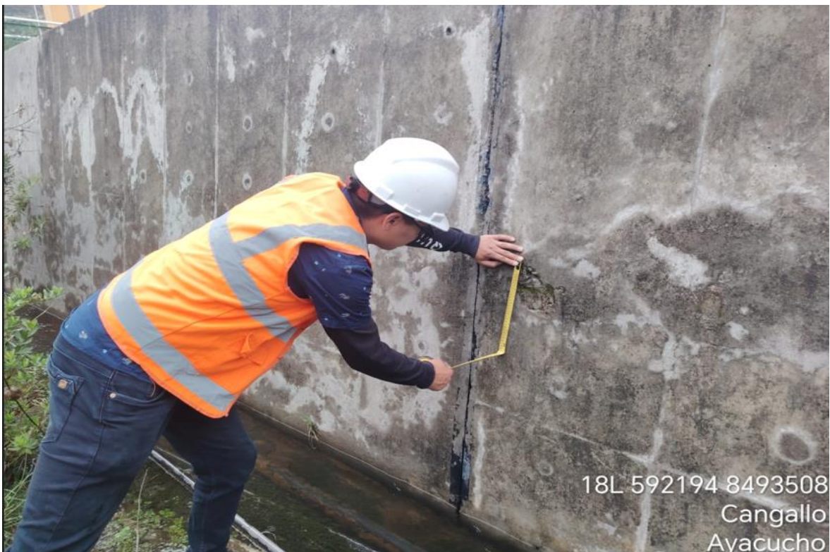
EVIDENCIA 10: Se evidencia la presencia de fisuras de tipo profunda.
