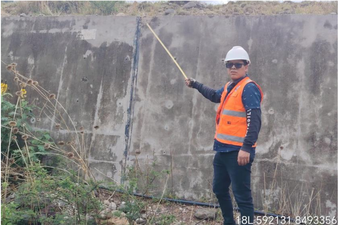
EVIDENCIA 05: Se observa la presencia de fisuras superficiales con una longitud aproximada de 0.30 cm.
