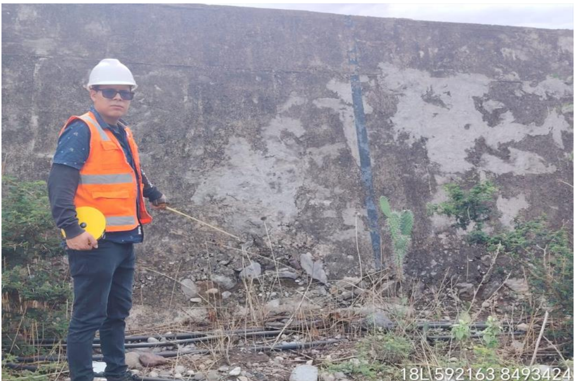
EVIDENCIA 08: Se evidencia la presencia de fisuras de tipo profunda.
