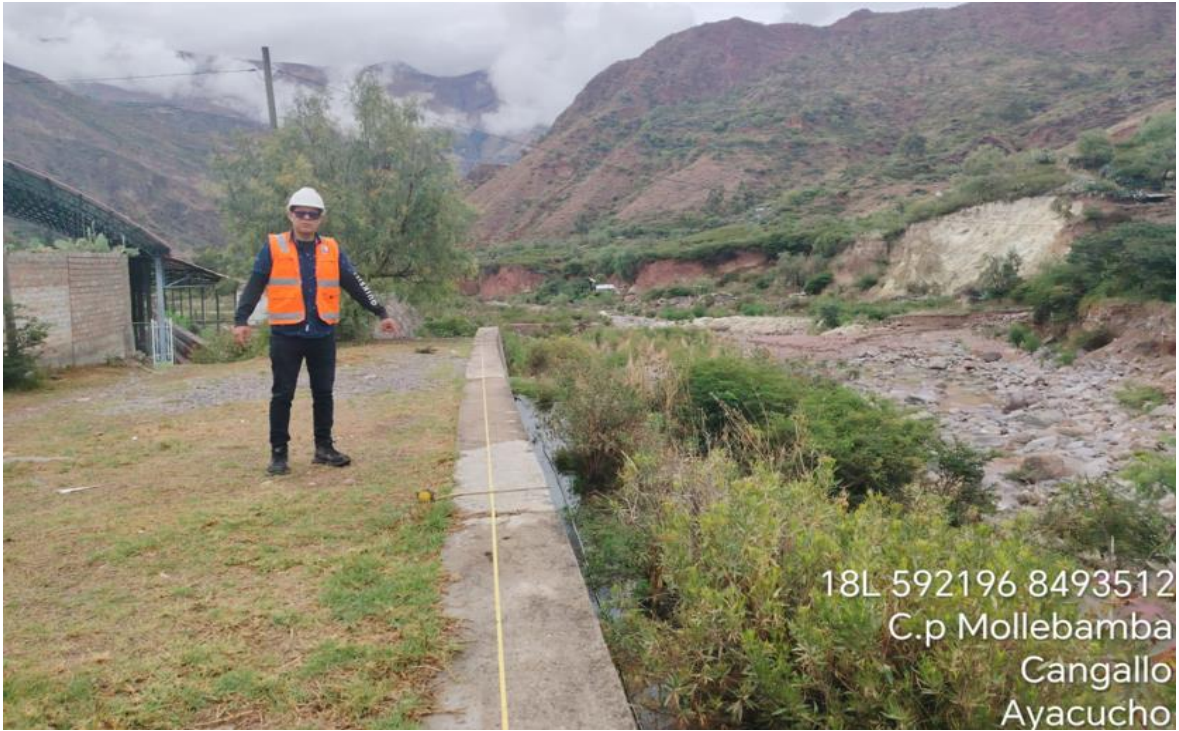
EVIDENCIA 03: Se observa que el muro de contención presenta una condición estructural regular.
