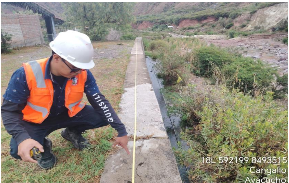
EVIDENCIA 02: Se visualiza fisura en el muro de contención.
