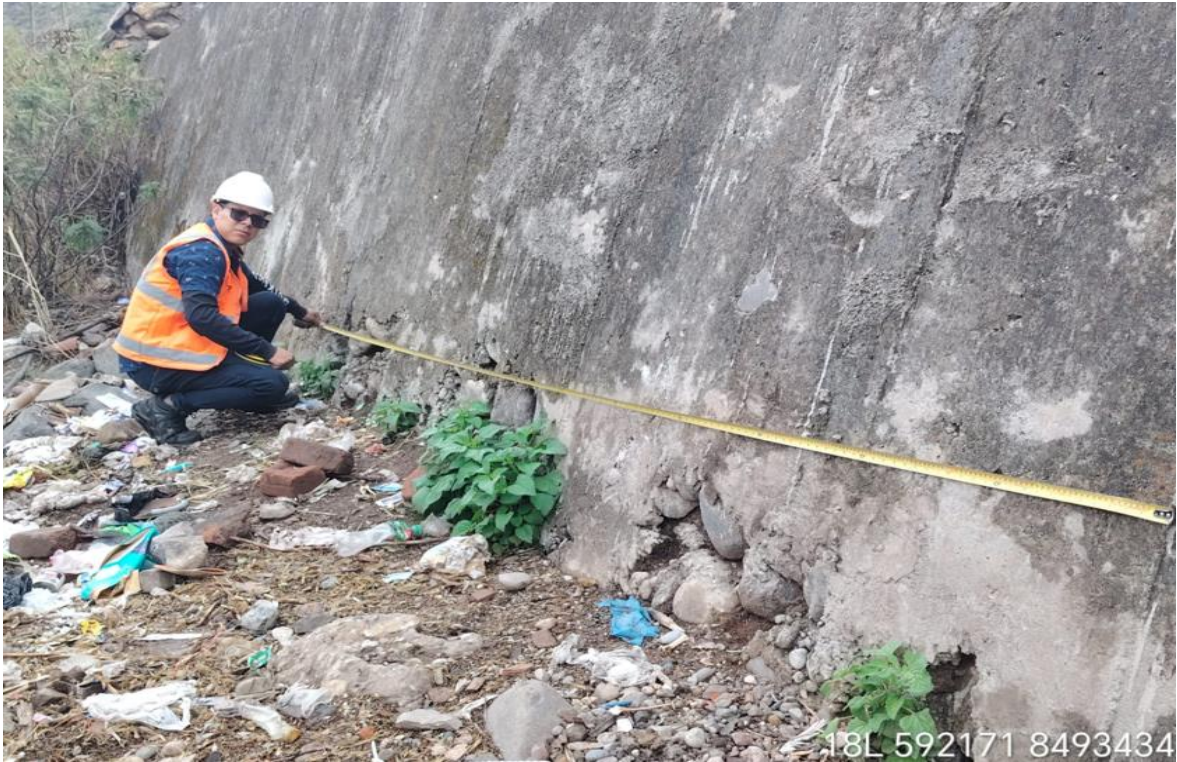
EVIDENCIA 09: Se evidencia la presencia de fisuras de tipo profunda
