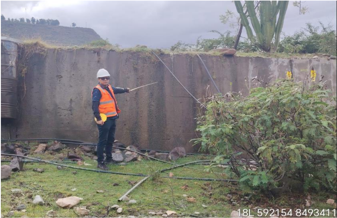
EVIDENCIA 11: Se visualiza presencia de escurrimiento de agua y tuberías.
