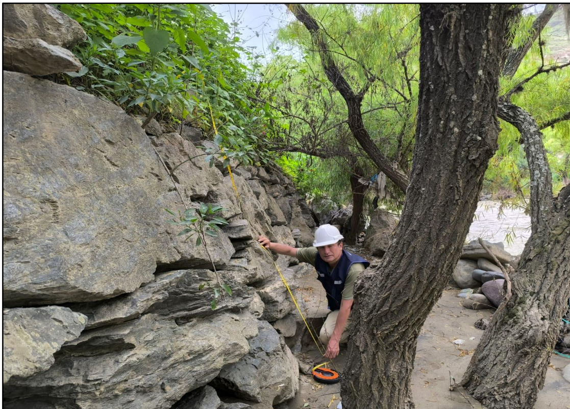
Fotografía 10: Zona 4, Socavación de la cimentación en 6 m de enrocado. Fecha: 24/03/2016. Fuente: Propia.
