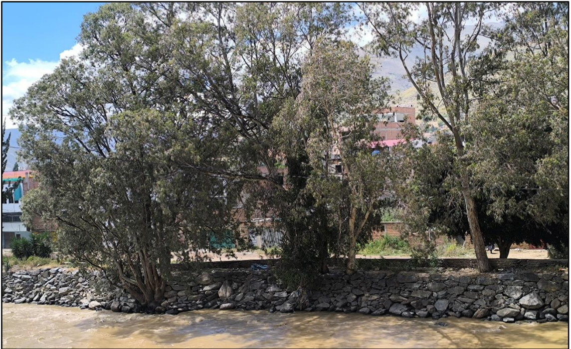
Fotografía 01: Zona 1, vegetación invasiva incrustado en el enrocado.
