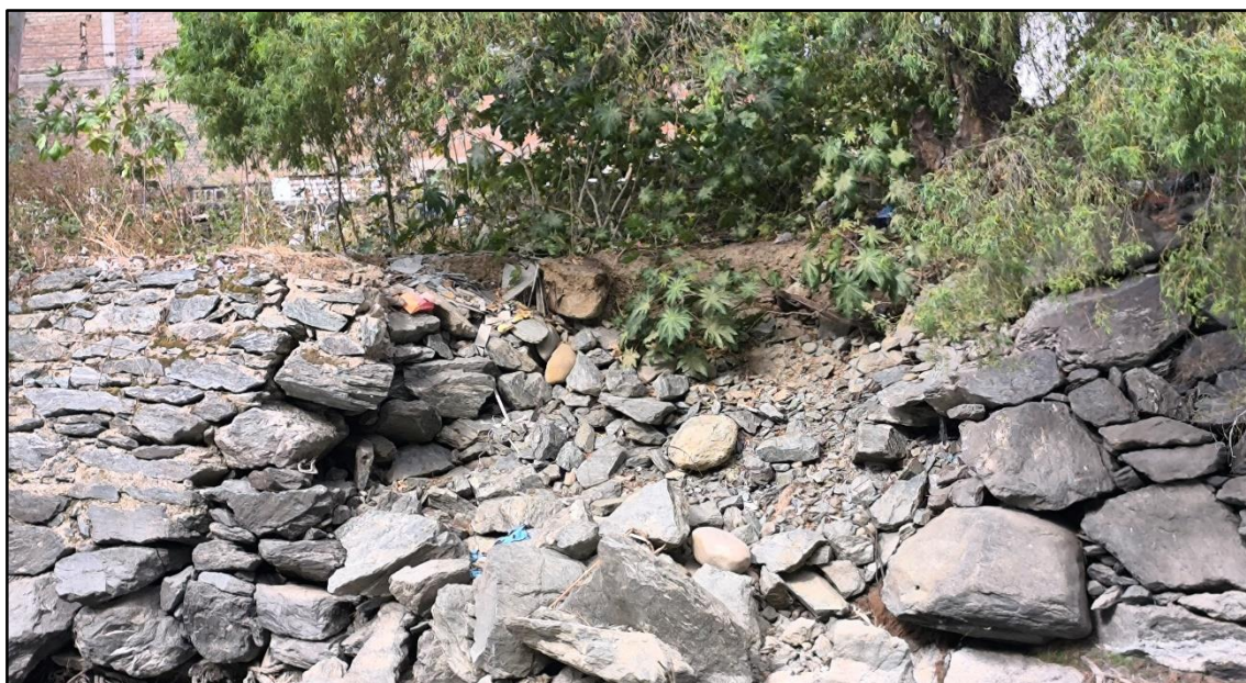
Fotografía 06: Zona 3, deslizamiento total de rocas en 9 m de enrocado. Fecha: 23/03/2016. Fuente: Propia.
