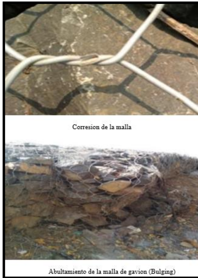
Figura N° 16: Tipo de daños Fuente: Fallas de muros de gaviones(41)
