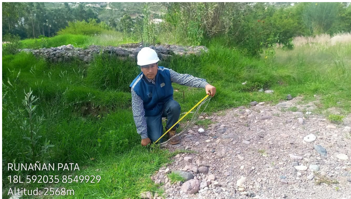
Foto 1: En la progresiva 0+000 al 0+050 se observa 5 metros de derrumbe de muro de gaviones
