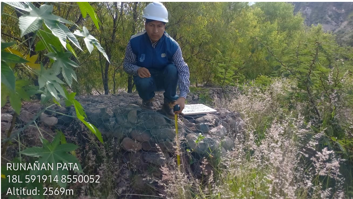
Foto 8: Se aprecia regular hundimiento de muro de gaviones.
