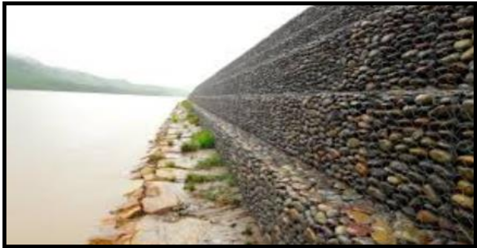
Figura N° 1: Defensa ribereña Fuente: Bella vista Maccaferri (13)
