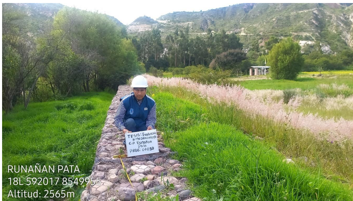
Foto 2: En la progresiva + 050 se visualiza regular desgaste de la malla de doble torsión de forma hexagonal.
