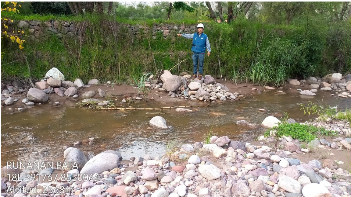
Foto 6: Se observa acumulación de sedimentos en la parte de base del muro de gavión.
