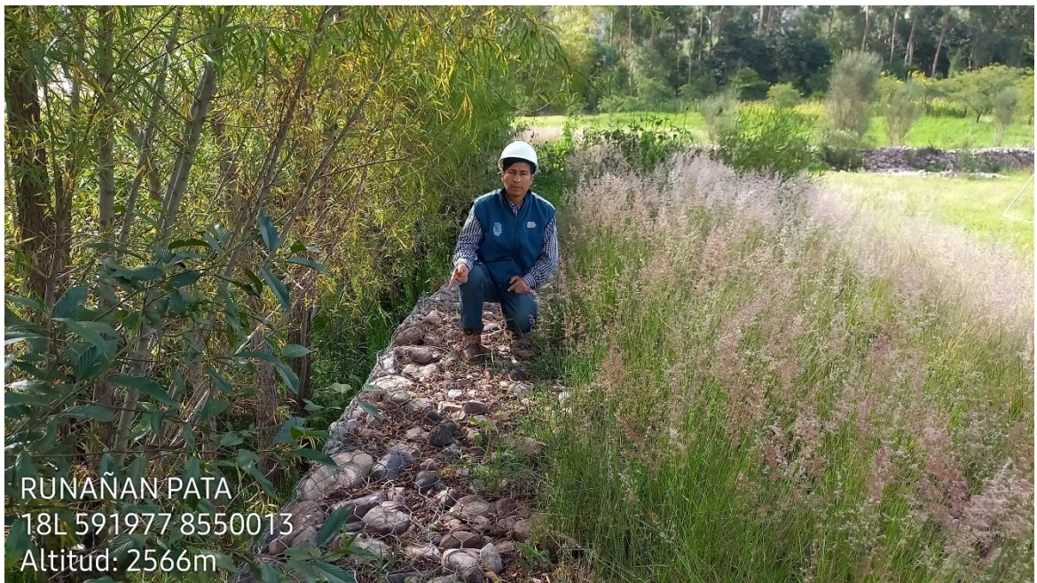
Foto 4: Se visualiza el crecimiento excesivo de vegetación junto a los muros de gaviones.
