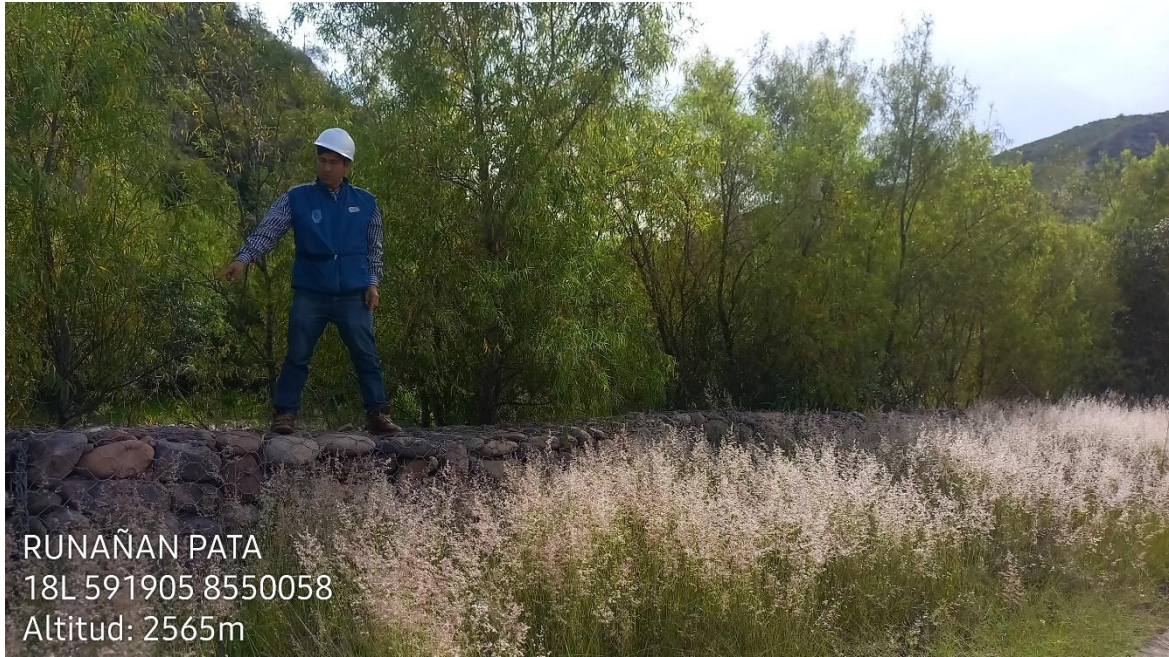
Foto 3: Se puede ver regulares hundimientos de los muros de gaviones
