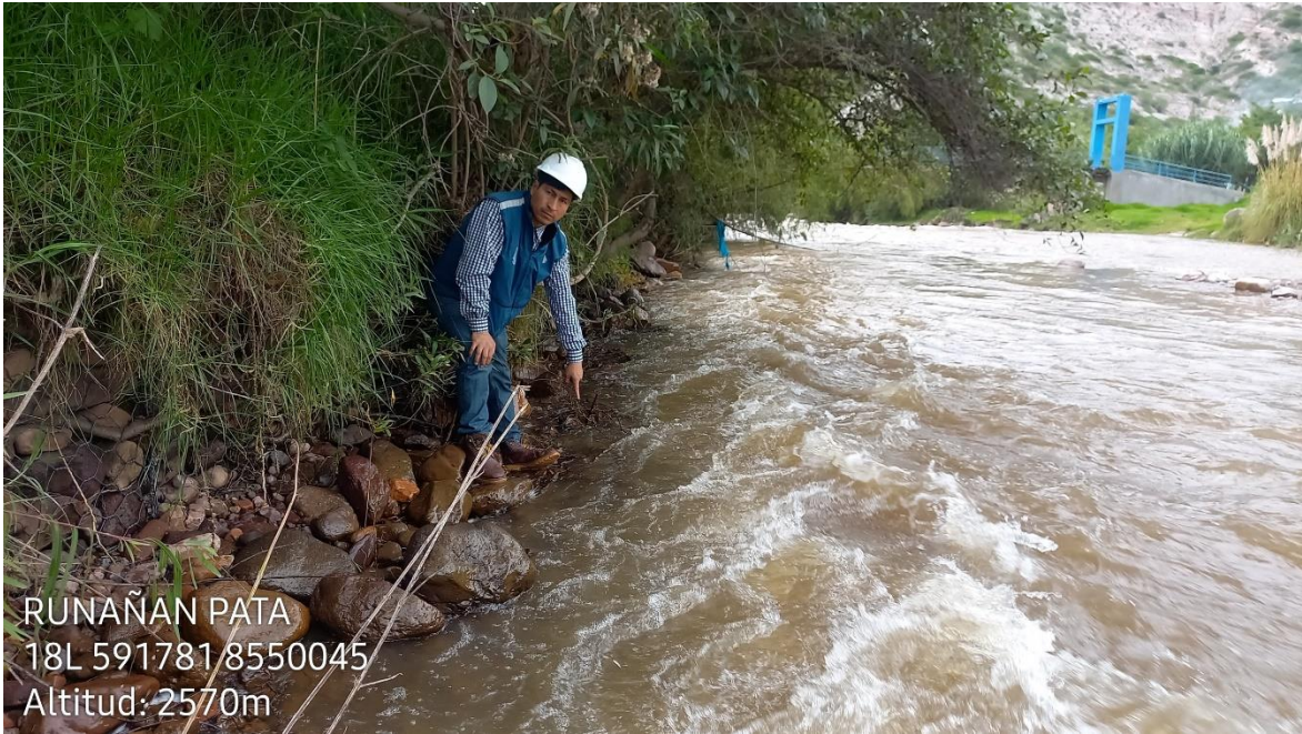
Foto 9: En la progresiva 0+250 se observa regular socavación de la base del muro de gavión.
