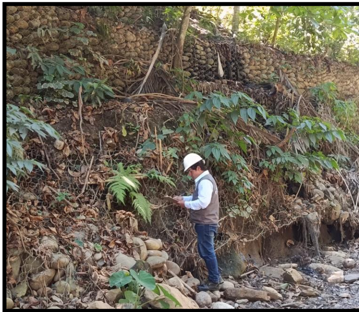
Fotografía 34 Se puede observar que al estar ejerciendo demasiada presión al estar doblada la base del muro de gaviones no soporto más y se produjo su rotura de las cuales se evidencia la pérdida de material de relleno. Fecha de la fotografía: 04 de septiembre del 2025
