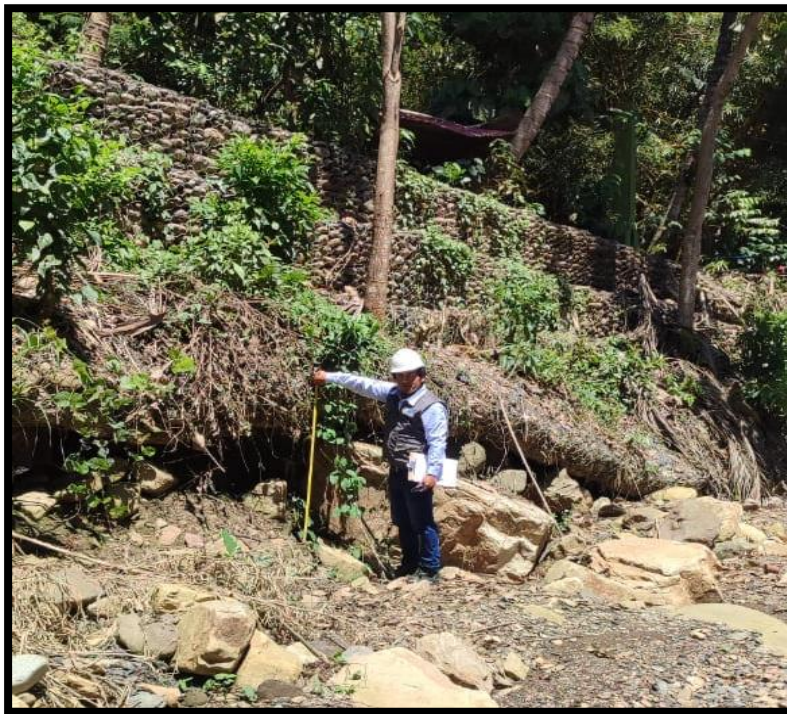
Fotografía 38 Se observa la medición de la profundidad de la socavación la cual produce que el gavión tipo colchón se doble gradualmente.
