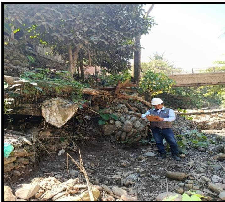
Fotografía 35 En el tramo final comprendido entre las progresivas 0+350 y 0+400, se encontró acumulación de escombros de árboles y otros materiales, los cuales generan una carga adicional sobre el muro de gaviones. Fecha de la fotografía: 04 de septiembre del 2025
