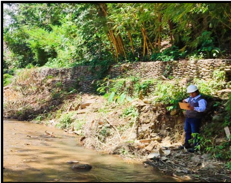
Fotografía 39 Final de la progresiva 0+400 a 0+450, se encontró que esta en mejores condiciones que los tramos iniciales.
