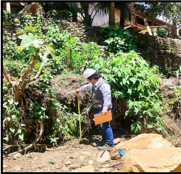
Fotografía 30 Se realiza la medición de profundidad de la socavación a en la base del muro de gavión que es un gavión de tipo colchón, exponiendo a que se rompa y desestabilice todo el muro.
