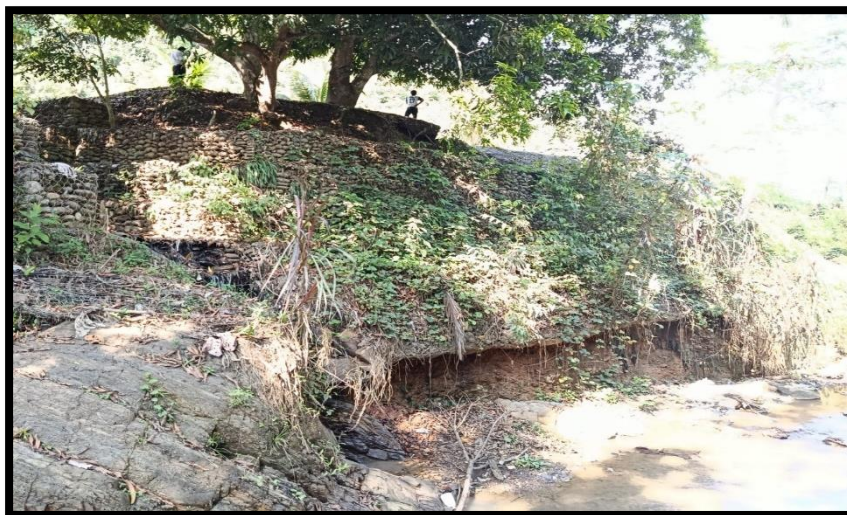
Fotografía 02 Vista general del muro de gaviones donde se encontró presencia de socavación de aproximadamente 1.20 metros de profundidad a partir de la base del muro de gavión y rotura de la malla al inicio del tramo.
