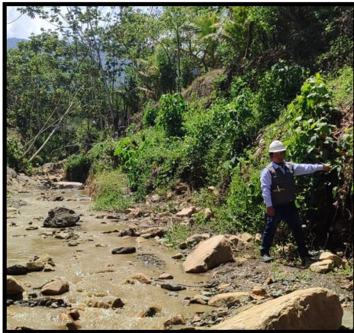
Fotografía 18 Se aprecia el final del tramo verificándose que hay presencia de socavación comprometiendo la estabilidad del muro de gaviones.
