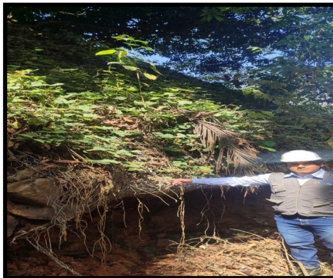
Fotografía 01 En esta imagen se aprecia el inicio de la progresiva 0+000 a 0+050, en la margen izquierda del centro poblado de Ubiato donde se visualiza la presencia de rotura y socavación.
