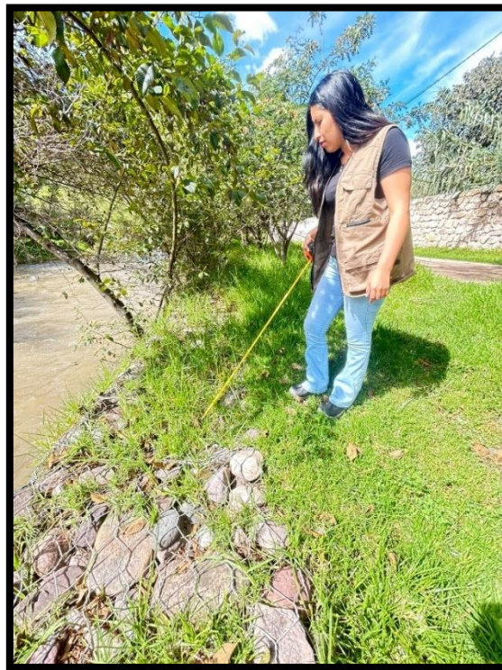
Figura 50. Presencia de vegetación en el muro de gavión
