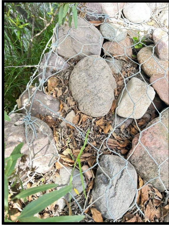
Figura 31. Rotura de malla en el muro de gavión progresiva 9+100 a 9+200
