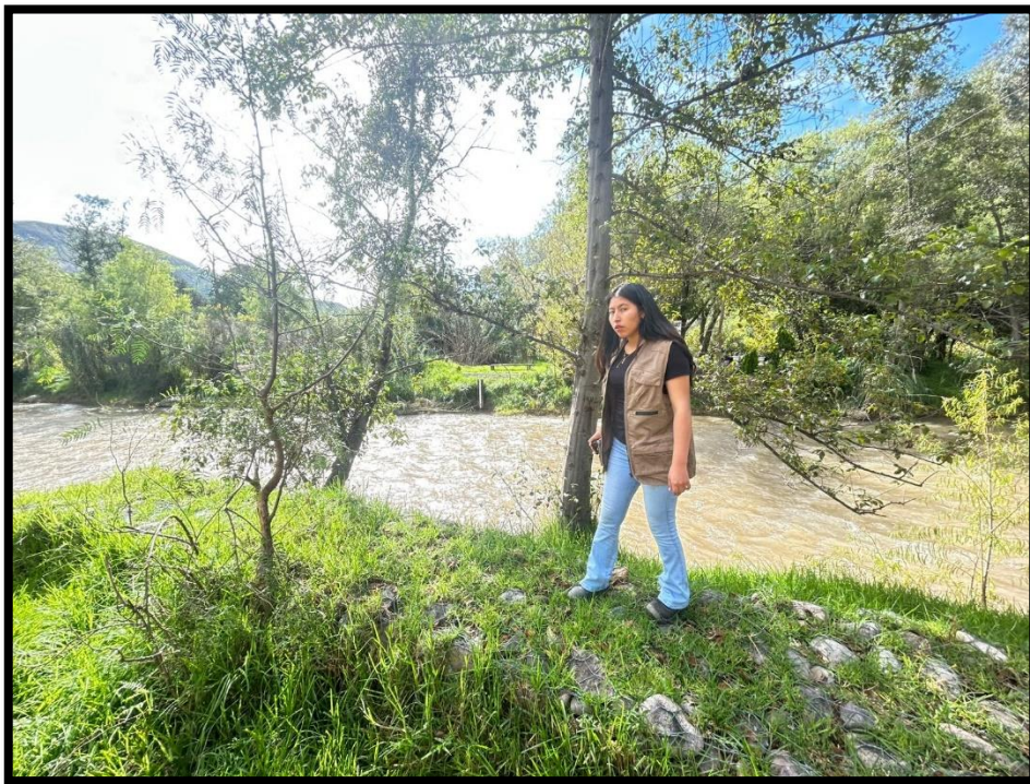
Figura 48. Falta de mantenimiento al muro de gavión
