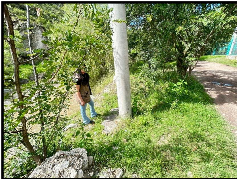
Figura 36. Evidencia de la existencia de un poste de concreto
