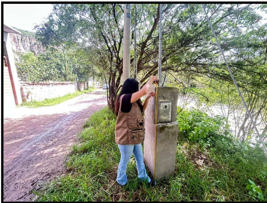
Figura 43. Existencia de medidores de energía cerca al muro de gavión
