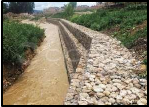
Figura 6: Gaviones tipo muros de contención en defensa ribereña
