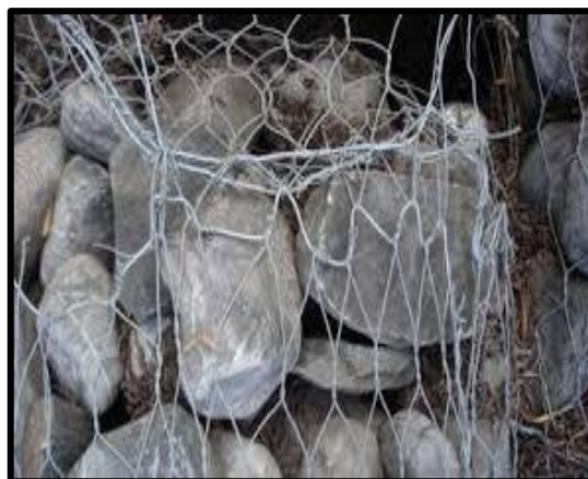
Figura 17: Rotura de malla
