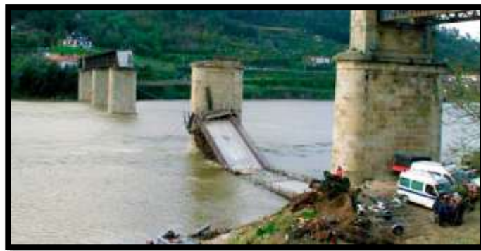
Figura 06: Estructura afectada por socavación
