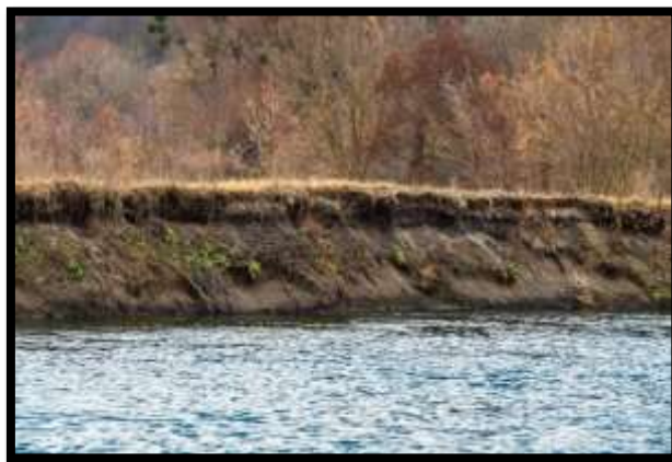
Figura 05: Erosión de talud
