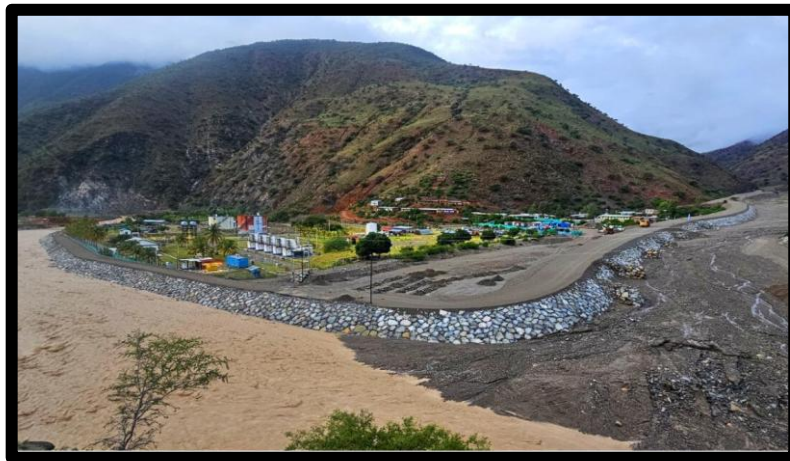
Figura N° 03. Defensa ribereña (enrocado) Fuente: Petroperú (2024)
