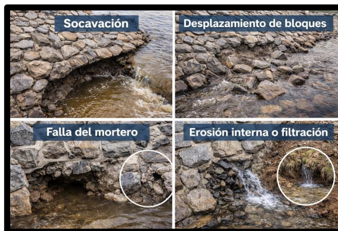
Figura N° 05. Fallos comunes en defensas de taludes.
