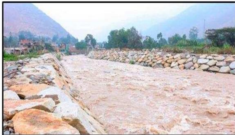
Figura N° 06: Enrocado Defensa Ribereña
