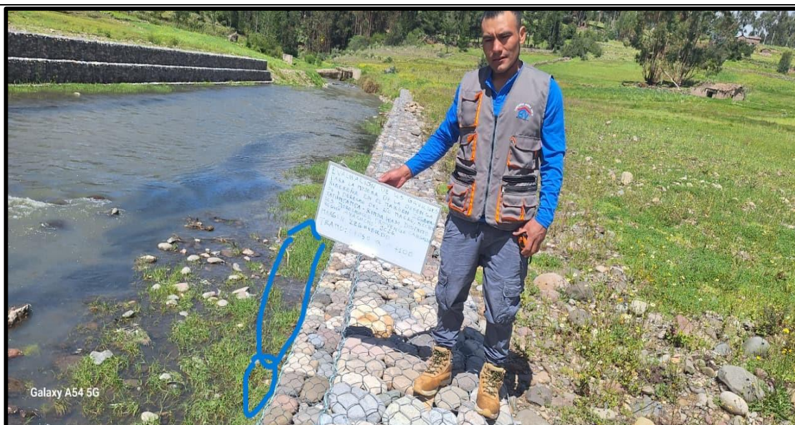
Figura A. 24: Evaluación de gaviones en margen izquierdo donde se observa acumulación de materiales de desmonte esto más adelante va tener consecuencia como rotura de malla. Fuente: Propia 2026
