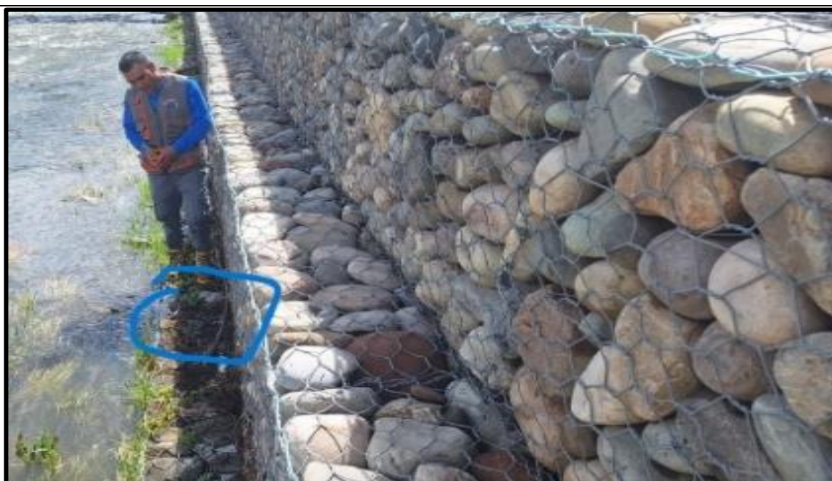
Figura A. 6: Identificación del muro en margen derecho donde observa el hundimiento en el primer nivel. Fuente: Propia 2026
