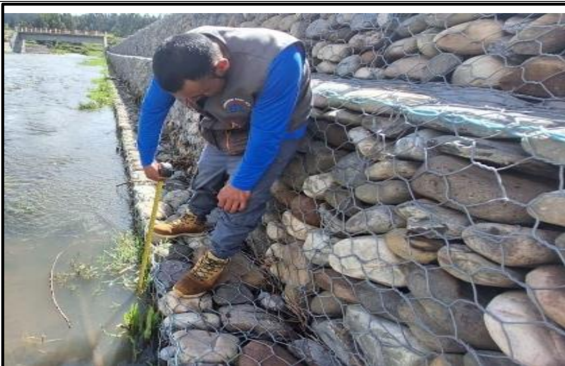
Figura A. 4: Identificación del muro en margen derecho en el tramo 0+000 a 0+050 Fuente: Propia 2026
