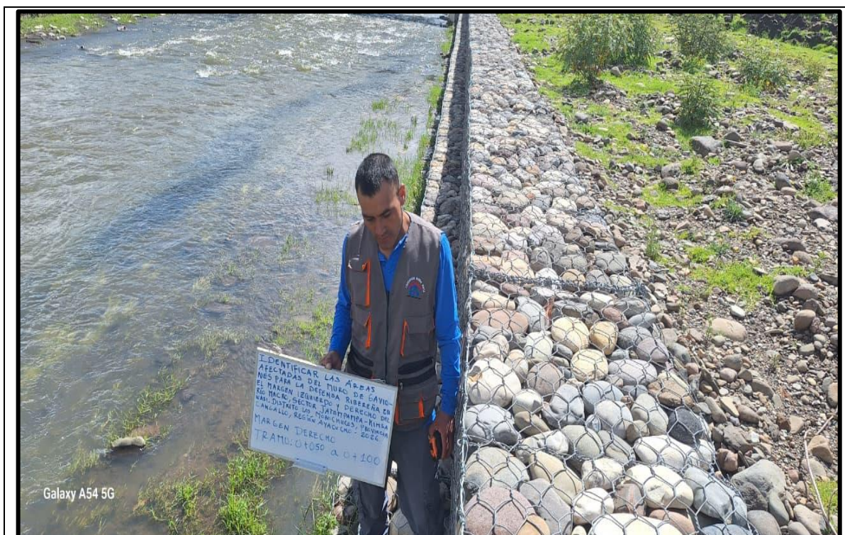
Figura A. 5: Identificación de muro de gaviones en margen derecho en el tramo 0+050 a 0+100 Fuente: Propia 2026
