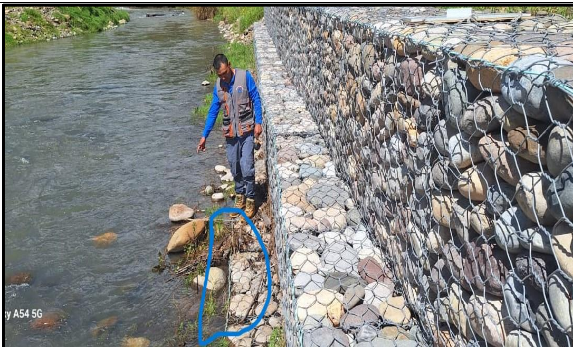
Figura A. 10: Identificación del muro en margen izquierdo donde observa el hundimiento en el primer nivel y observa la acumulación de piedras y tierras en el cauce del río. Fuente: Propia 2026
