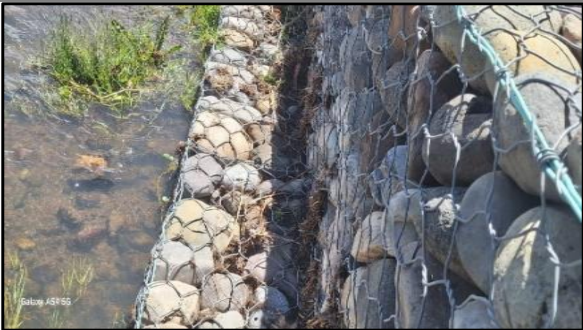
Figura A. 16: Evaluación de gaviones en margen derecho donde observa material de desmonte puede perjudicar el rompimiento de la malla. Fuente: Propia 2026
