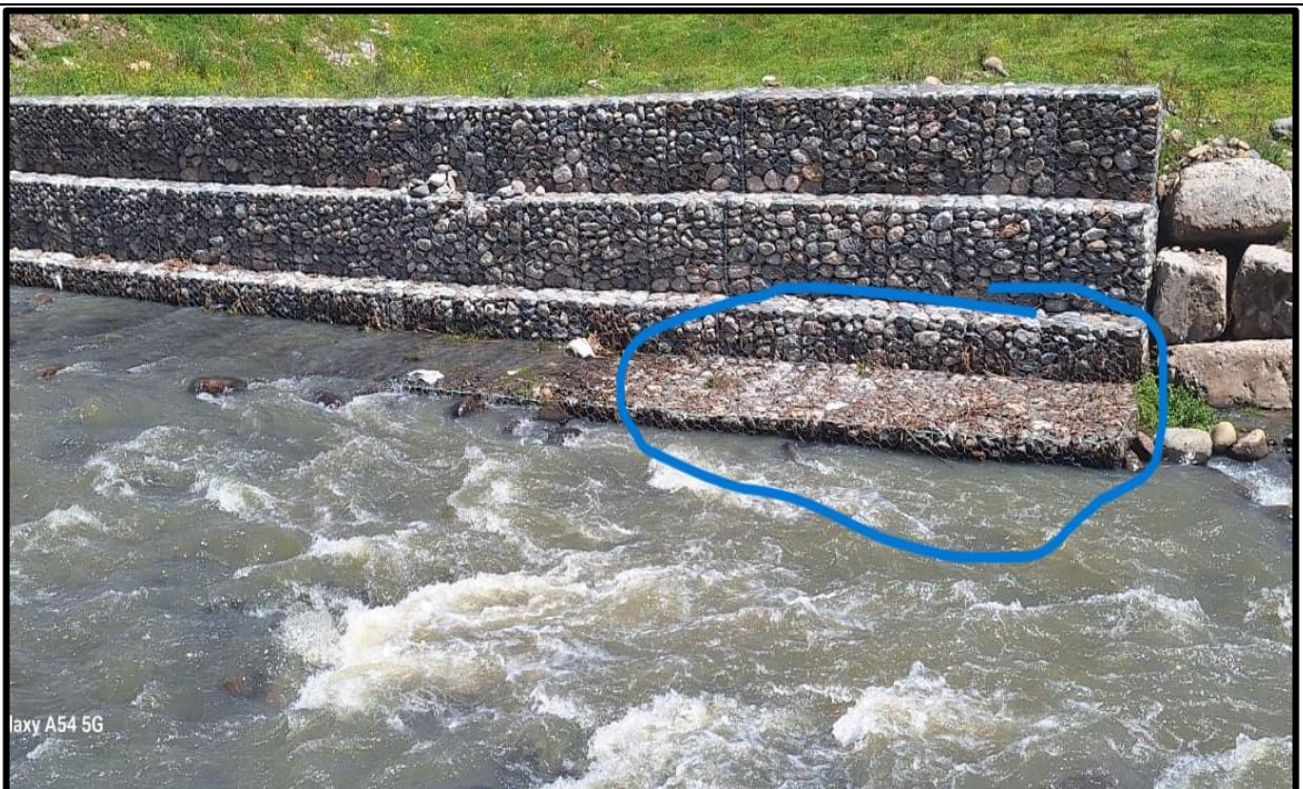
Figura A. 14: Identificación del muro en margen izquierdo donde observa el hundimiento y socavación en el primer nivel. Fuente: Propia 2026
