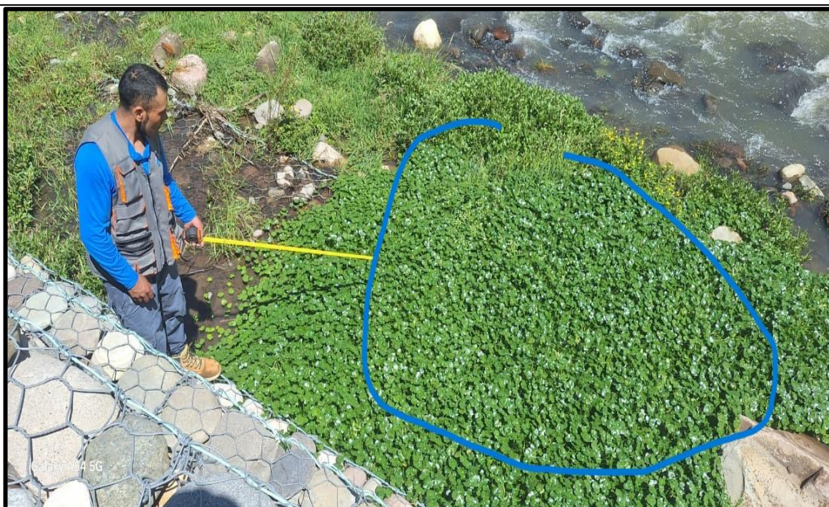
Figura A. 8: Identificación del muro en margen derecho donde observa el hundimiento en el primer nivel por acumulación de piedras y tierras en el cauce del río. Fuente: Propia 2026
