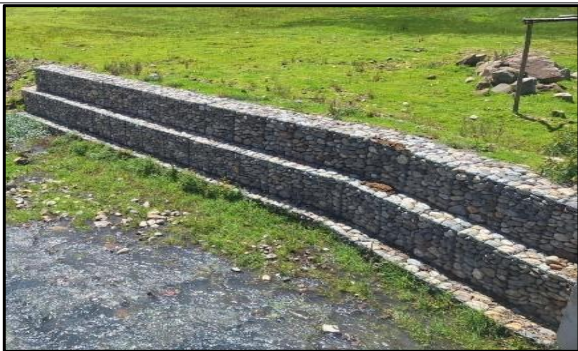
Figura A. 20: Evaluación de gaviones en margen derecho en donde se observa acumulación de materiales, esto más adelante va tener consecuencia como rotura de malla. Fuente: Propia 2026
