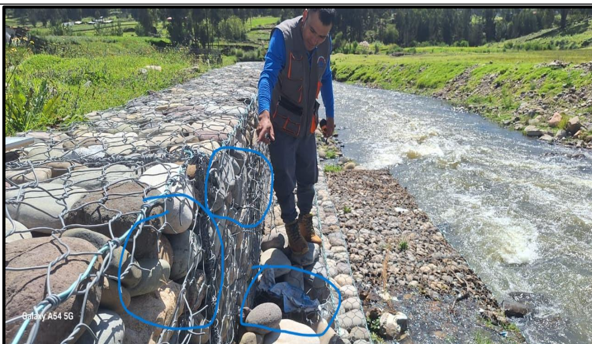
Figura A. 26: Evaluación de gaviones en margen izquierdo en donde se observa rotura de malla. Fuente: Propia 2026.
