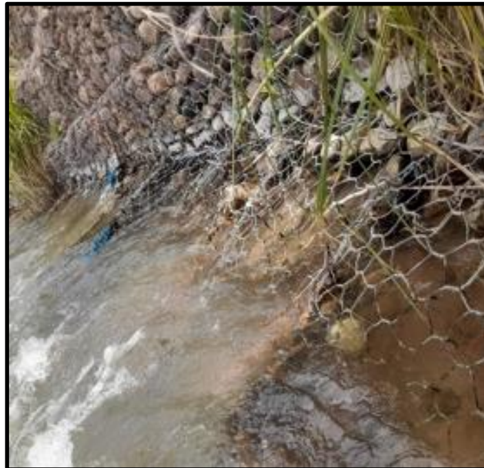
En la progresiva 0+150–0+180, presenta socavaciones, erosiones, a causa de la fuerte correntada del río, especialmente en la temporada de lluvias intensas, en la cual las patologías del muro en futuro presentan un riesgo de colapso.
