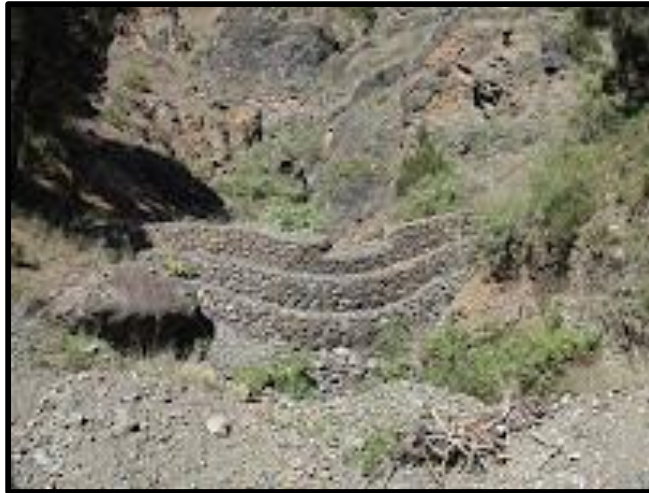
Figura 7. Desplazamiento de muro de gavión
