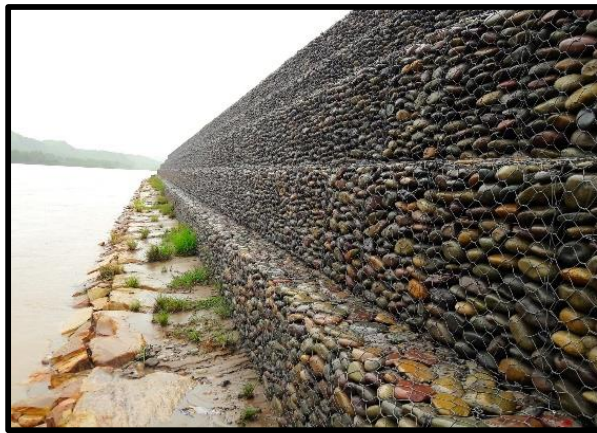
Figura 6. Roca rodada en muro de gavión
