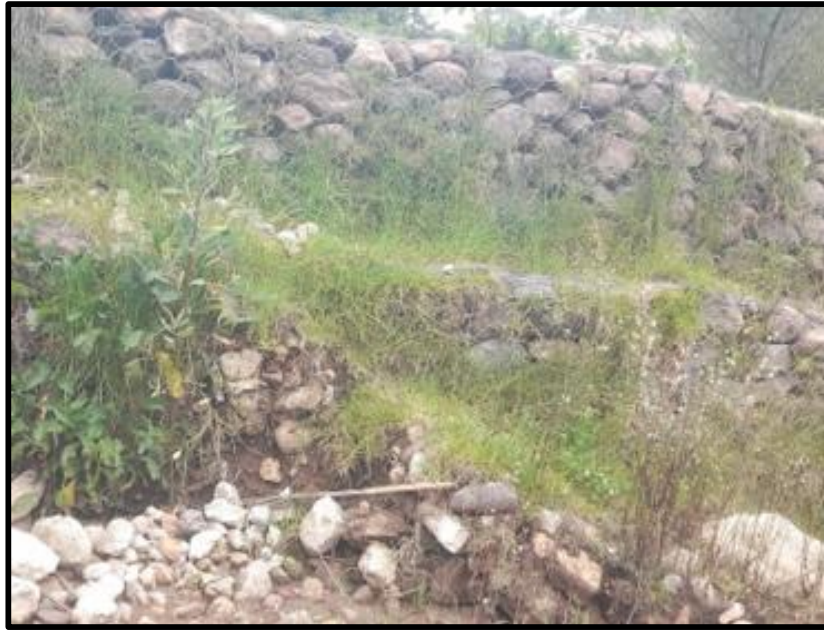
En progresiva 0+000 al 0+030 se observa erosión, hundimiento y socavaciones que afectan la estabilidad del terreno y del muro de gaviones.
