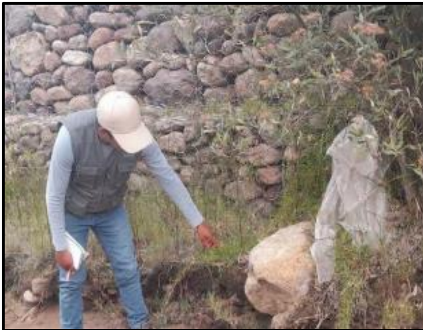
Progresiva 0+030 – 0+060 se observa hundimiento, socavación, deslizamiento en diferentes condiciones de ligero a severo
