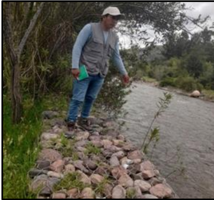
En la progresiva 0+150 al 0+180, el muro de gavión presenta hundimientos en condición ligero, a causa de ello el material de relleno perdiendo su forma como gavión.
