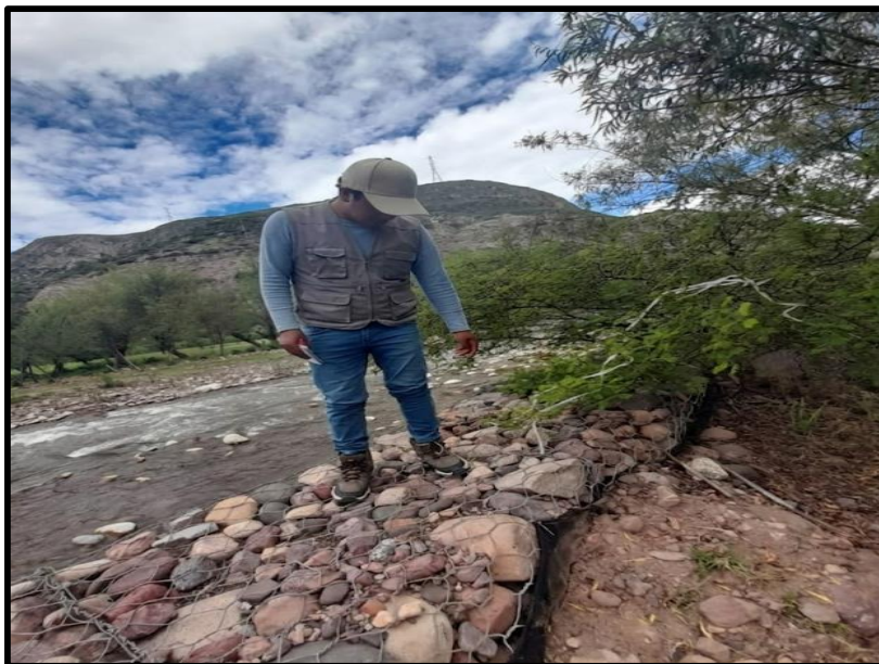
En la progresiva 0+060 al 0+090, el muro de gaviones presenta empuje de terreno natural del exterior, debilitando la estabilidad del muro, comprometiéndose en el futuro vuelco parcial y total
