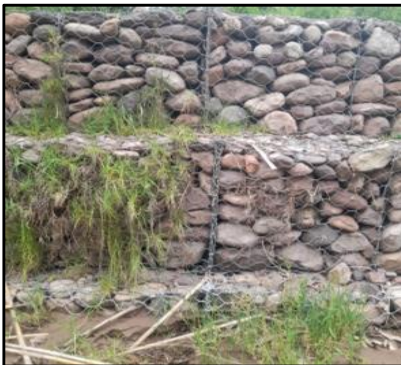
En la progresiva 0+060–0+090, Debido al empuje de las fuerzas externas, el muro de gavión presenta en proceso de vuelco, de la misma manera se aprecia socavaciones en la parte baja, evidenciando la inestabilidad
