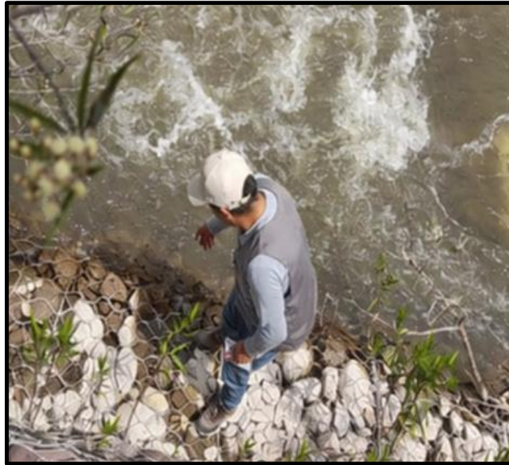
En la progresiva 0+120 al 0+150, se aprecia socavaciones y desprendimientos de piedras, a causa de las fuertes corrientadas que se presentan especialmente en temporadas de lluvias y ante ello debilita progresivamente la estabilidad del Muro
