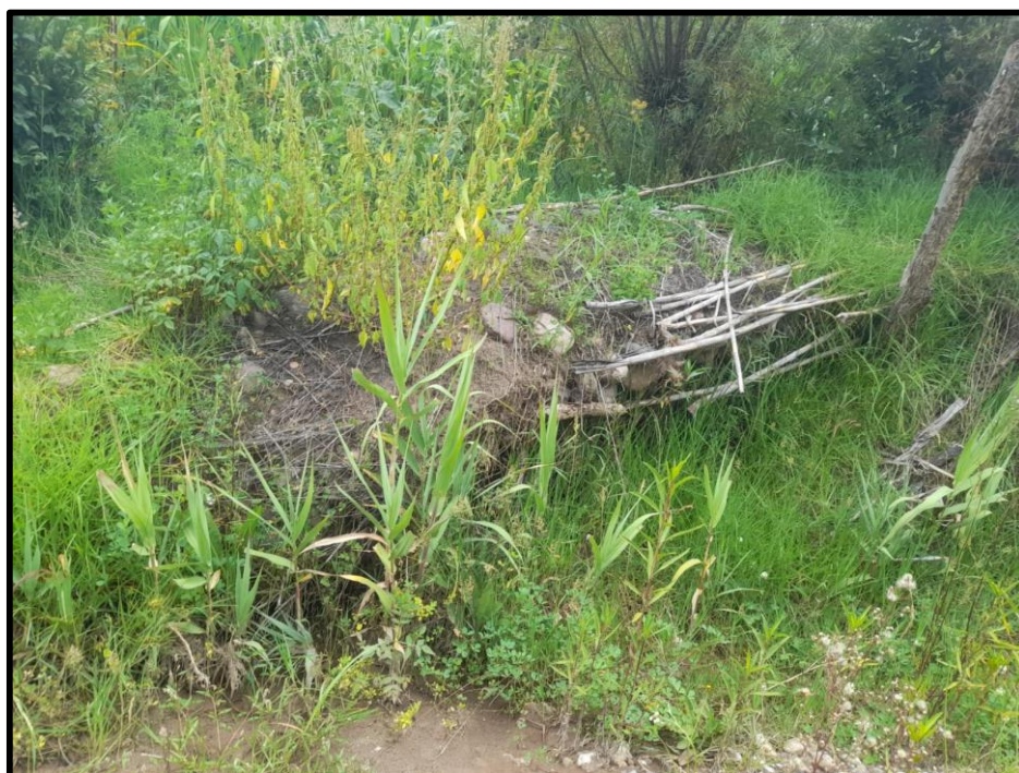
En esta progresiva 0+240 al 0+270, se aprecia hundimiento del muro de gavión y la socavación, evidenciando pérdida de su originalidad como funcionamiento del gavión, en la cual este tramo representa un riesgo de inundación ante la crecida de los ríos.
