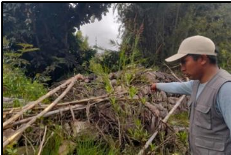
En la progresiva 0+240 al 0+270, se aprecia que, el muro de gavión ha perdido su originalidad a causa de los eventos ocurridos anteriormente, lo que en la actualidad presenta vuelco y colapso total del muro.
