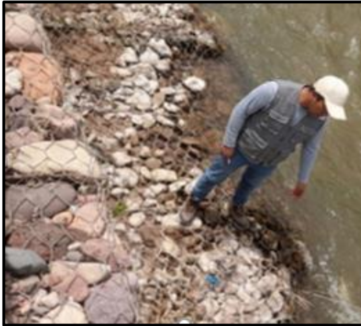
En la progresiva 0+210 al 0+240, se aprecia deslizamiento en condición ligera, lo que en futuro compromete la estabilidad del muro, de la misma forma las mallas presentan óxidos, corrosión, roturas.
