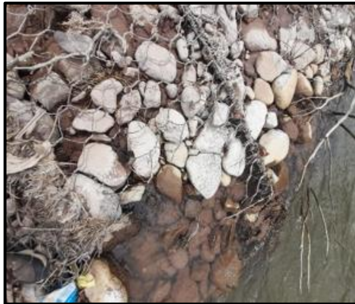
En la progresiva 0+120 al 0+150, de igual forma en la parte baja del muro se aprecia mallas con oxidos, corrosiones y roturas, en la cual se compromete salida de piedras y generando en el futuro los colapsos.
