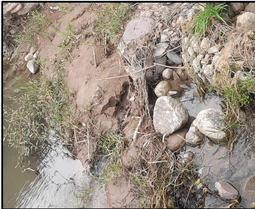
Progresiva 0+270 al 0+300, de la misma forma en este tramo ha presentado socavaciones, vuelcos, a causa de la crecida del río, así lo mismo se aprecia material de relleno que ha perdido su forma de estructura como muro de gavión y también se aprecia las mallas rotas, lo cual este tramo representa un riesgo de inundación a la población aledaña.
