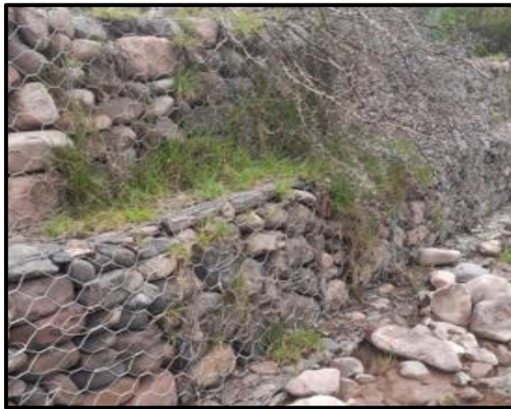
Progresiva 0+210 al 0+240, de la misma manera se aprecia que la socavación poco a poco se va aumentando, presentando en el futuro la inestabilidad del muro, también se aprecia vegetaciones y otros materiales acumulados en la superficie del muro
