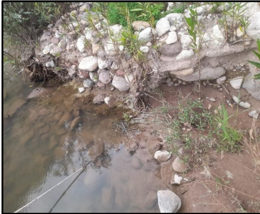
En la progresiva 0+270 al 0+300, presenta colapso total del gavión, evidenciando pérdida de funcionamiento como estructura de muro de gavión
