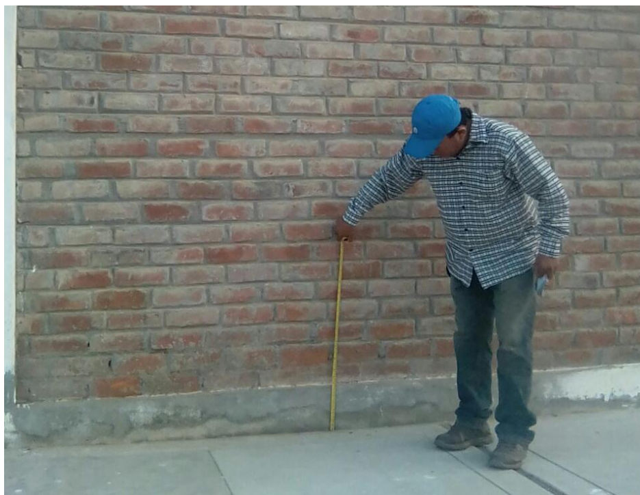
Gráfico 48: Presencia de erosión en el sobrecimiento.
