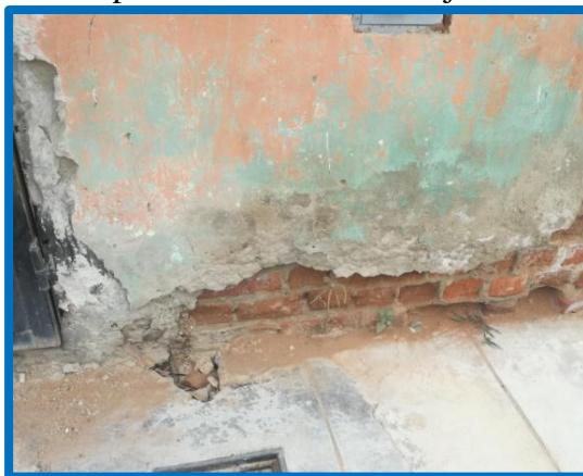
Gráfico 16: Desprendimiento en el tarrajeo del muro de albañilería
