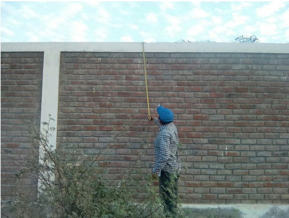
Gráfico 53: Presencia de fisuras en vigas soleras de confinamiento
