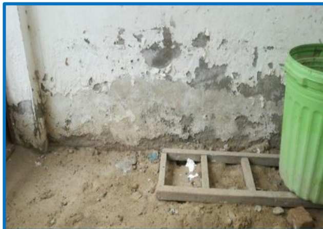
Gráfico 6: Humedad en parte inferior de muro.
