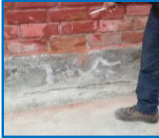
Gráfico 13: Eflorescencia afectando la superficie del sobrecimiento.
