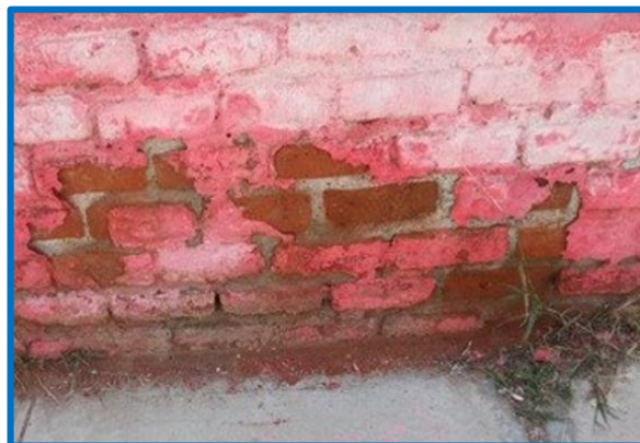
Gráfico 9: Humedad en muro de albañilería.
