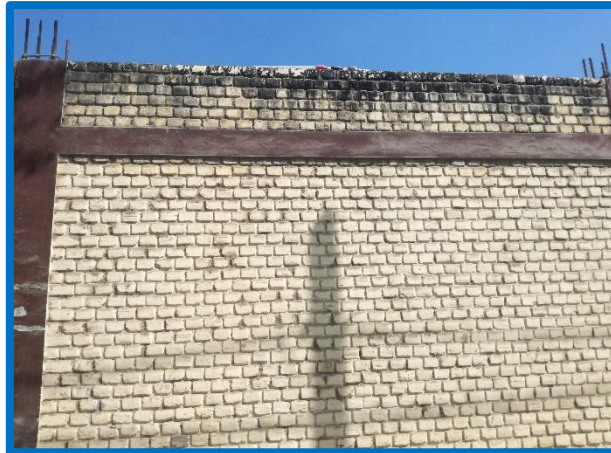
Gráfico 15: Suciedad en el muro de albañilería.
