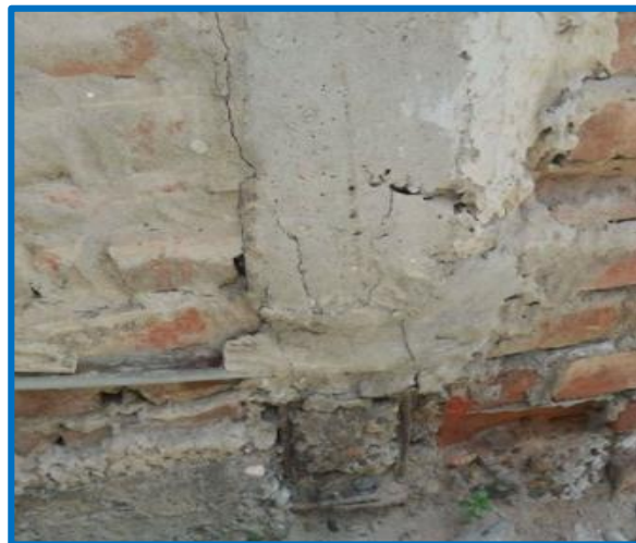
Gráfico 7: Patologías en la parte inferior de columna.
