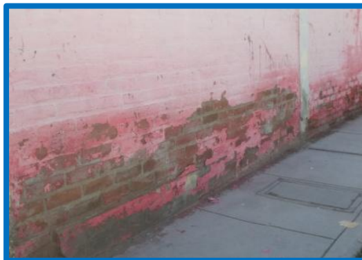
Gráfico 14: Humedad afectando la parte inferior del muro.
