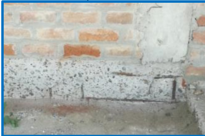
Gráfico 17: Oxidación y corrosión en el Sobrecimiento.
