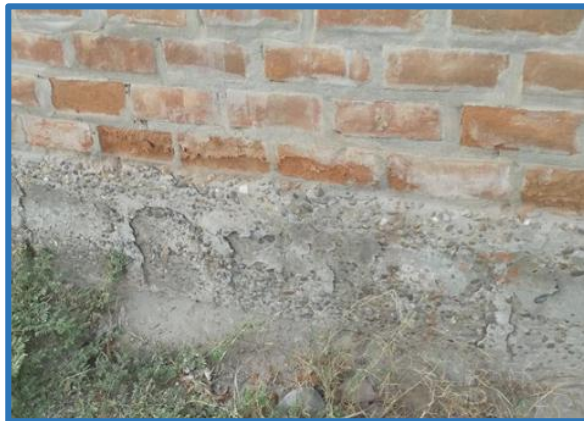
Gráfico 8: Patologías en muros de albañilería.
