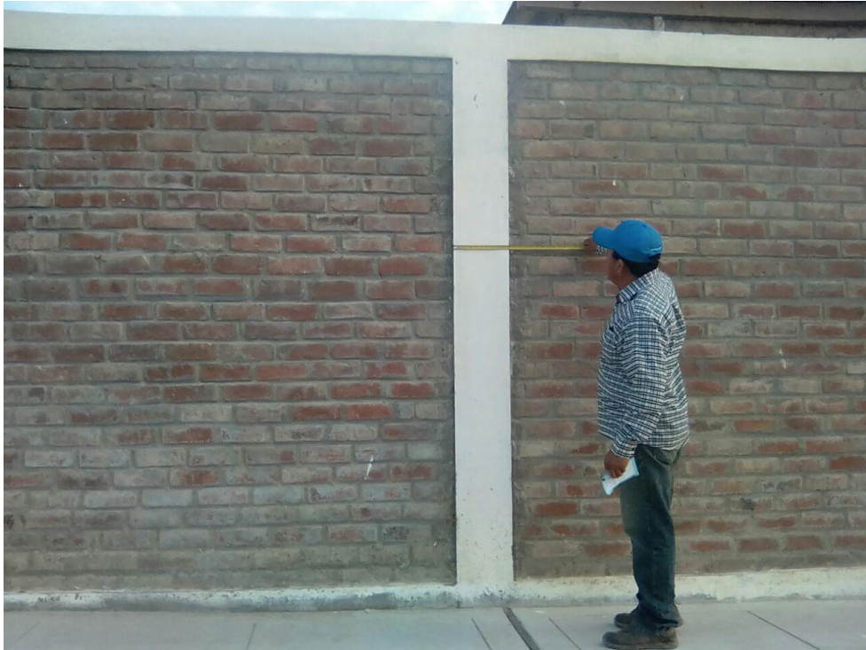
Gráfico 52: Presencia de fisuras en las columnas de confinamiento.
