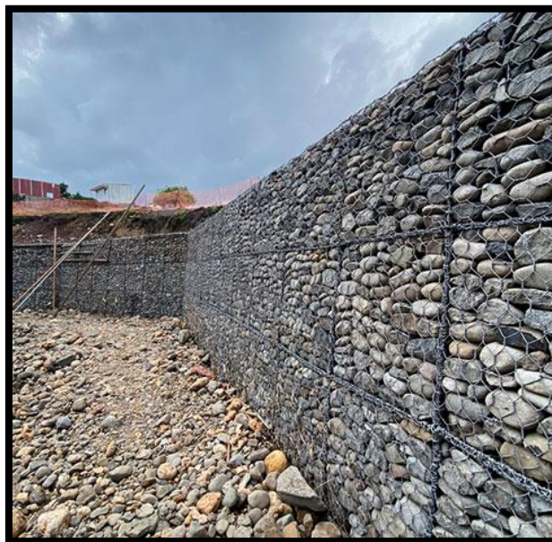
Figura 6: Muro de Gavión tipo caja
