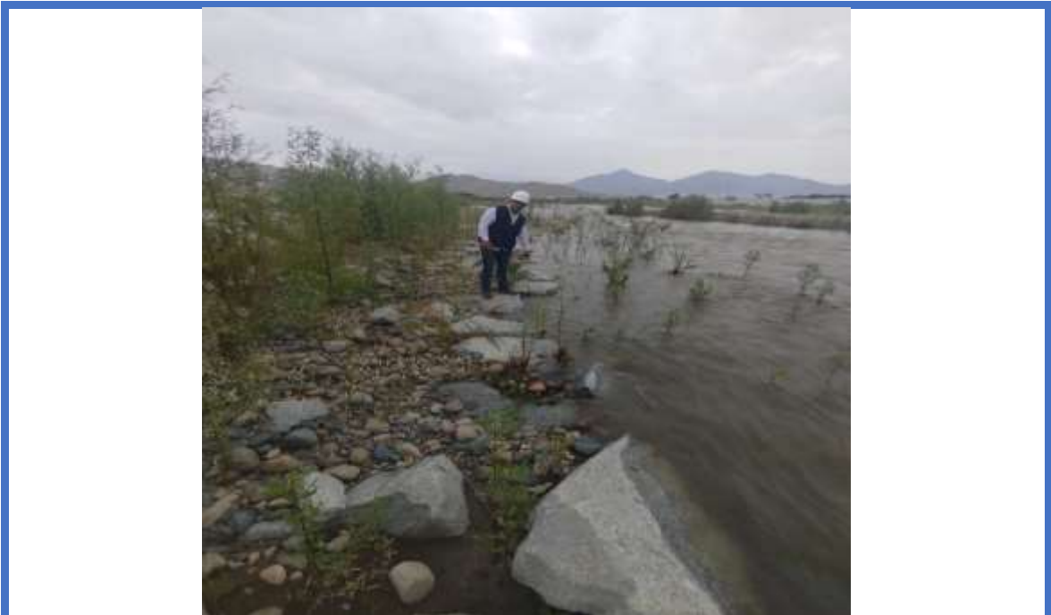
Foto N°23 En la imagen se visualiza la socavación avanzada del terreno, la cual ha expuesto las rocas que conforman la caja de uña del enrocado en la progresiva 0+400. Fecha: 10 de marzo
