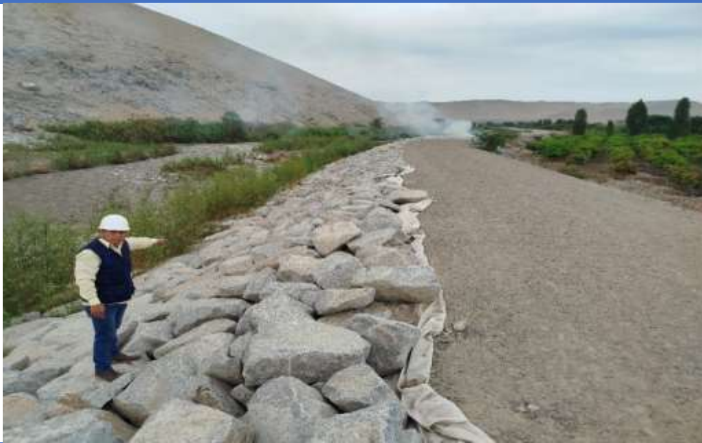
Foto N°13 En la imagen se observa la corona de la defensa ribereña en la progresiva Fecha: 0+200, la cual presenta un ancho medido de 5.70 metros. 07 de marzo
