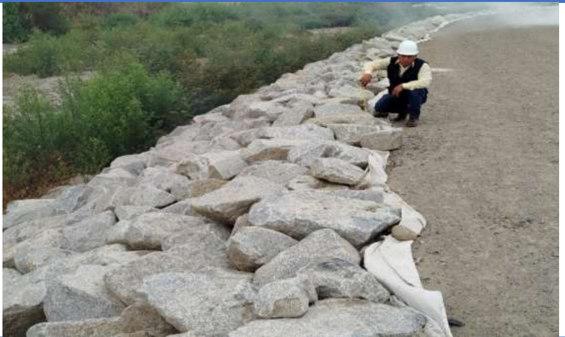
Foto N°25 En la imagen se observa la reducción del espesor del enrocado en la parte superior en la progresiva 0+450. Esta condición se debe a la presencia de rocas de menor tamaño. Fecha: 07 de marzo
