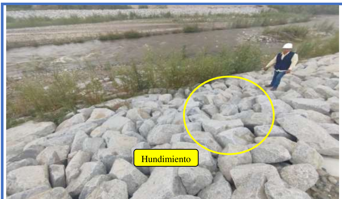
Foto N°22 En la imagen se observa hundimiento de enrocado en la parte baja del talud, como la socavación implacable de la corriente del río, progresiva 0+370. Fecha: 07 de marzo
