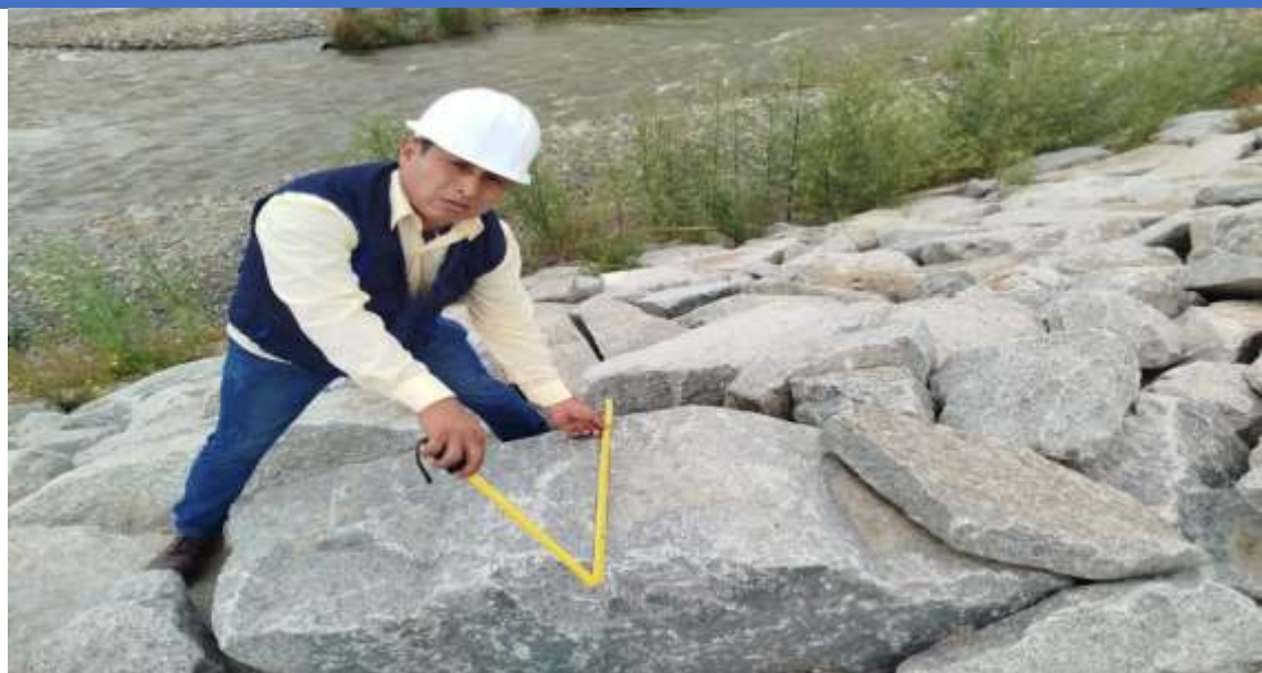
Foto N°14 La imagen destaca la presencia de bloques rocosos de considerable Fecha: magnitud (1.60 x 0.70 metros) situados en la sección superior del talud. 07 de marzo Estas formaciones representan una carga concentrada que ejerce una presión significativa, siendo un factor clave en el desarrollo de los asentamientos evidenciados en el enrocado.
