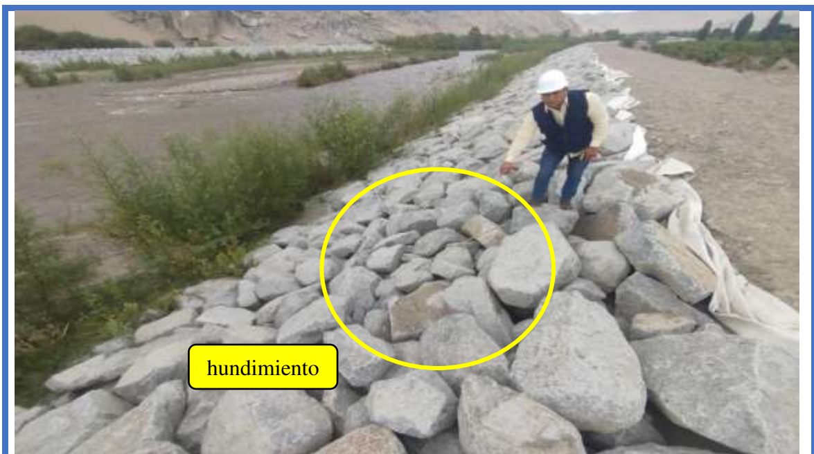
Foto N°04 En la imagen se observa el hundimiento del enrocado en la progresiva 0+060, atribuido a la carga ejercida por rocas de gran tamaño localizadas en la parte superior del talud. Fecha: 07 de marzo
