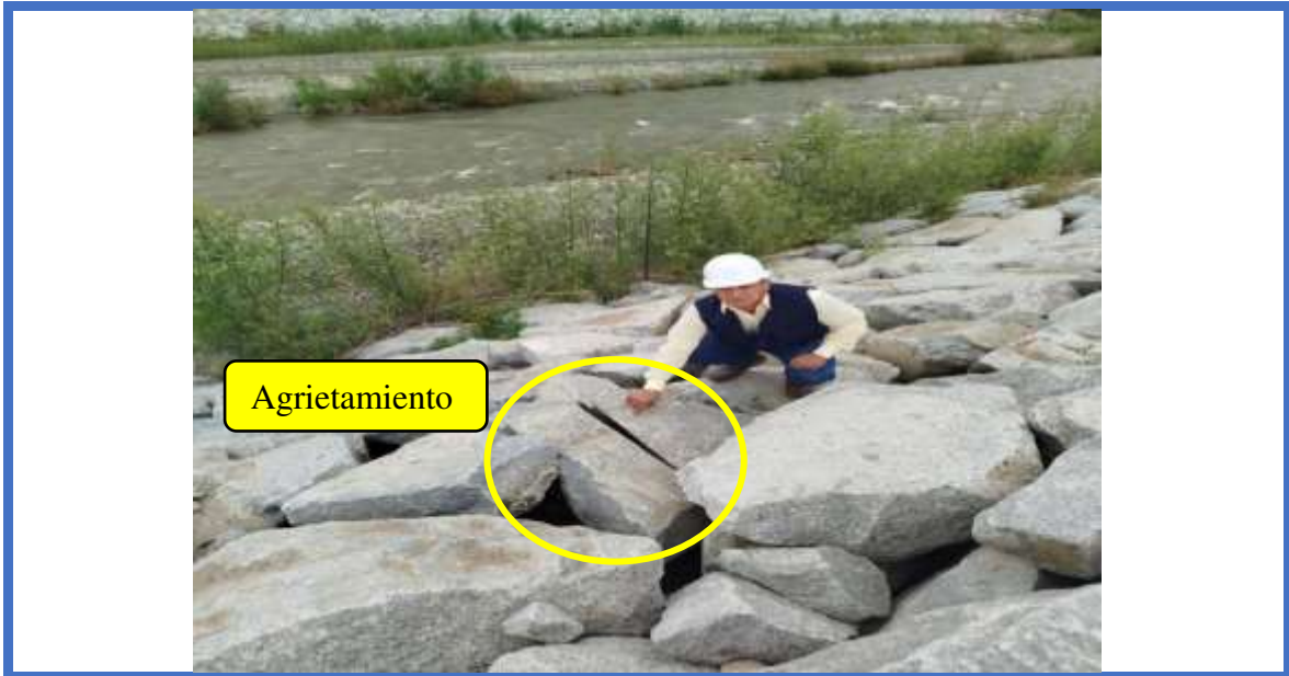
Foto N°11 La imagen documenta la presencia de rocas con un claro estado de agrietamiento en el enrocado, a lo largo de las progresivas 0+120 a 0+140, indicando una degradación estructural del material. Fecha: 07 de marzo
