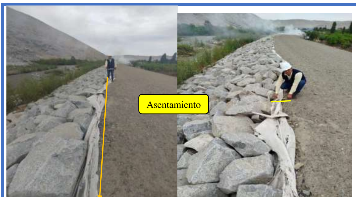
Foto N°20 En la imagen se visualizan las mediciones detalladas de los asentamientos detectados en el enrocado, específicamente a lo largo del tramo comprendido entre las progresivas 0+300 y 0+400. Estas mediciones revelan un rango significativo de deformación, con valores que oscilan entre 0.45 y 0.70 metros Fecha: 07 de marzo
