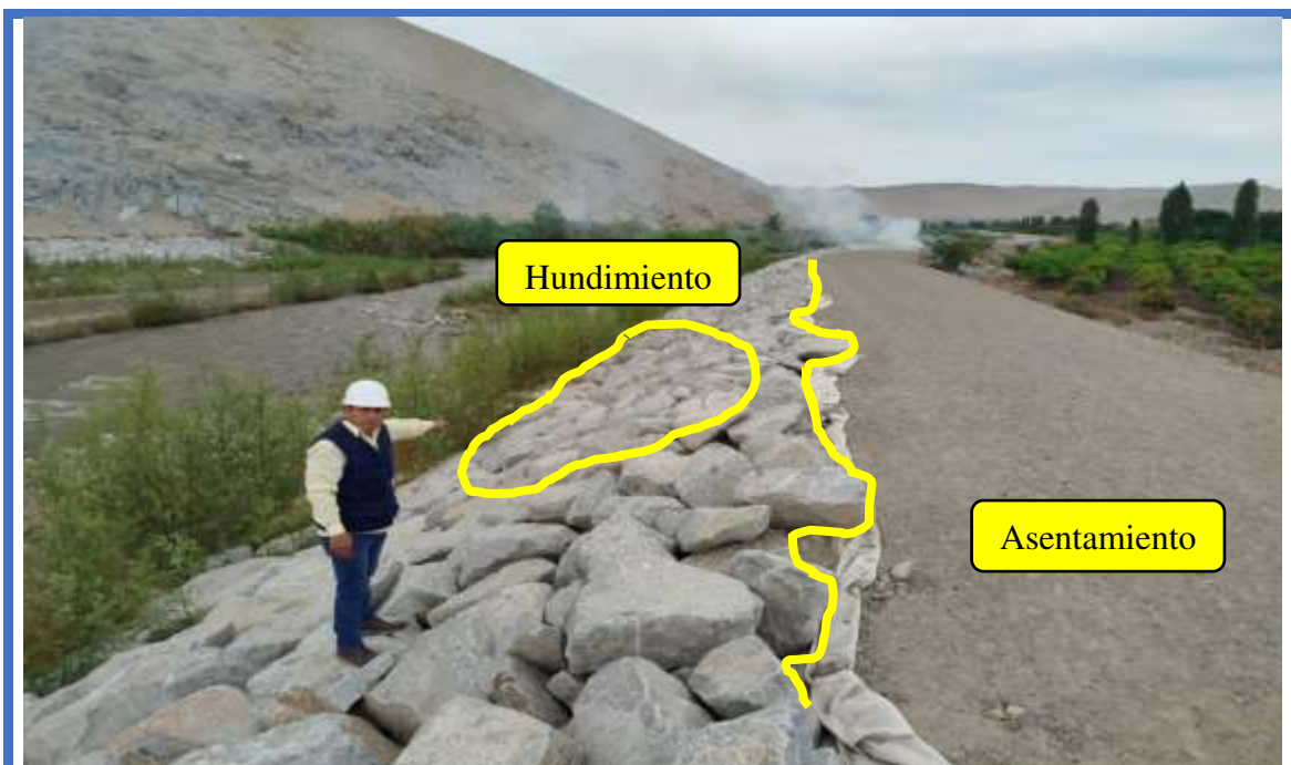
Foto N°21 En la imagen se visualizan de manera conjunta el hundimiento y los asentamientos del enrocado desde 0.25 hasta 0.55 metros, en la progresiva 0+330. Fecha: 07 de marzo
