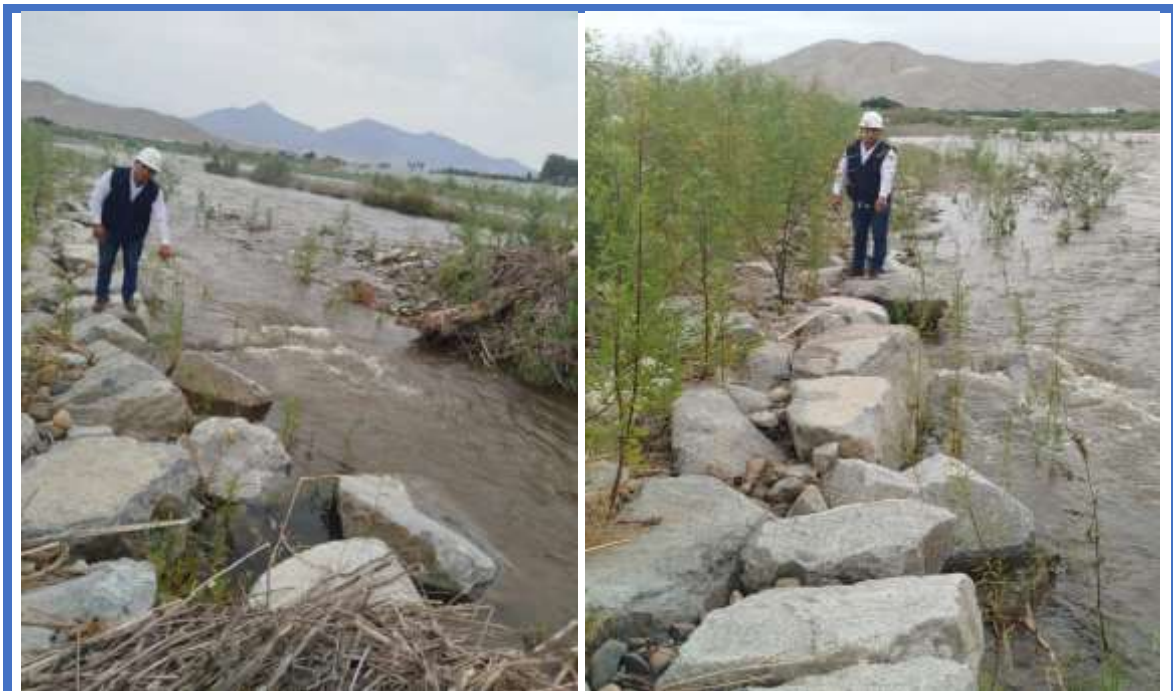
Foto N°28 En la imagen se observa la socavación en esta zona fundamental reduce drásticamente la capacidad de carga del talud, facilitando los asentamientos y aumentando exponencialmente el riesgo de un colapso o deslizamiento, progresiva 0+500. Fecha: 10 de marzo
