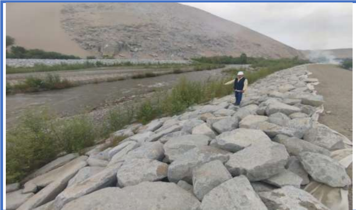
Foto N°17 La imagen, tomada desde un plano elevado, documenta la interacción crítica entre la corriente del río y la caja de uña, la cual coexiste con un notorio asentamiento del enrocado. Esto sugiere una afectación conjunta por la erosión fluvial y la inestabilidad geotécnica, progresiva 0+260 Fecha: 07 de marzo
