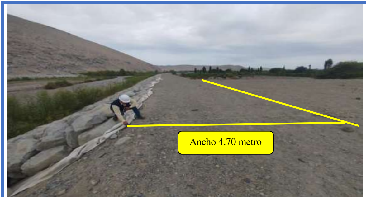
Foto N°02 En la imagen se observa la corona de la defensa ribereña en la progresiva 0+000, con un ancho medido de 4.70 metros. Se detecta una ligera erosión en el extremo izquierdo. Fecha: 07 de marzo
