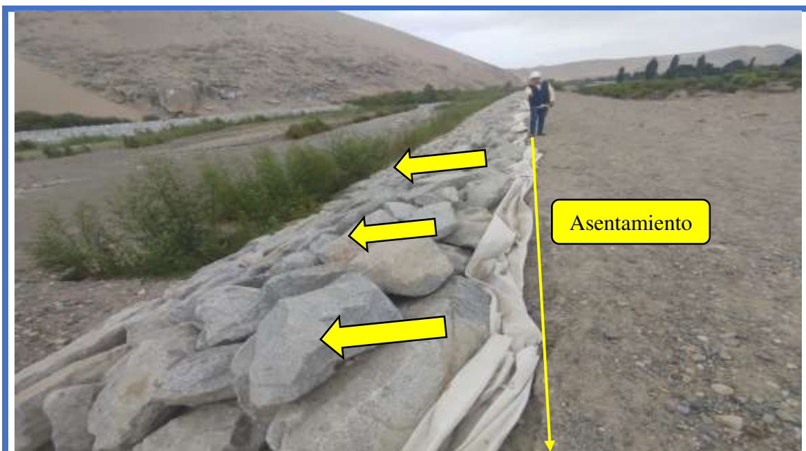
Foto N°05 En la imagen se observan asentamientos del enrocado, con una magnitud que oscila entre 0.55 y 0.60 metros hacia la parte inferior del talud, abarcando el tramo de la progresiva 0+000 a la 0+100. Fecha: 07 de marzo
