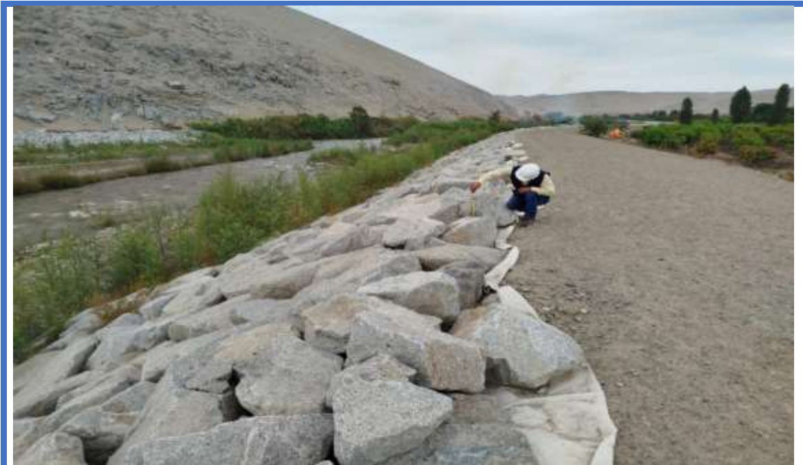
Foto N°15 En la imagen se aprecia la inadecuada distribución granulométrica del enrocado, particularmente en su parte superior, donde se concentran rocas de grandes dimensiones con un espesor característico de 1.00 metro. Fecha: 07 de marzo
