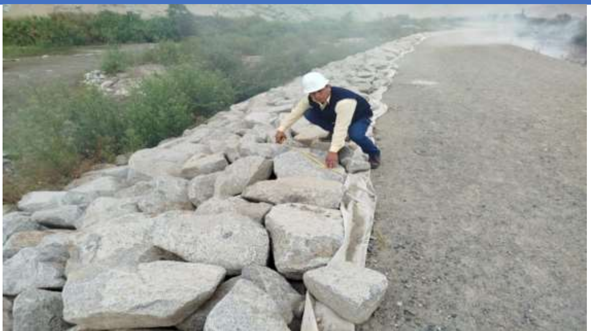
Foto N°26 En la imagen se visualizan la toma de mediciones de las rocas en la sección superior del talud, en la progresiva 0+470, las cuales presentan dimensiones reducidas (0.70 x 0.40 metros). Fecha: 07 de marzo
