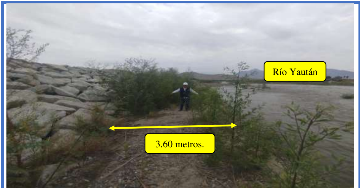
Foto N°12 La imagen destaca la acción erosiva continua del río, la cual ha generado una socavación avanzada en la base del terreno. Esta acción fluvial ha reducido drásticamente el soporte, dejando un ancho remanente de tan solo 3.60 metros, progresiva 0+200. Fecha: 10 de marzo
