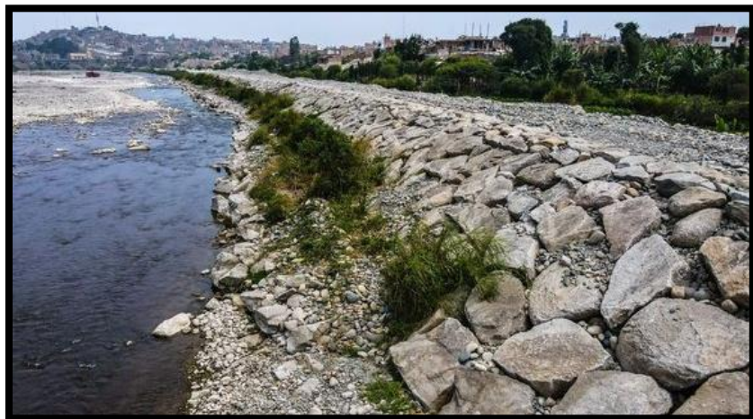
Figura N° 2: Defensa ribereña enrocado Fuente: Mundo de gaviones (21)
