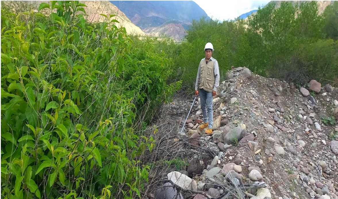
Foto 7: Se observa mucha vegetación al borde de los gaviones.
