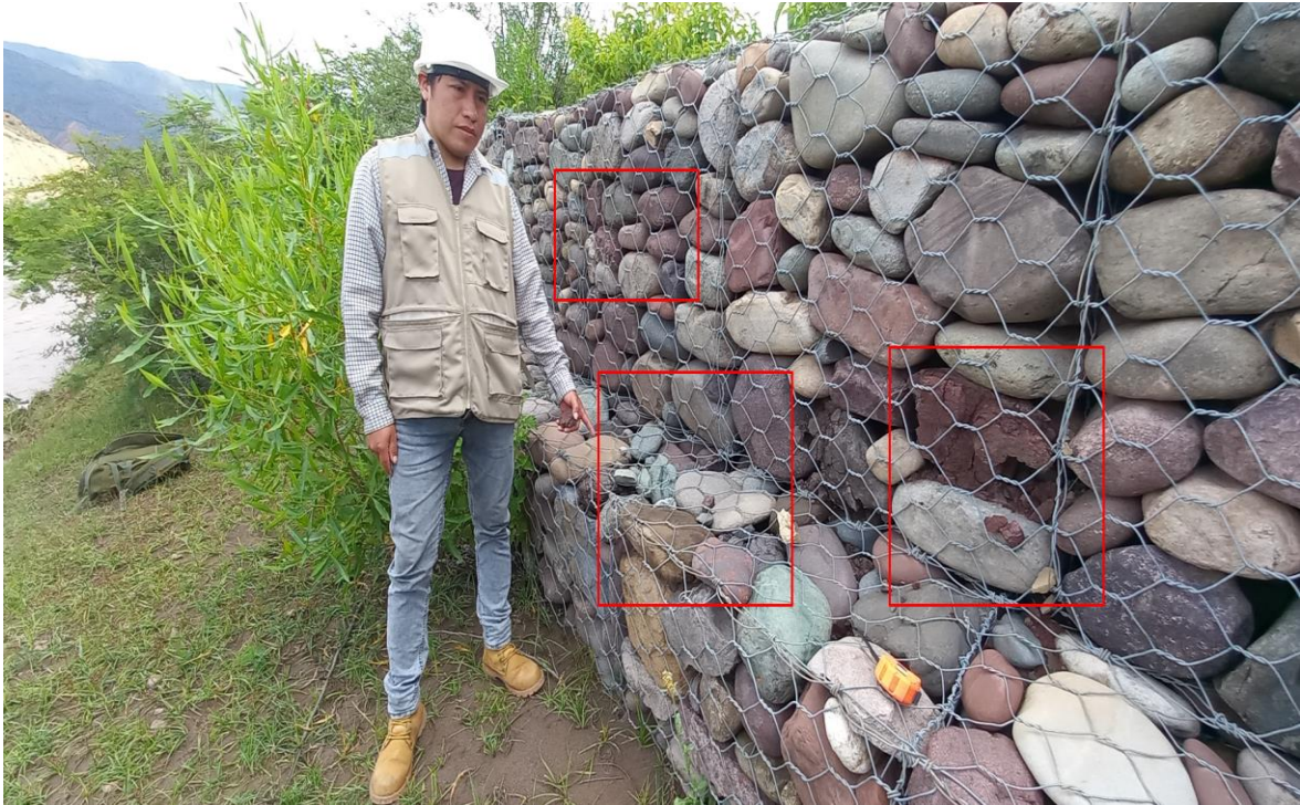
Foto 9: Se observa la descomposición de las piedras y fisuras a causa de las condiciones climáticas
