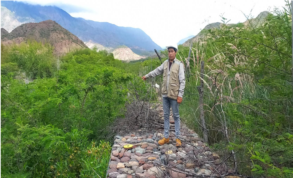
Foto 5: Se observa un muro de gaviones con mucha vegetación a su alrededor.
