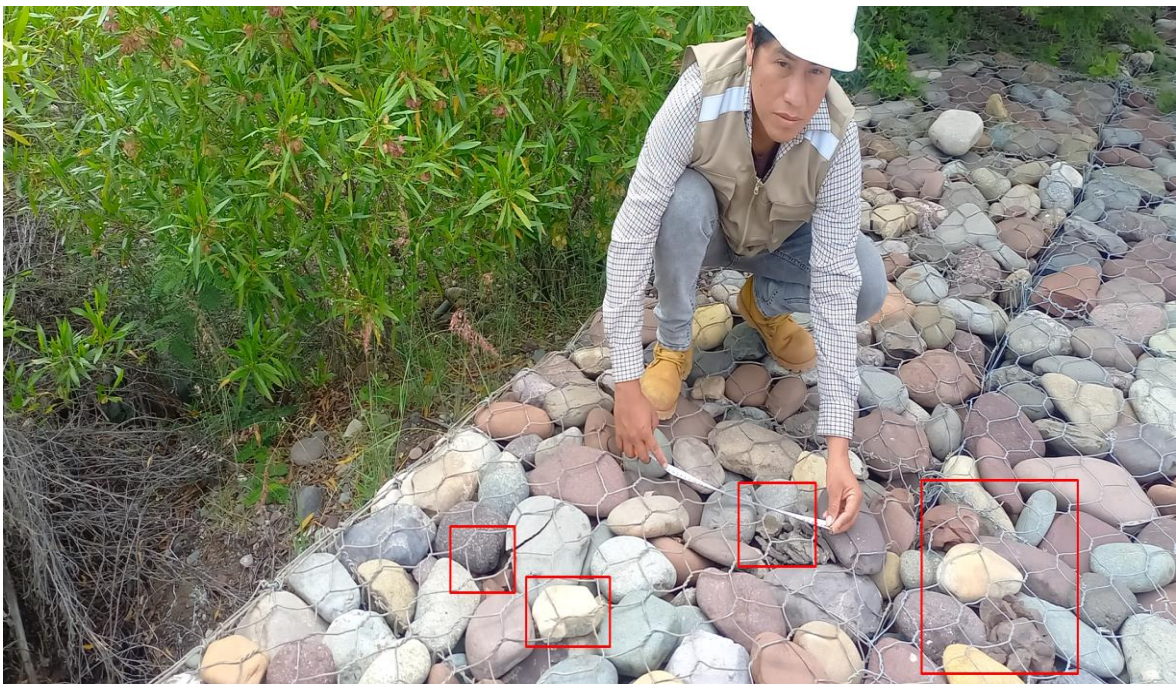
Foto 4: Se observa un muro de gaviones donde se miden las dimensiones de la malla para evaluar su estructura.
