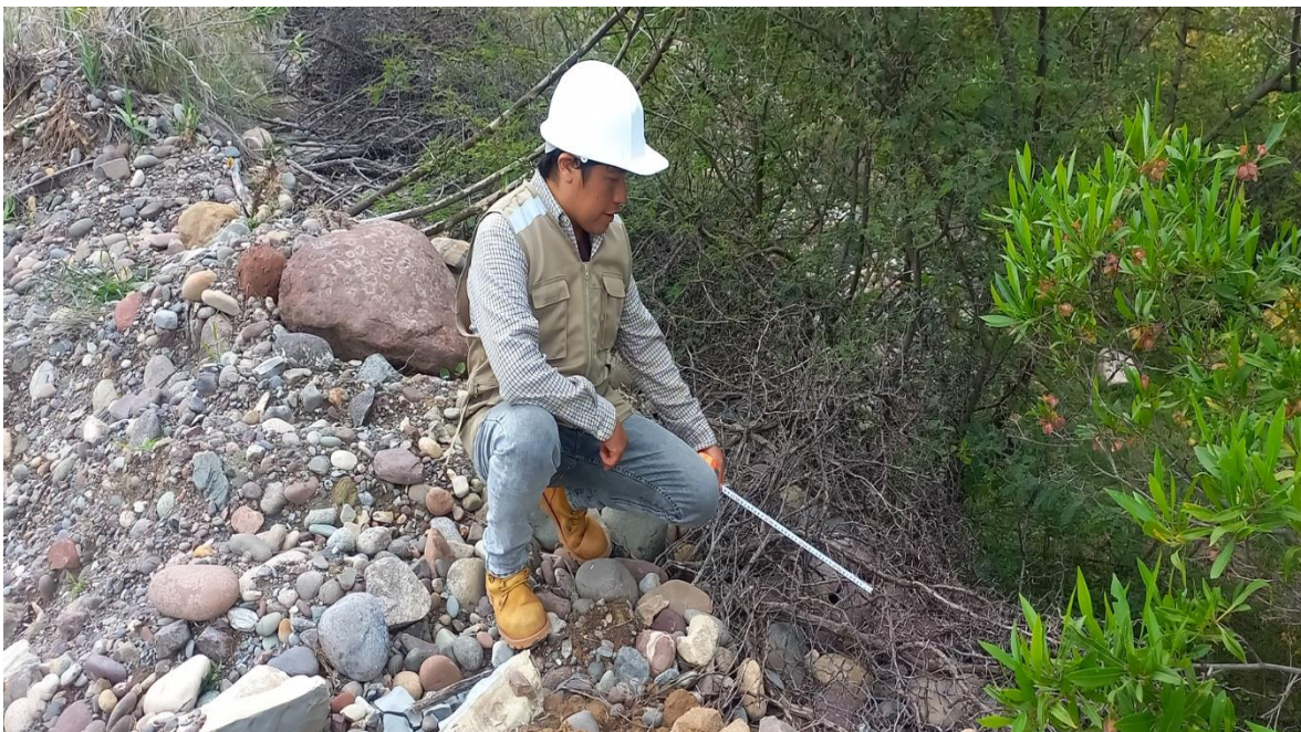
Foto 6: Se observa mucha vegetación al borde de los gaviones y montículo de piedras con arena cubriéndolo.
