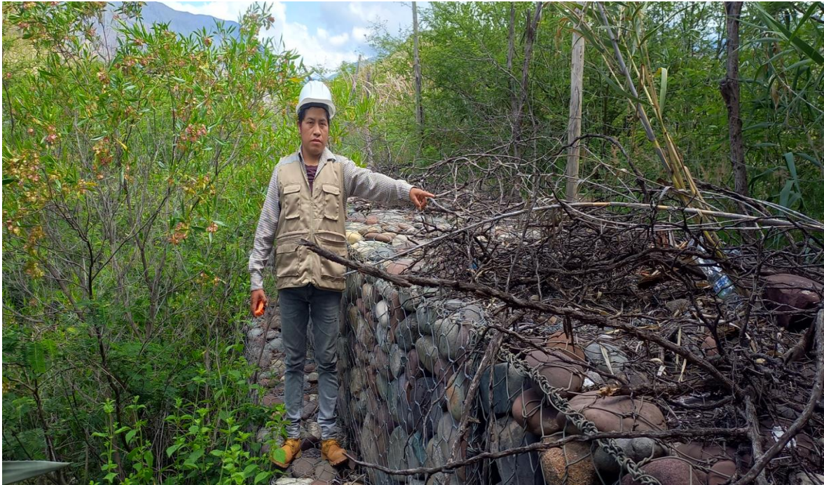
Foto 3: Se observa un muro de gaviones con acumulación de ramas y vegetación que afecta su funcionamiento estructural.
