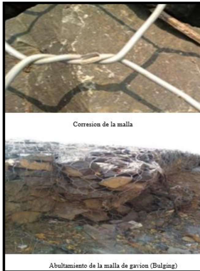
Figura N° 17: Tipo de daños Fuente: Fallas de muros de gaviones(53)
