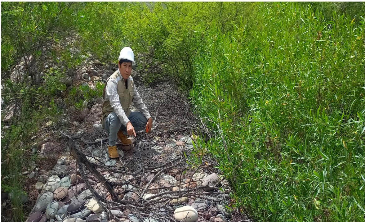
Foto 2: Se observa un gavión deteriorado con material disperso y ramas acumuladas.
