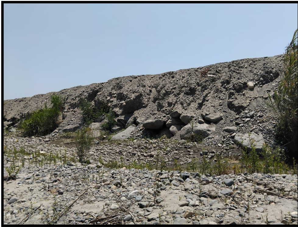
Figura 26: Discontinuidad del enrocado en la progresiva 0+050 – 0+100.
