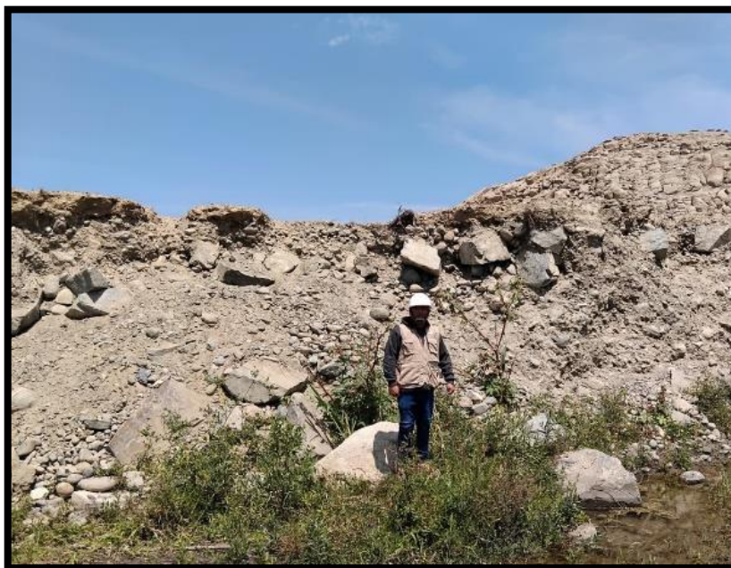
Figura 21: Se observa alta vegetación en el enrocado en la progresiva 0+150 – 0+200.
