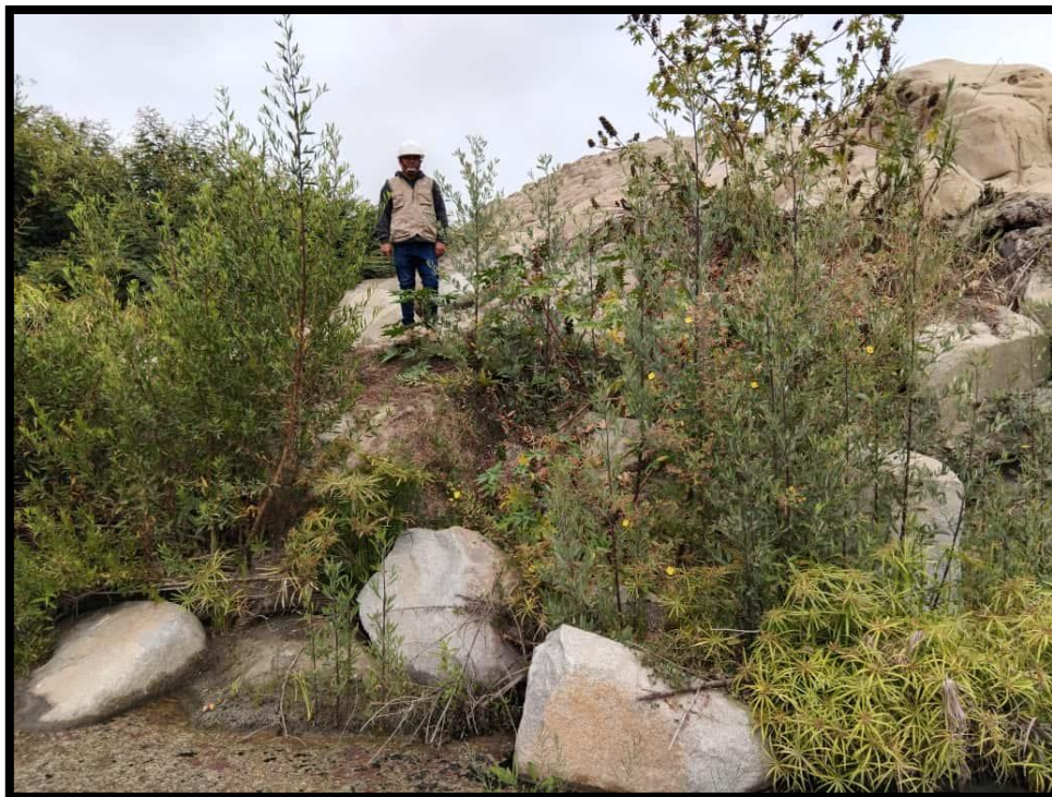
Figura 28: Deslizamiento del enrocado y malezas en la progresiva 0+100 – 0+150.
