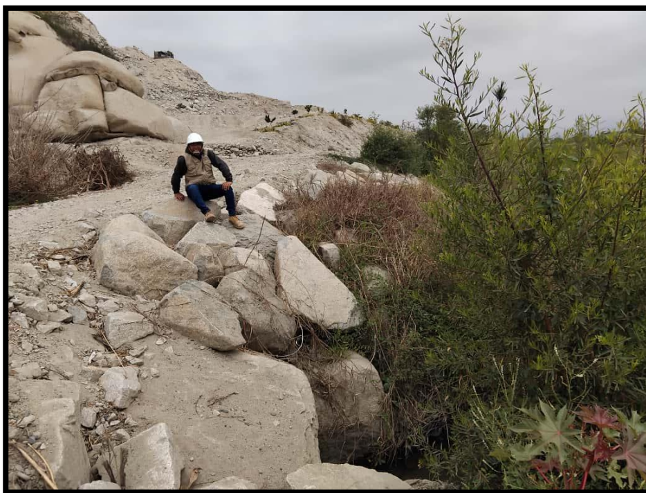
Figura 25: Se visualiza la inestabilidad del enrocado en la progresiva 0+350 – 0+400.
