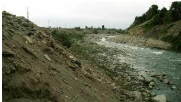
Figura 6: Desprendimiento y deslizamiento
