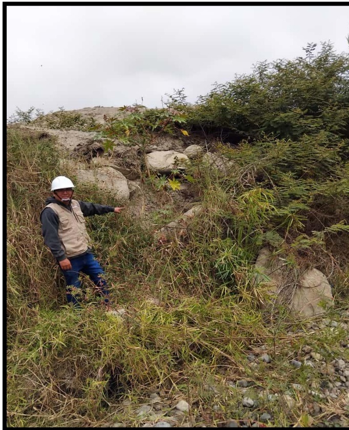
Figura 27: Presencia de malezas en el enrocado en la progresiva 0+250 – 0+300.
