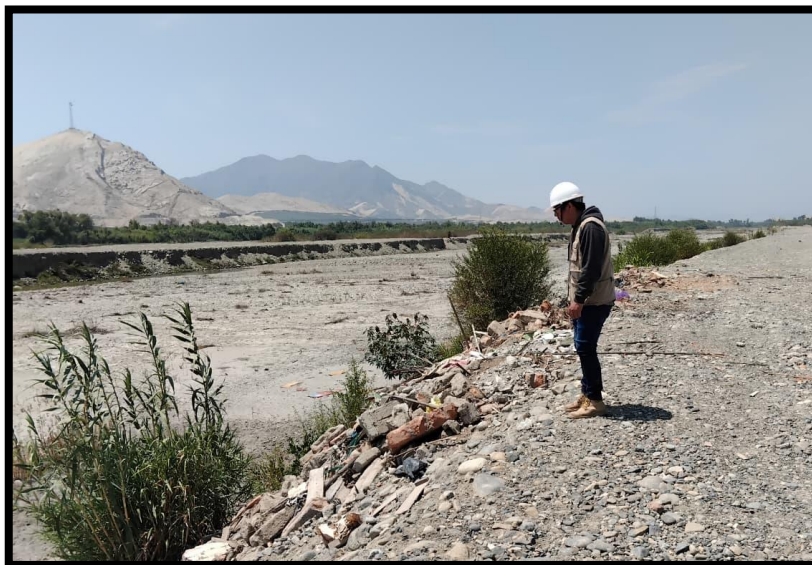
Figura 19: Se observa desmonte y basura en el talud en la progresiva 0+000 – 0+050.
