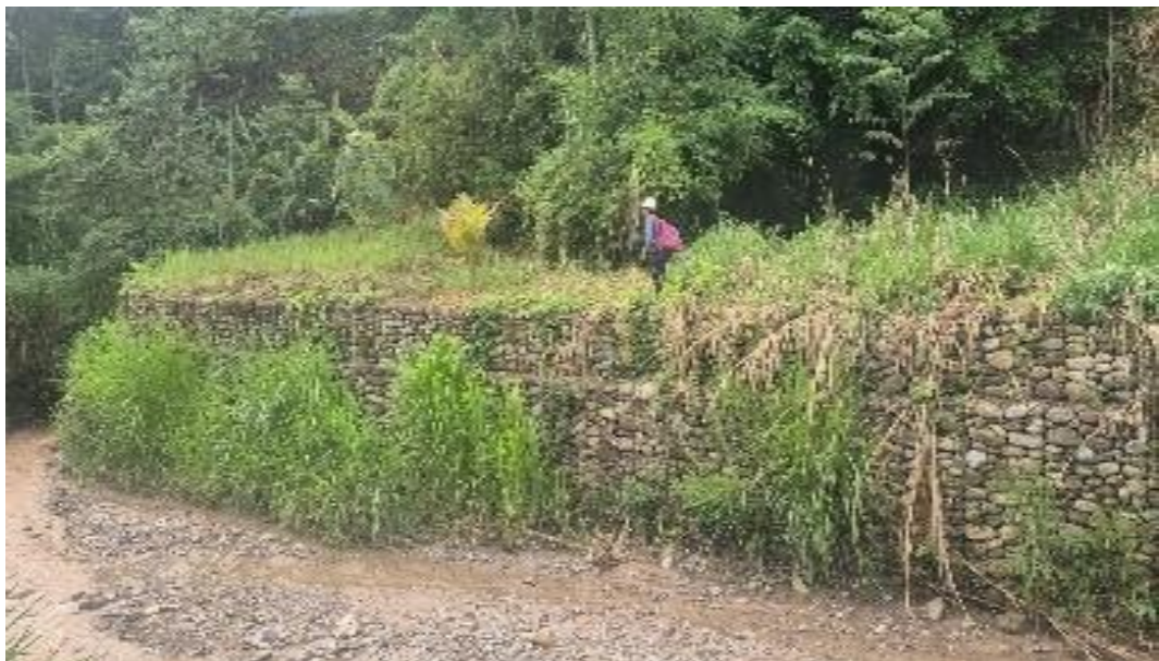
Figura 25: Verificación de vegetación que cubre toda la estructura del muro de gavión.
