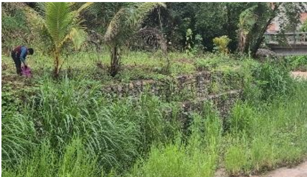
Figura 22: Verificando extensa vegetación, escombros y presencia de material de canto rodado.
