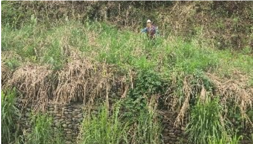
Figura 20: Verificando una extensa vegetación en el muro de gavión.
