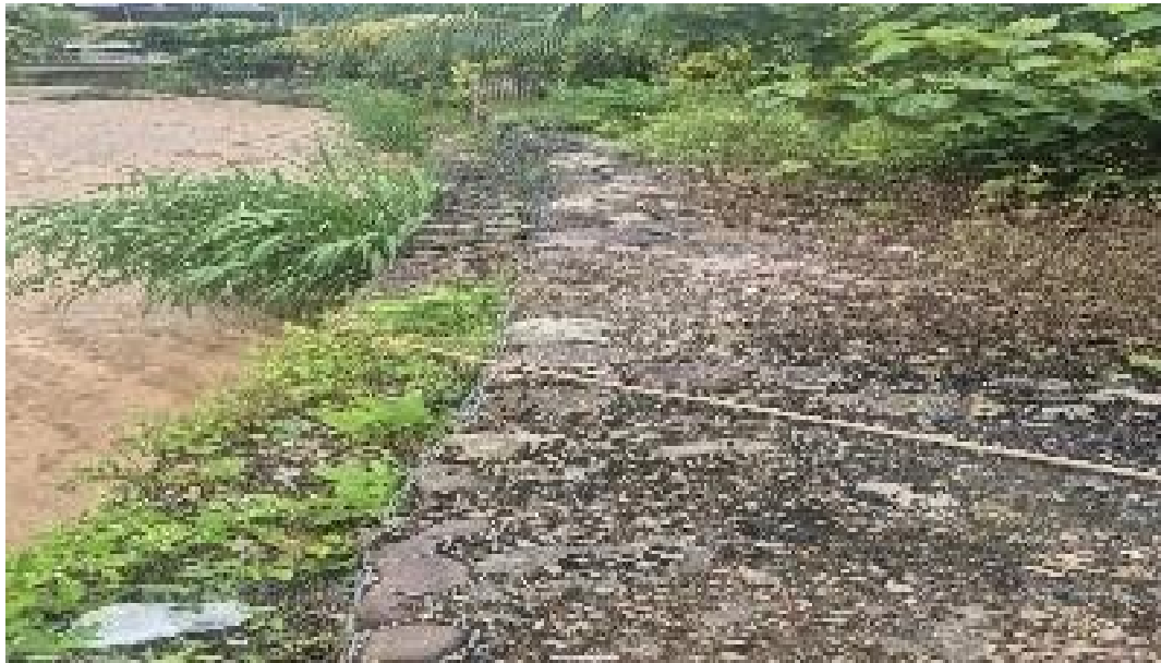
Figura 16: El gabión presenta vegetación y se observa deflexión a consecuencia de la erosión ocasionada por el aumento del caudal del río.
