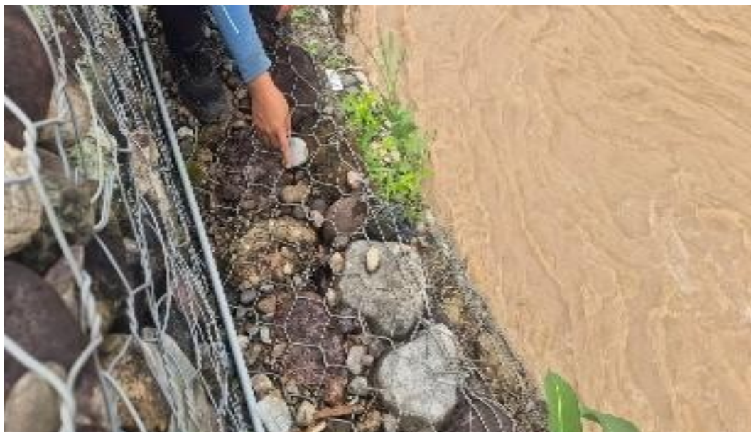
Figura 12: presenta material de canto rodado, en el gavión de tipo caja.
