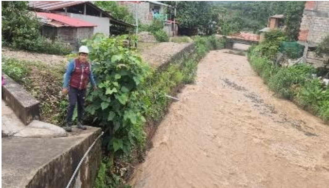
Figura 18: presencia de tubería de agua en la cimentación del pontón.
