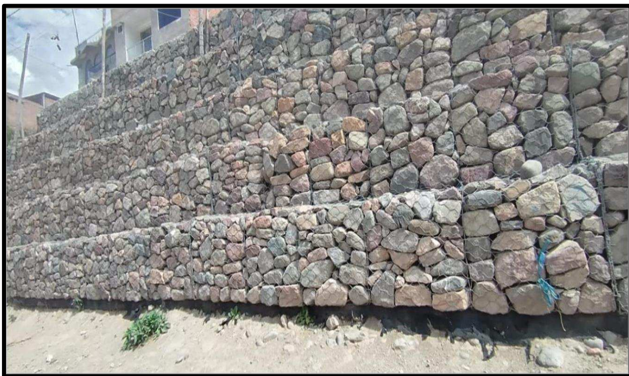
Foto 10. Visualización de socavación en el tramo 0+340
