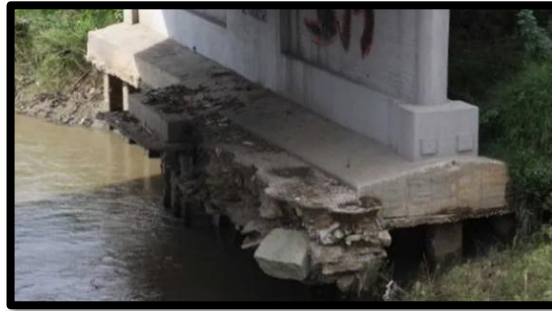
Figura 11. Socavación de estructura
