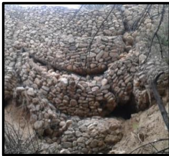
Figura 10. Colapso de estructura por sedimentación
