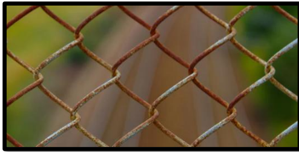
Figura 12. Corrosión de malla metálica
