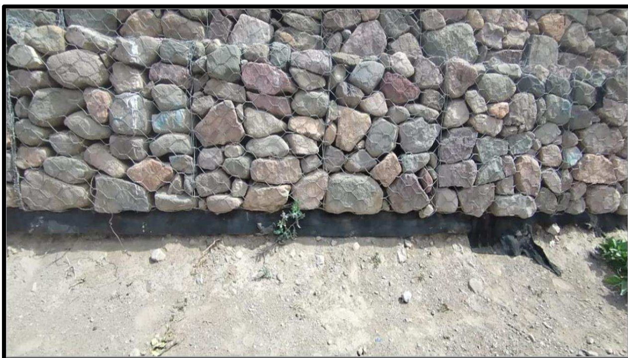
Foto 8. Visualización de geomembrana dañada
