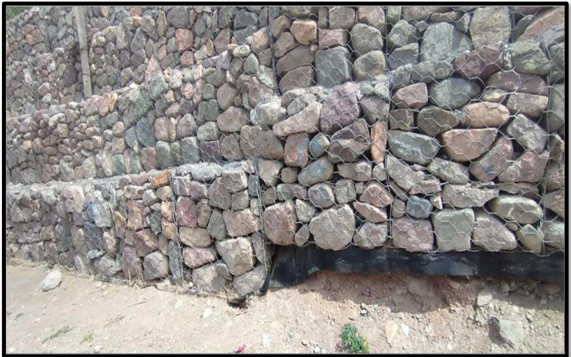
Foto 2. Visualización de socavación en el tramo 0+220
