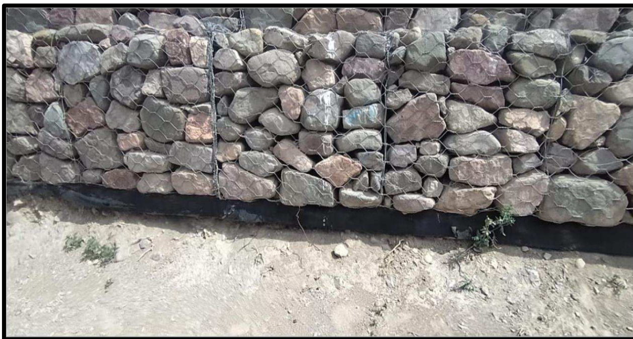
Foto 6. Visualización de socavación en el tramo 0+260
