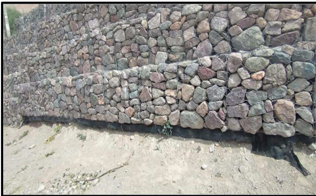
Foto 9 Visualización de socavación en el tramo 0+280
