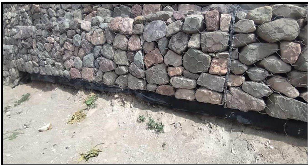
Foto 5 Visualización de socavación en el tramo 0+240
