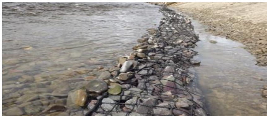
Figura 9.ejemplo de alabeo de un muro de gaviones.
