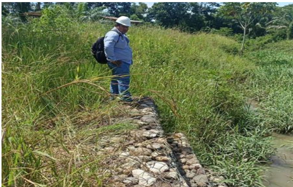
Imagen 08 : De los 50 metros evaluados, 3 metros presentan hundimiento en el muro de gavión- tramo 2, sección 5- de 160 a 210 m- tramo 2, sección 5- de 160 a 210 m.
