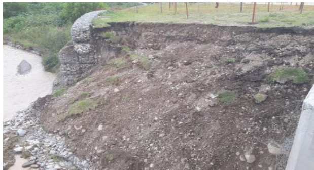
Figura 10.Colapso de gavión por deslizamiento de terreno.
