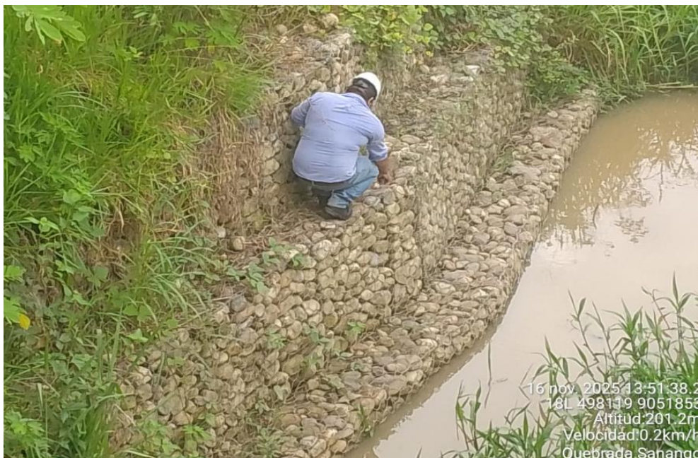
Imagen 07: se observó variación de la dimensión de los peldaño el del tramo 02, sección 4 de 120 a 160 m
