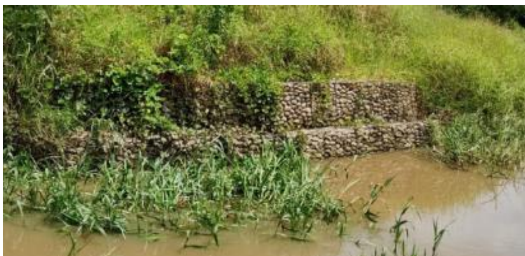
Imagen 16: La única parte que se puede evaluar en tramo 04, sección 9 - de 340 a 380 m.
