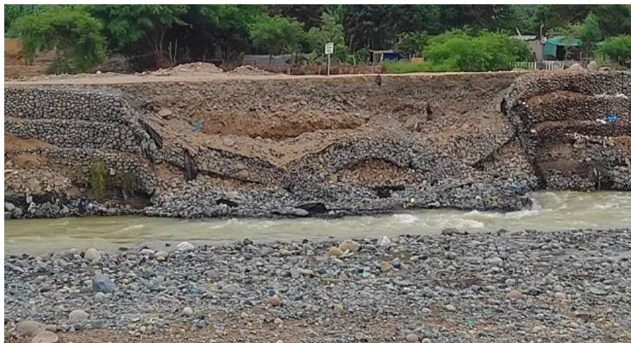
Figura 11.Desplome de muro de gavión en el rio aja en Nasca.
