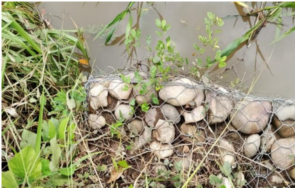
Imagen 09: Se observó abultamientos en la zona superior frontal que sobresale y deforma a la estructura- tramo 2, sección 5- de 160 a 210.
