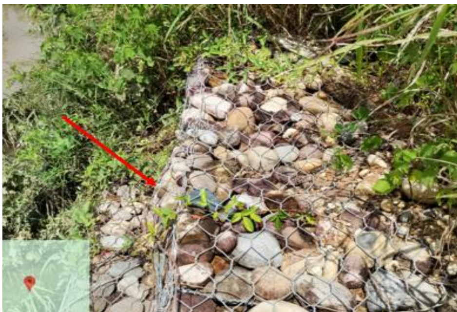
Imagen 02: Se muestra deformación en el muro de gaviones en el tramo 01, sección 1- de 01 a 40 m.
