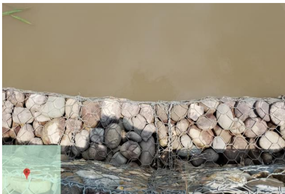
Imagen 14: Se observó se constató disminución de la dimensión de 50 a 40 cm de los peldaños en el tercer y cuarto nivel, tramo 03, sección 7- de 210 a 260- 300 m.
