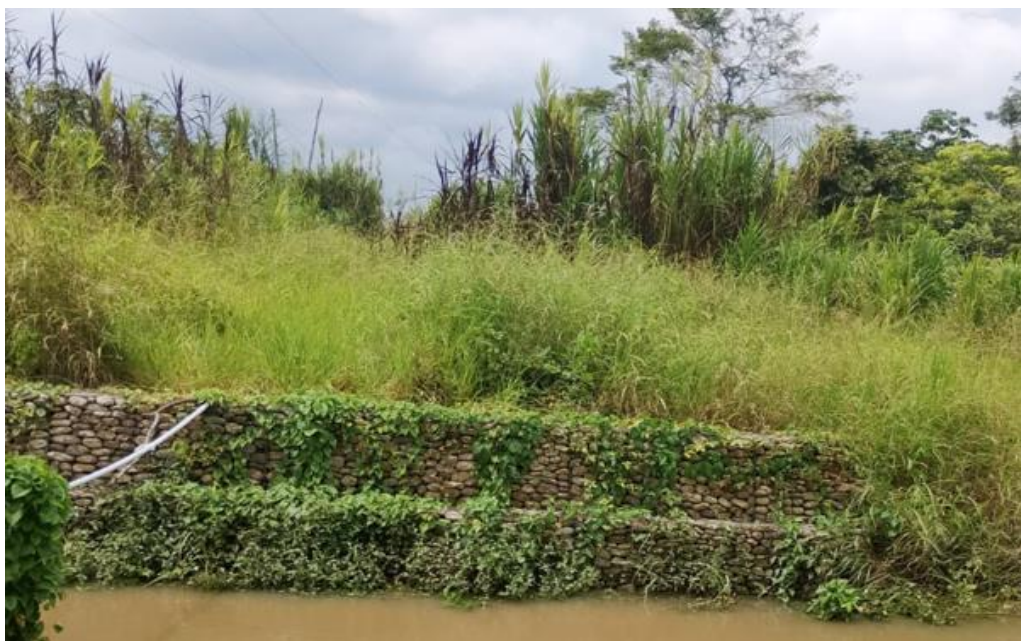
Imagen 17: La única parte que se puede evaluar en tramo 04, sección 10 - de 380 a 420 m.
