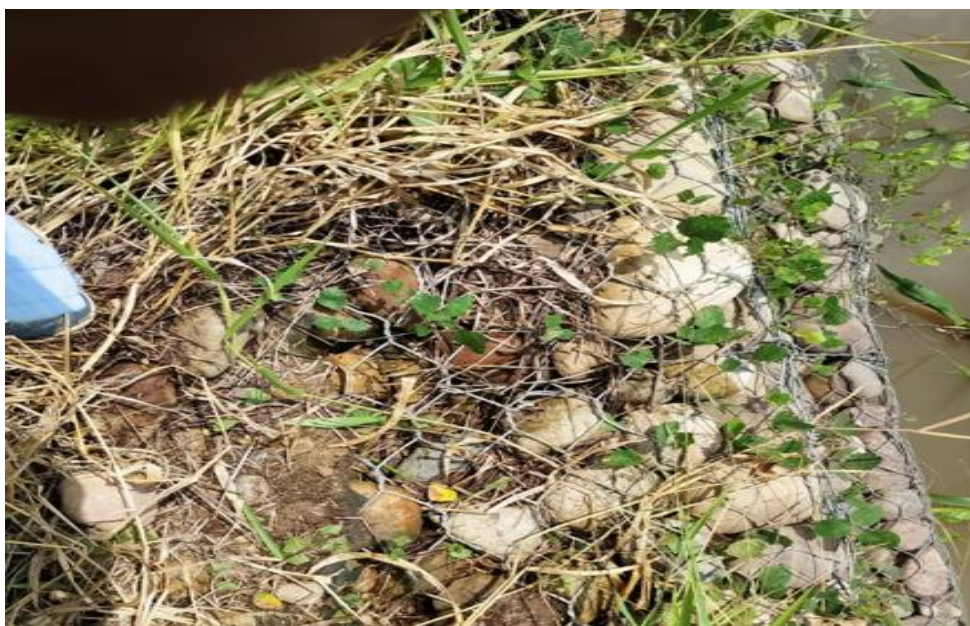
Imagen 10: De los 50 metros evaluados, 3 metros presentan hundimiento en el muro de gavión- tramo 2, sección 5- de 160 a 210 m
