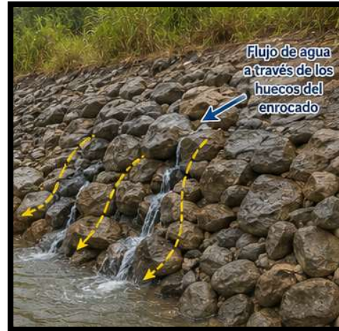
Figura 14: Deficiencias del enrocado por permeabilidad
