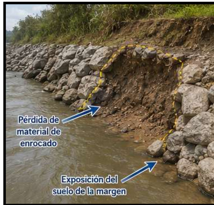
Figura 12: Deficiencias del enrocado por erosión
