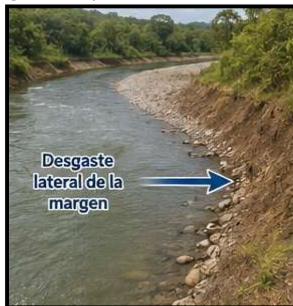
Figura 24: Erosión fluvial lateral
