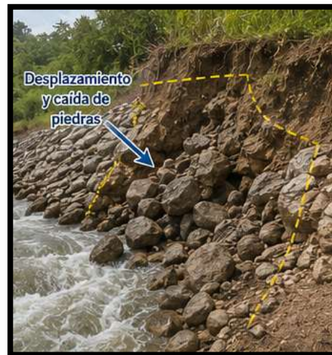
Figura 15: Deficiencias del enrocado por estabilidad
