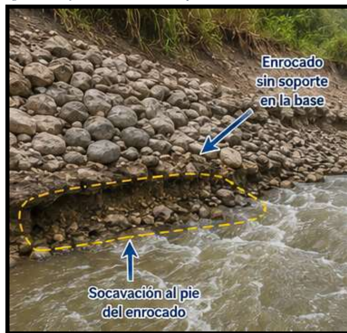
Figura 13: Deficiencias del enrocado por socavación
