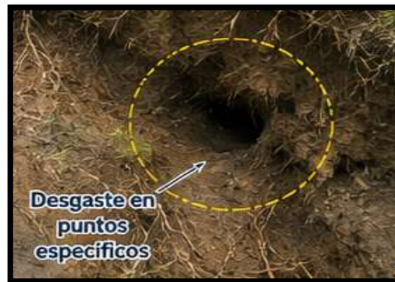
Figura 25: Erosión fluvial localizada
