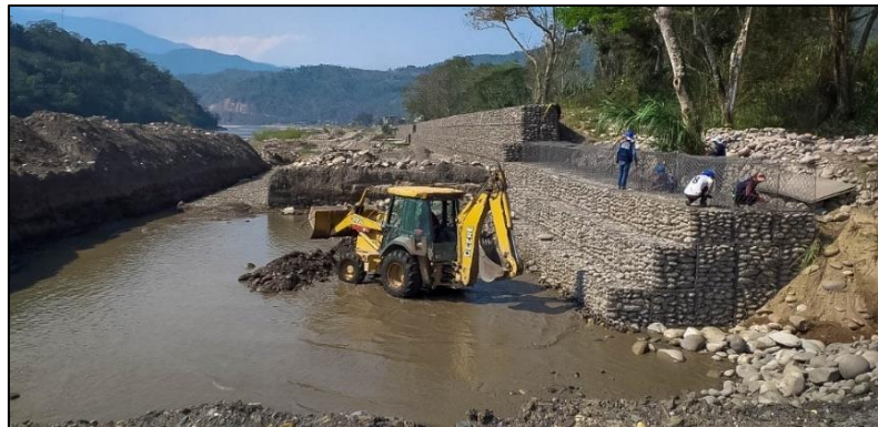
Figura 14: Defensa ribereña con gaviones en río Apurímac.
