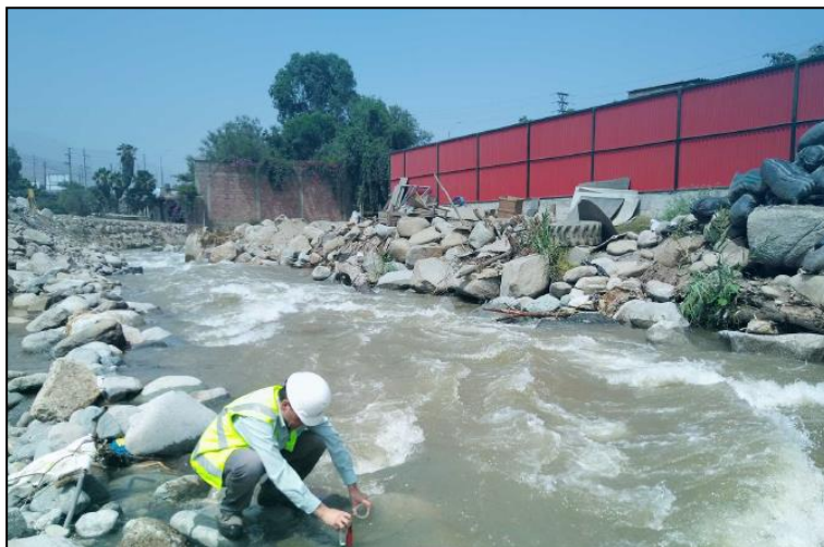
Figura 3: Dique enrocado deteriorado
