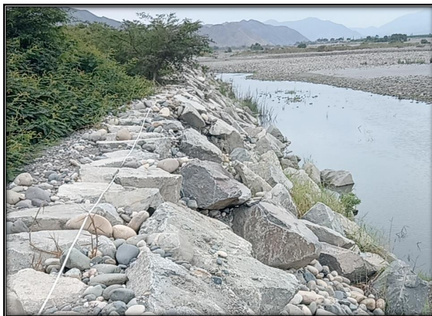
FOTO 09: Otra vista en otro tramo de la corona. Se realiza la medición longitudinal. Nótese el desacomodo de la protección de enrocado y la exposición de material granular.
