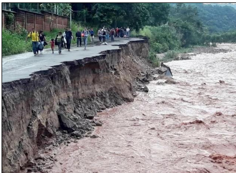
Figura 7: Socavación por acción de río
