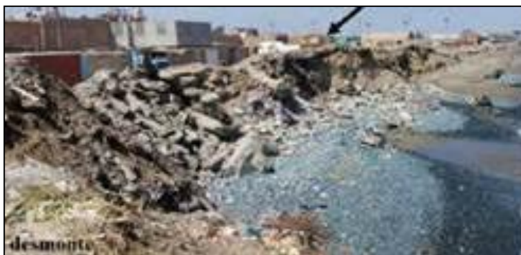
Figura 4: Enrocado muy deteriorado
