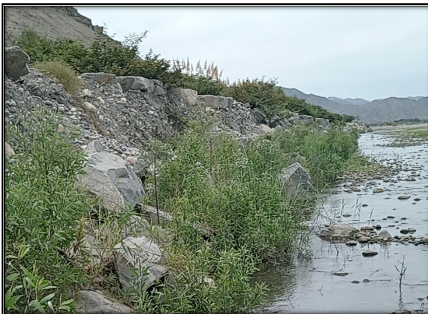
FOTO 08: Aquí se puede apreciar la ausencia de enrocado en la parte superior del talud quedando parcialmente sin protección y en la parte inferior se encuentra las rocas totalmente desacomodadas.
