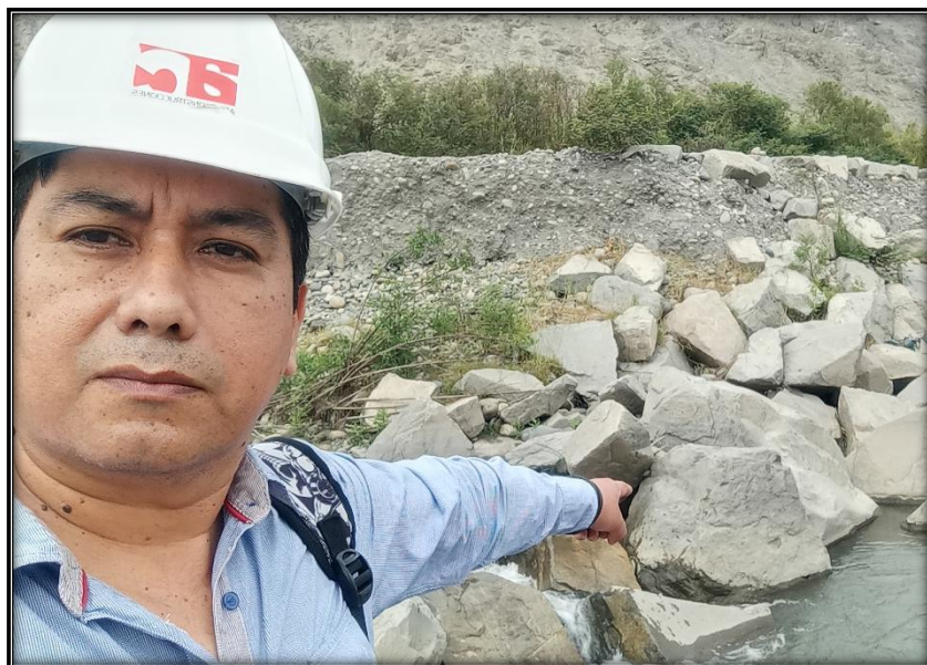
FOTO 05: Se indica la condición de colapso del enrocado, uno de varios sectores donde se aprecia notoriamente.
