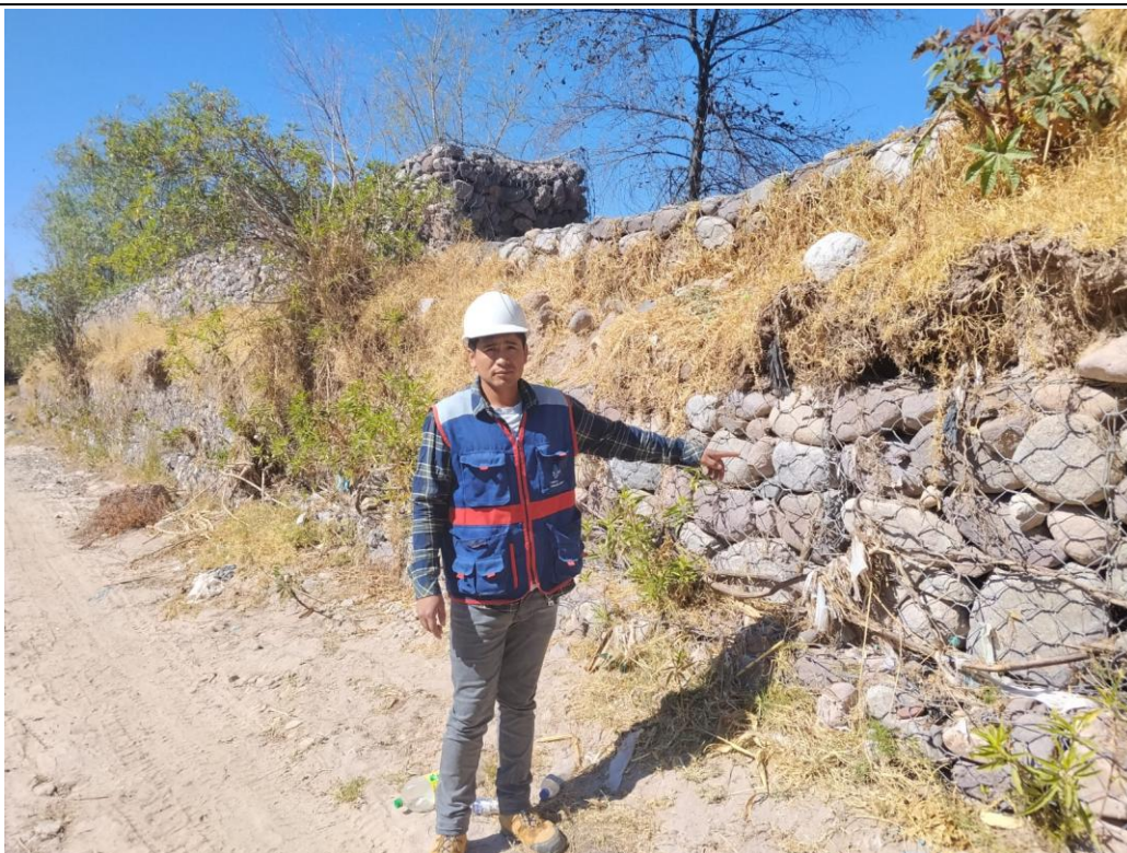
Fotografía 06: Falla estructural por rotura de canastilla metálica y desmoronamiento de piedras de relleno.
