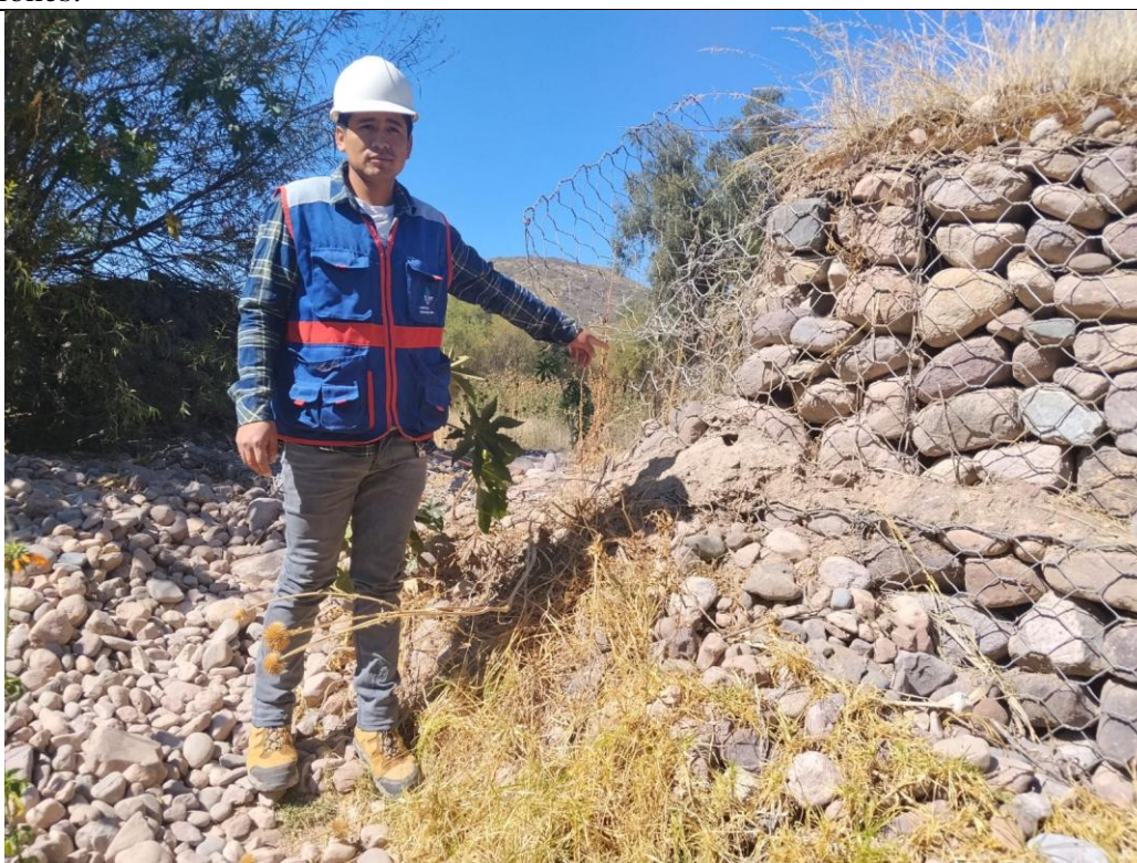
Fotografía 04: Falla estructural por rotura de canastilla metálica y desmoronamiento de piedras de relleno.
