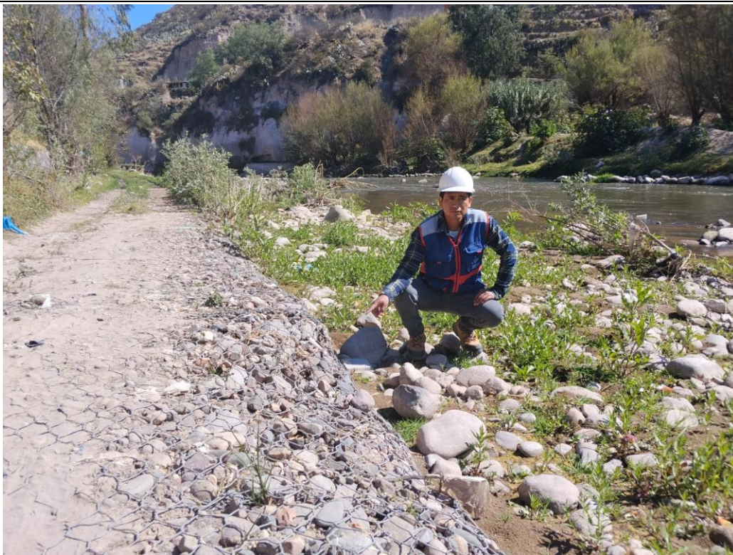
Fotografía 05: Pérdida de la sección vertical del muro de gaviones y exposición al cauce activo.
