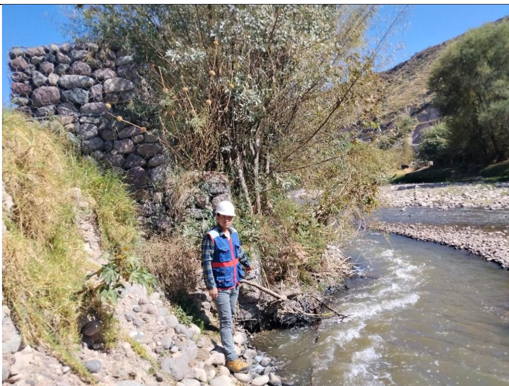
Fotografía 13: Falla estructural por rotura de canastilla metálica y desmoronamiento de piedras de relleno.
