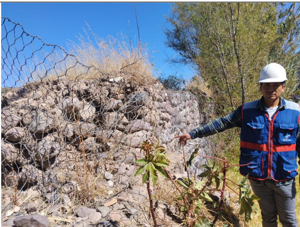
Fotografía 03: Deformación estructural y desalineamiento en la corona del muro de gaviones.
