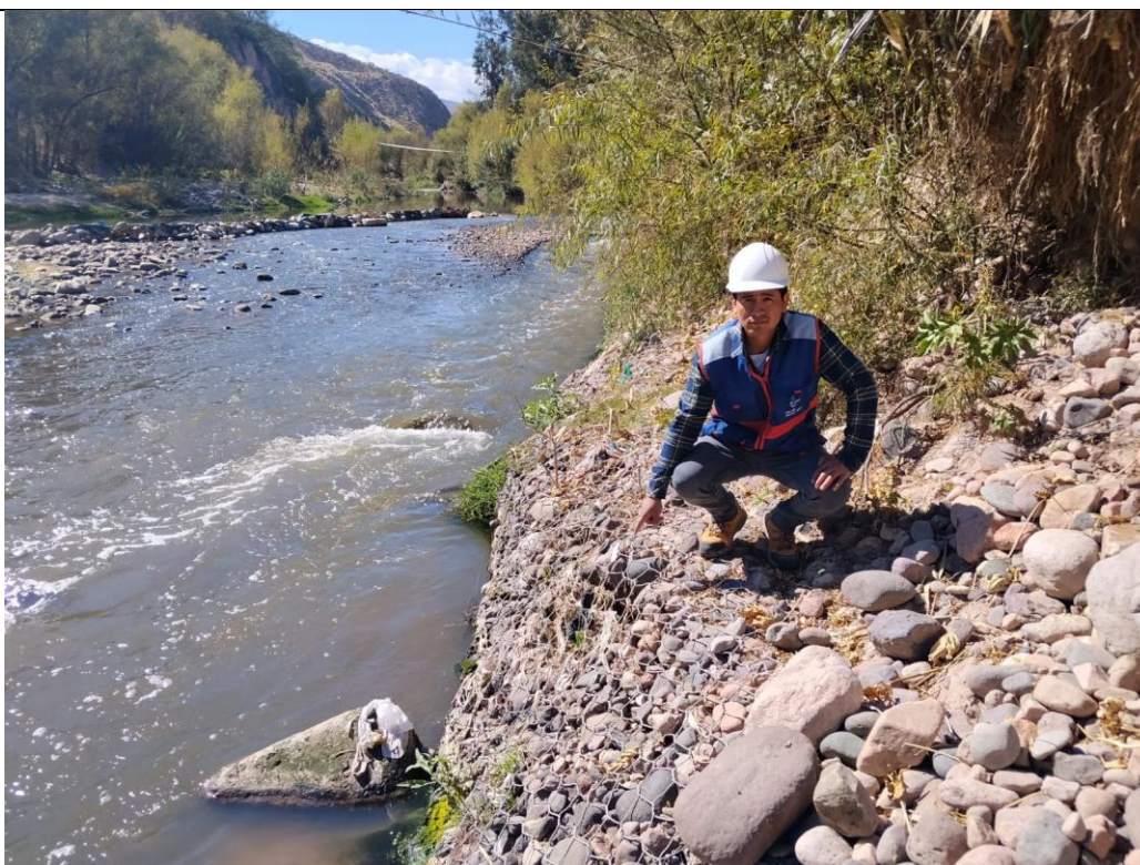
Fotografía 09: Deformación y pérdida de rigidez en el colchón de gavión expuesto al cauce.
