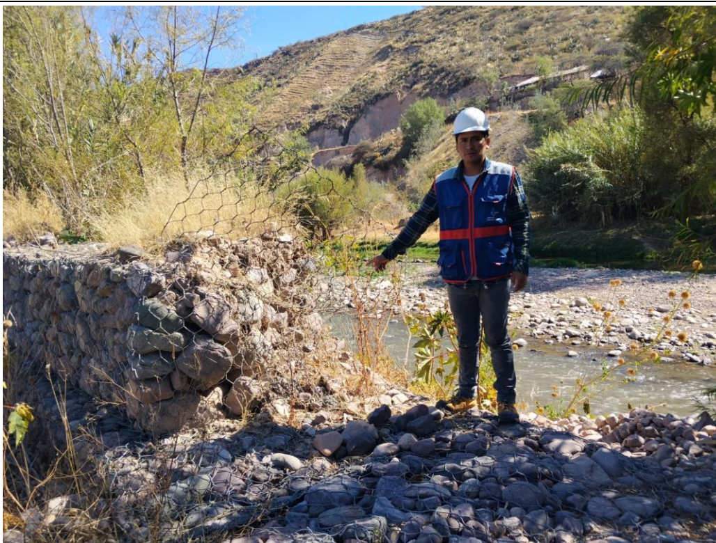
Fotografía 14: Falla por desanclaje estructural y exposición del núcleo de piedras de relleno.
