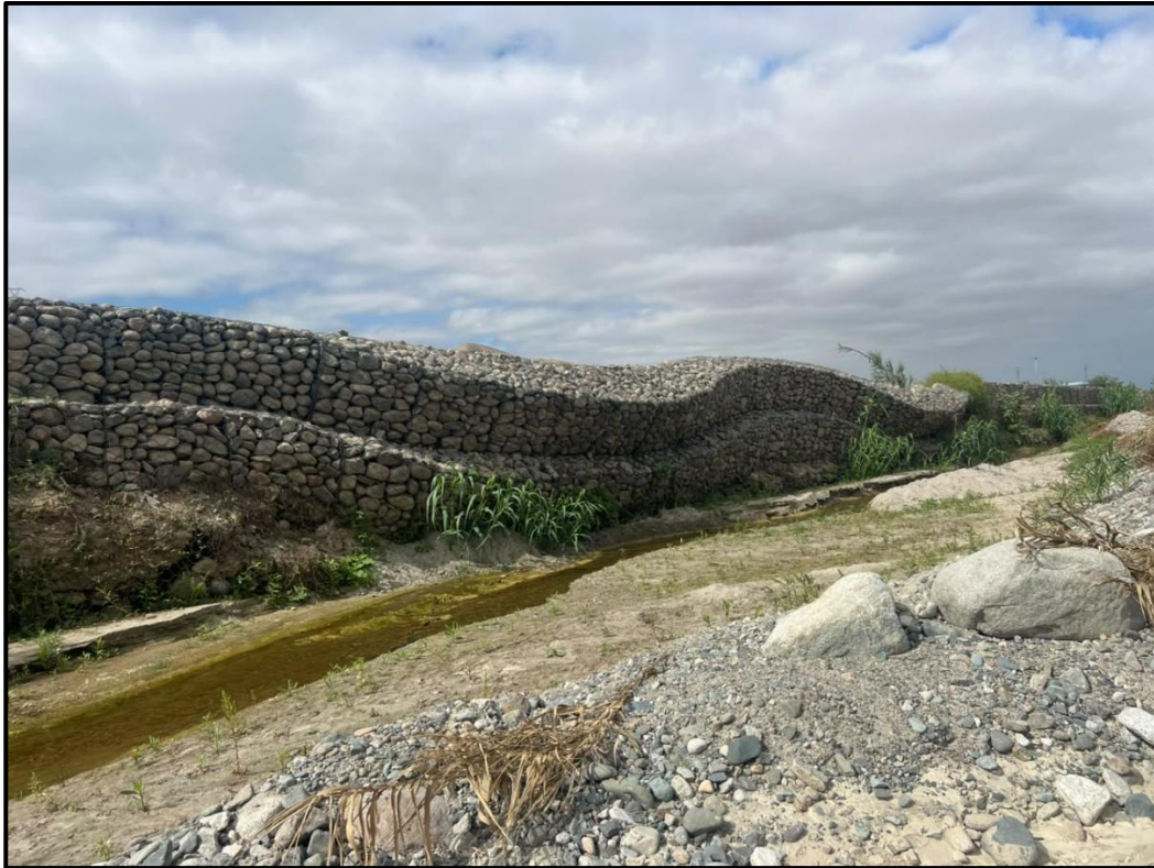
Descripcion: deformacion longitudinal de la defensa ribereña y hundimiento del terreno
