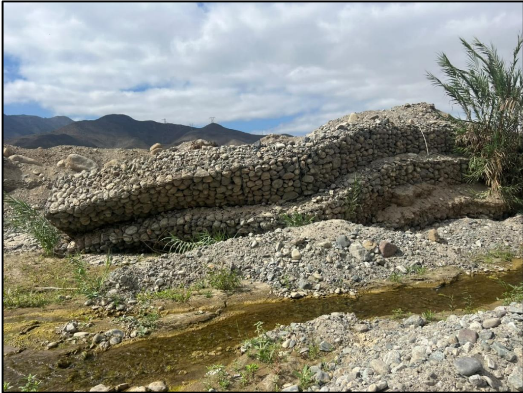
Descripcion: Volcamiento en tramo final de la defensa ribereña
