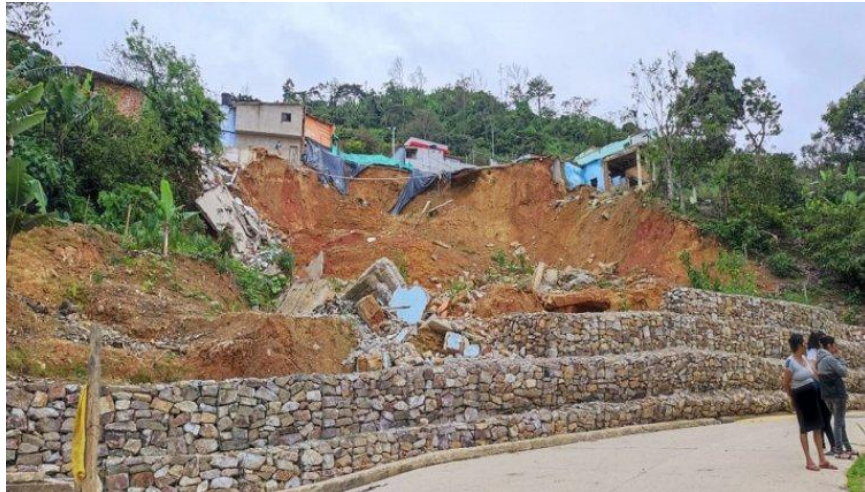
Figura 8: Falla de volcamiento por fuerza externa
