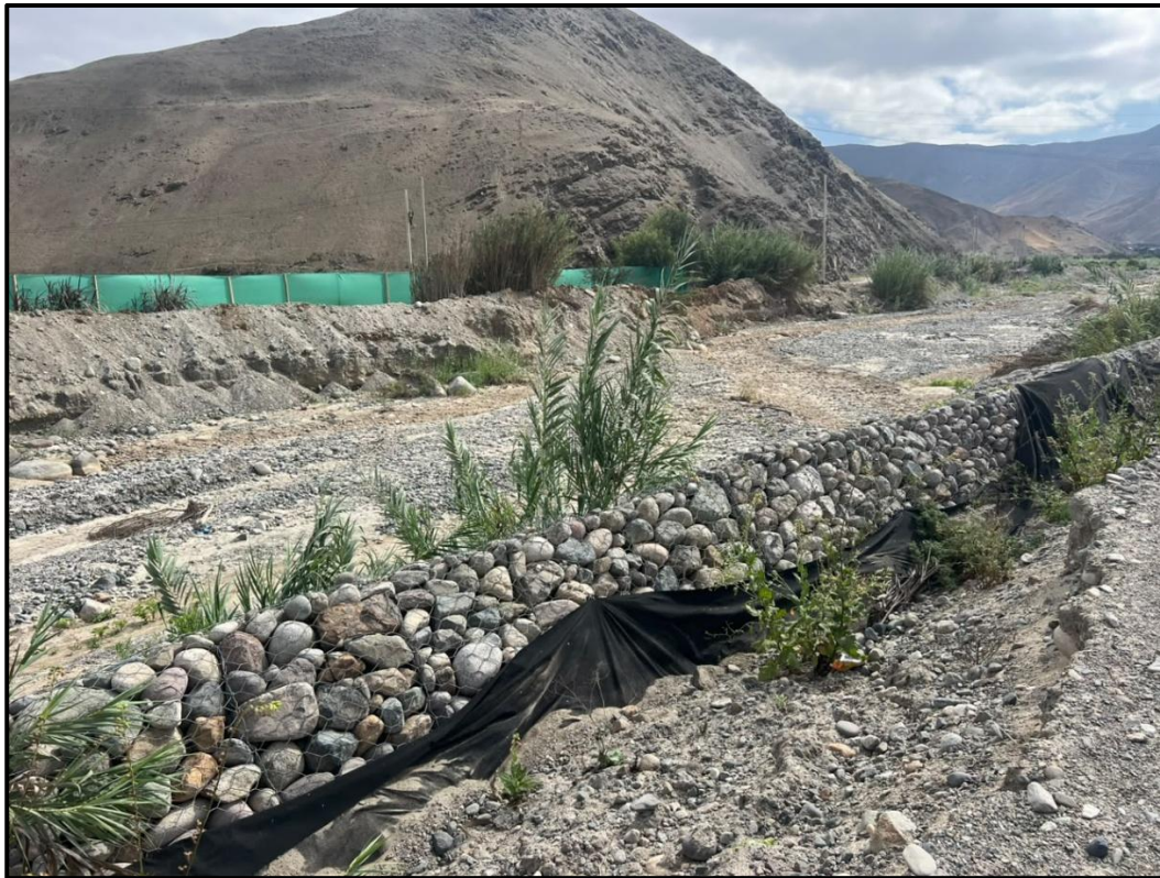
Descripcion: Volcamiento en muro de gaviones, geotextil desprendido
