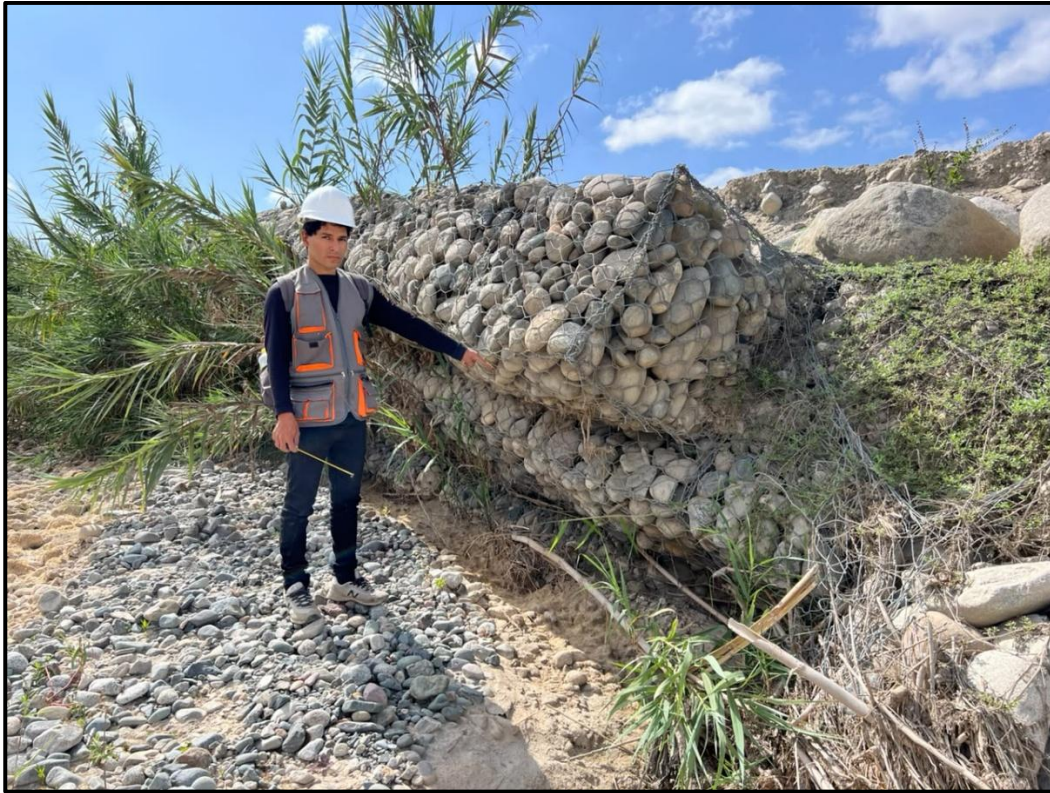
Descripcion: Señalización de vegetacion en muro de gaviones
