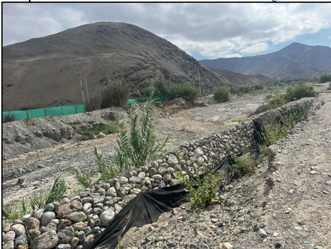
Descripcion: Geotetil roto, exposicion de malla de gaviones, volcamiento en todo el tramo
