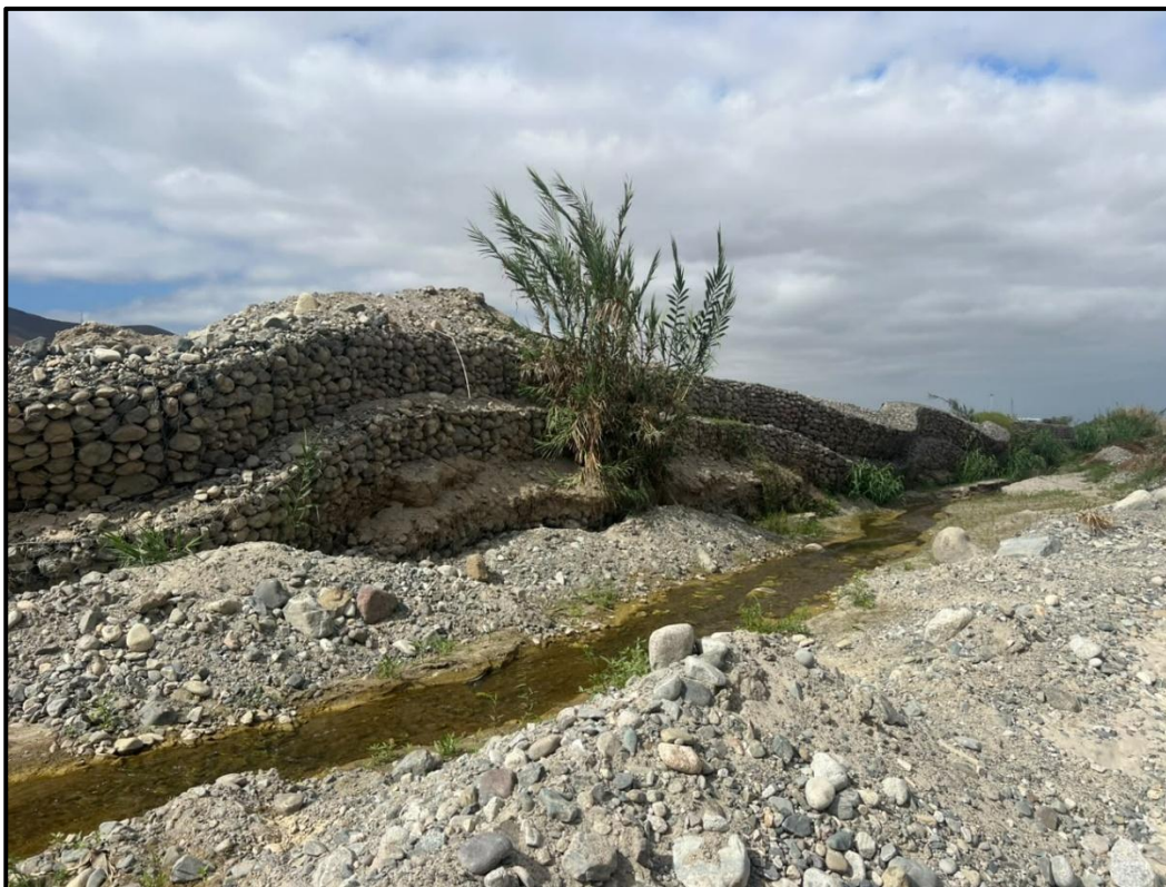
Descripcion: Presencia de erosion en la parte inferior del muro de gaviones, deformacion longitudinal.
