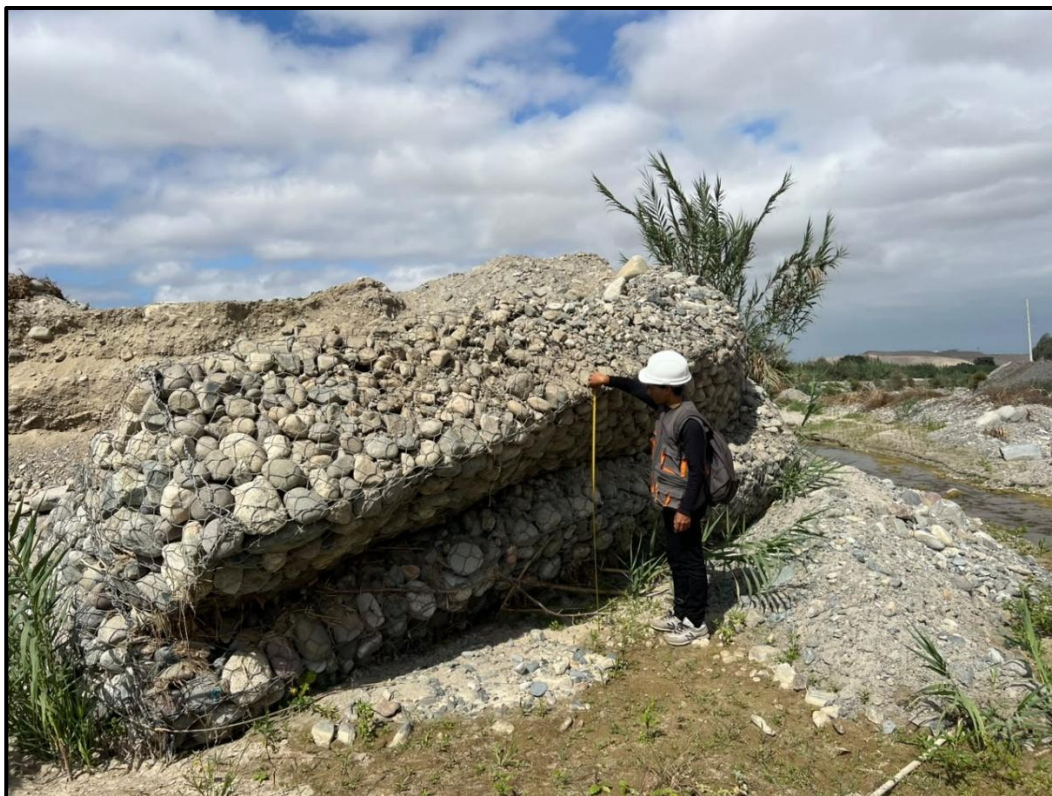
Descripcion: Medicion de altura de muro de gaviones, presencia de volcamiento
