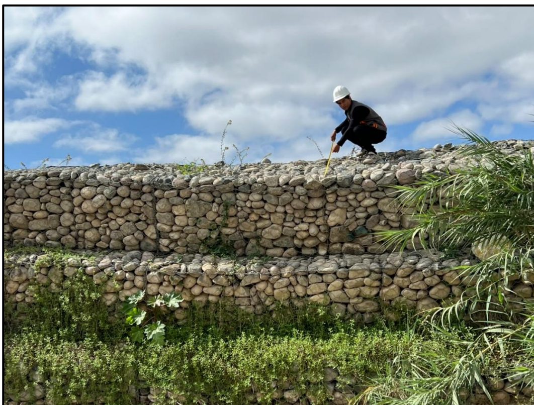
Descripcion: Medicion de ancho de gavion, nivel superior y presencia de vegetacion en la defensa ribereña.
