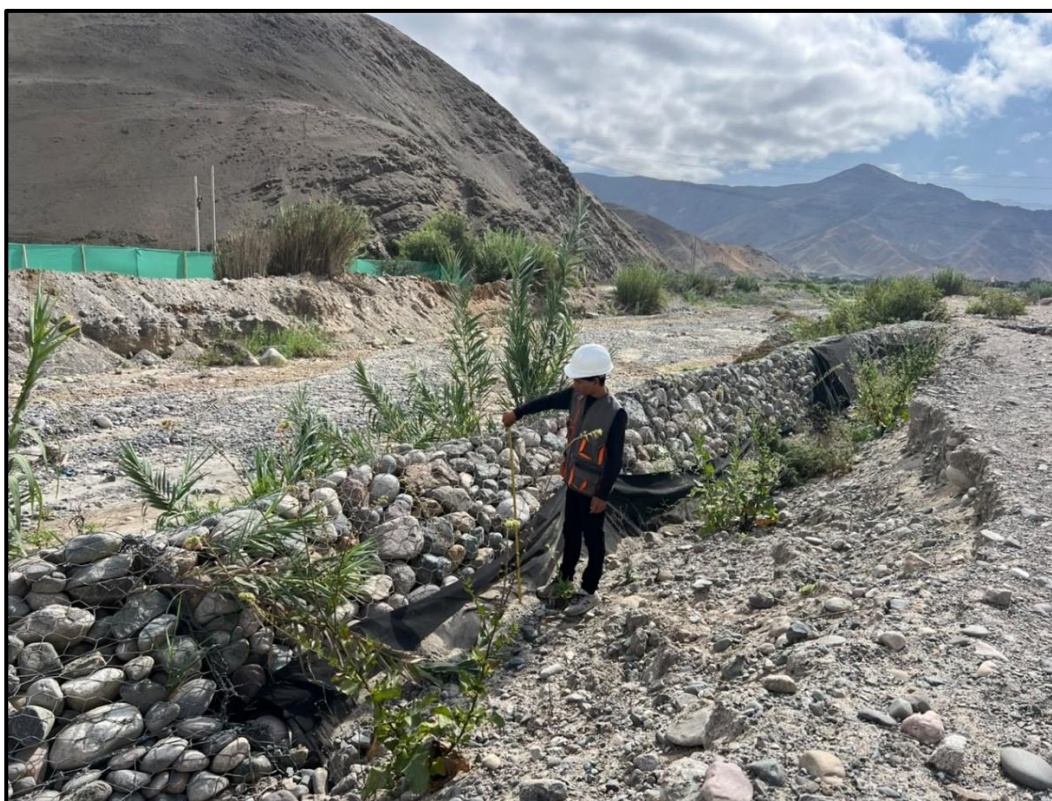
Descripcion: Presencia de volcamiento en muro de gaviones, por socavaciones
