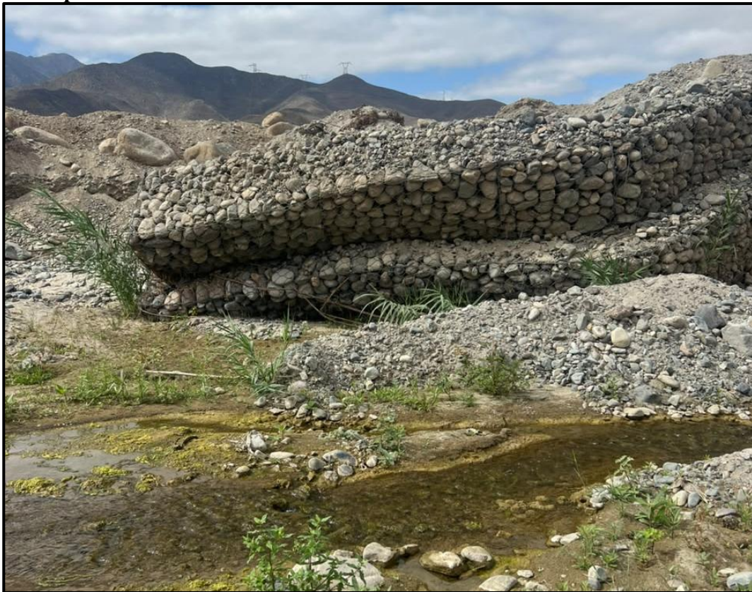
Descripcion: Presencia de erosion en la parte baja del muro de gaviones
