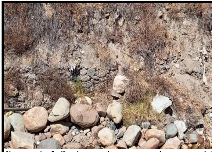
Ilustración 5: Se observa desmonte en el contorno del muro de gavión, además se observan piedras grandes en la base de la estructura.
