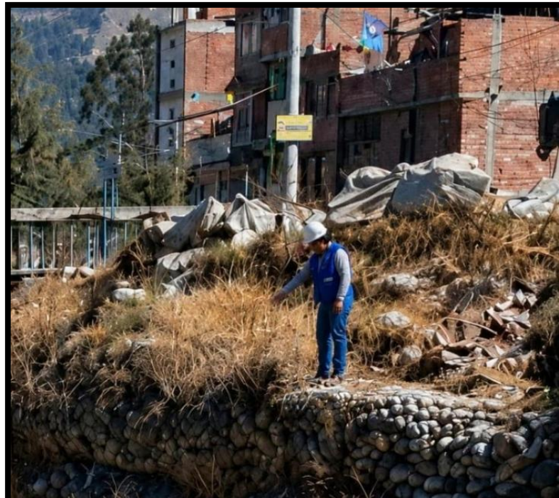
Ilustración 7: Verificando la condición del muro en la prog. 0+100 donde se observa volteo del muro de gaviones, así como rotura de malla.
