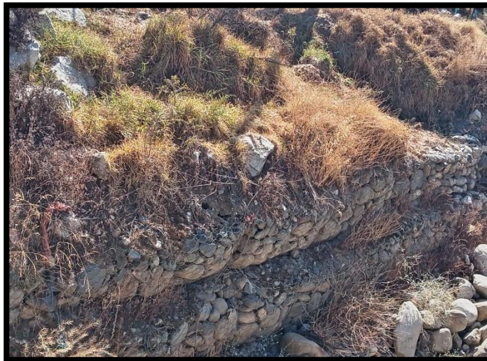
Ilustración 4: Pérdida del eje horizontal en la parte superior con inclinación localizada hacia el frente.
