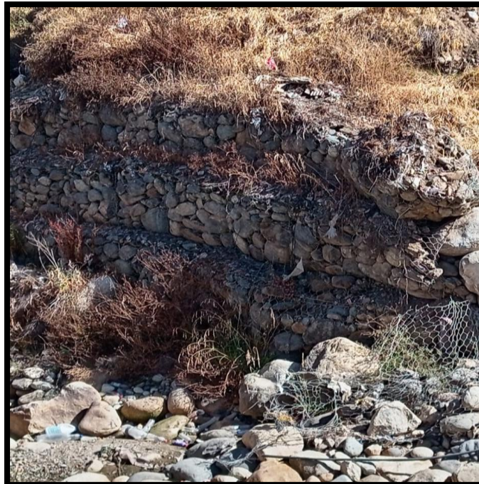
Ilustración 2: Se observa la rotura de la malla en el segundo tramo evaluado, así como la socavación de la base que está presente en el tramo evaluado.
