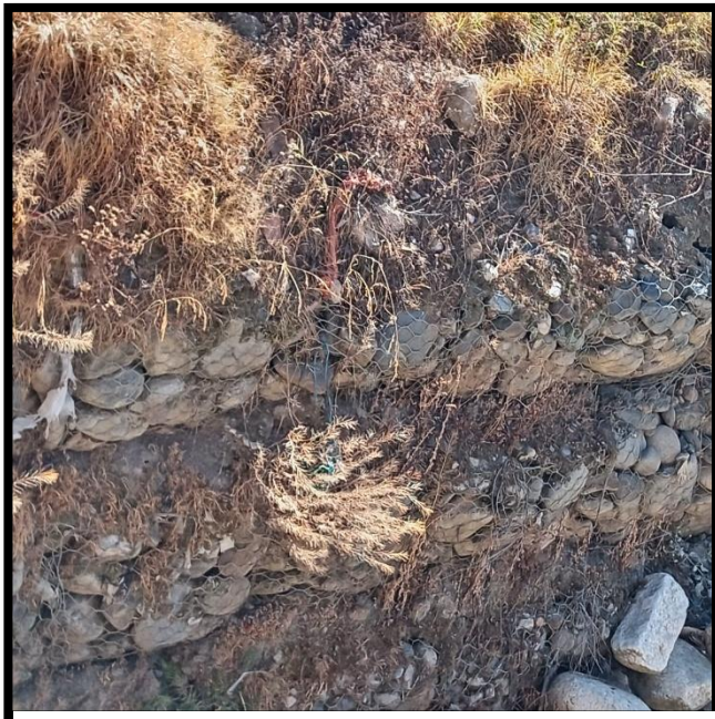
Ilustración 3: Panzamiento pronunciado de la cara frontal por falla o rotura de los tirantes internos y empuje excesivo del relleno.
