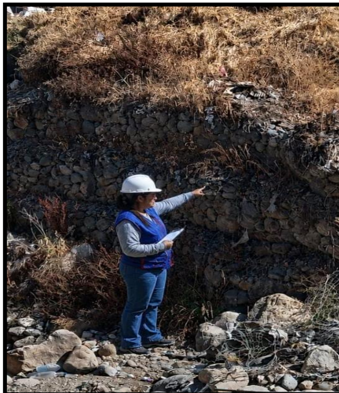
Ilustración 6: Señalando el área de rotura de malla, así como el abombamiento de la cara frontal del muro.
