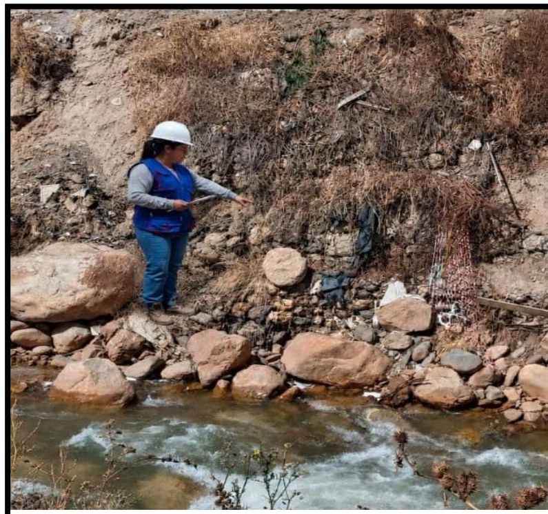
Ilustración 8: Se observa demasiado material de relleno y desmonte sobre el muro de gaviones, cubre parte de la estructura.
