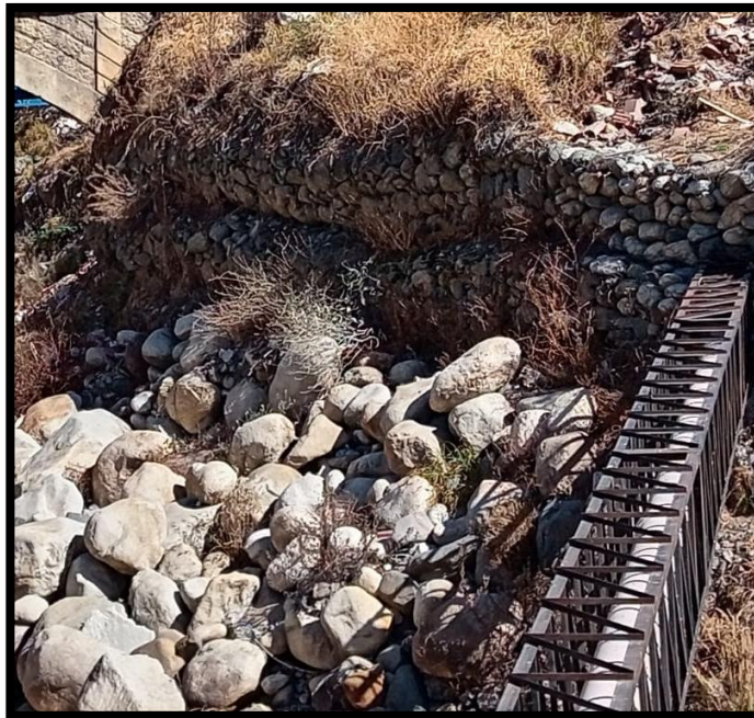
Ilustración 1: Se visualiza en el tramo de prog. 0+000 a la prog. 0+050; el desgaste de la malla, así como la inclinación del muro de gaviones.
