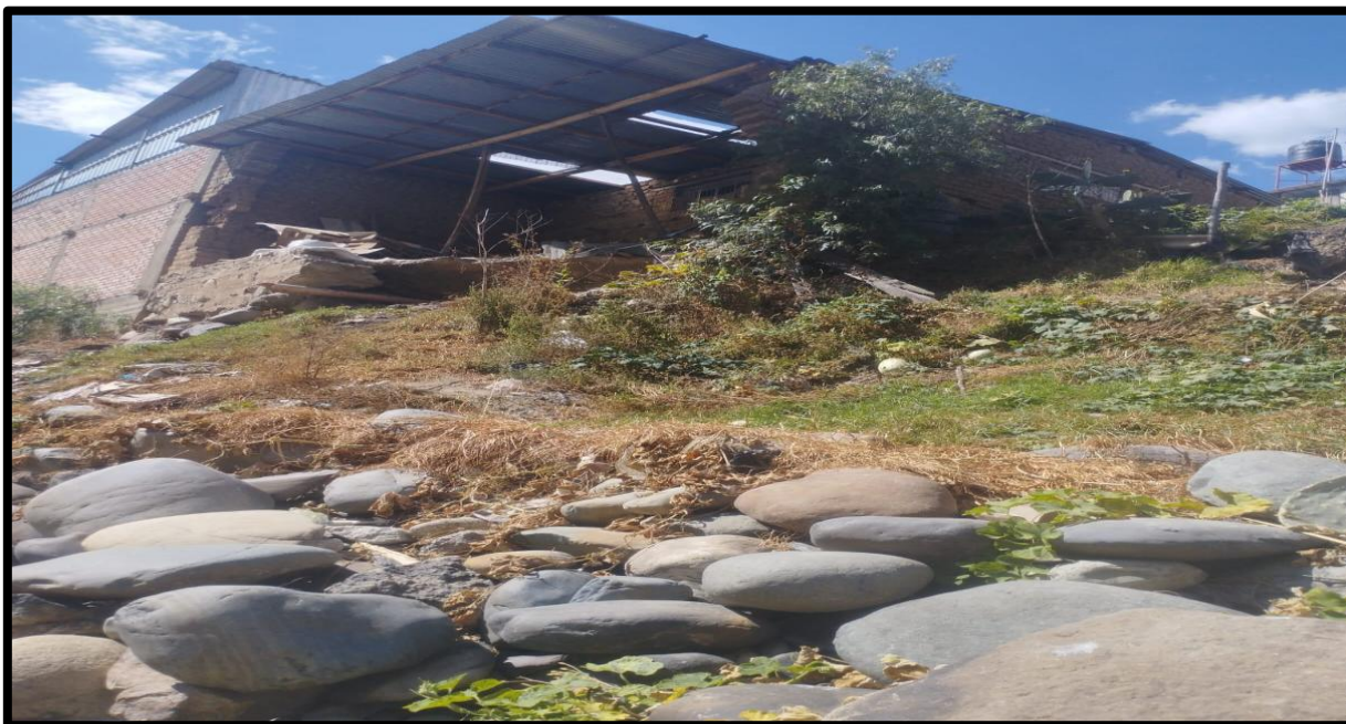
Fotografía 08: Evaluación de riesgo en edificaciones colindantes al margen donde se visualiza que el talud esta erosionado situándose directamente bajo edificaciones del sector de estudio.
