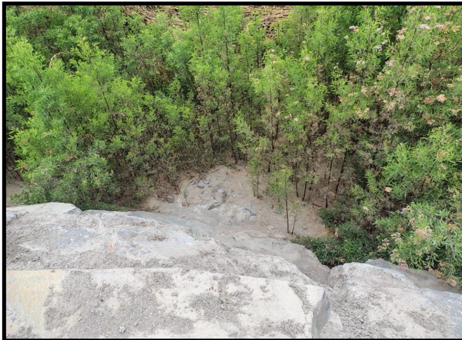
Figura 16. presencia de vegetación en el talud
