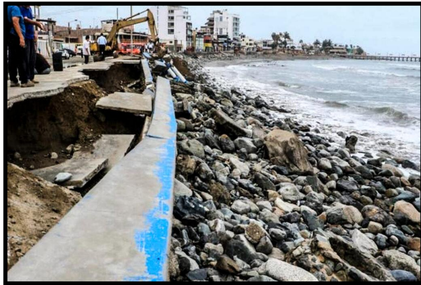
Figura 4. Colapso estructural debido a la socavación al pie de la estructura.
