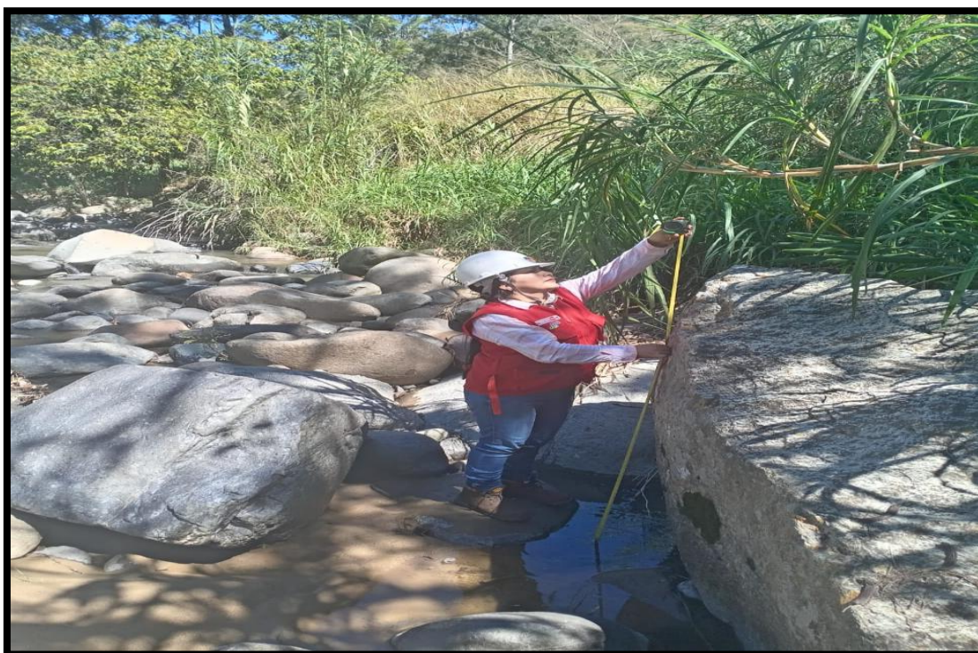
Figura 57: Medición de altura y descalce de gran bloque rocoso en la base del margen del río Quiroz en el tramo 0+450 – 0+500.
