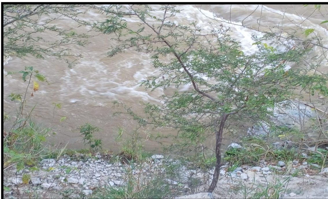
Figura 39: Estado del margen izquierdo del río Quiroz, tramo 0+150–0+200.
