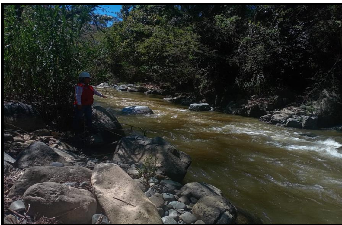
Figura 55: Inspección de campo del margen izquierdo e identificación de sector crítico por erosión lateral en el río Quiroz en el tramo 0+450 – 0+500.
