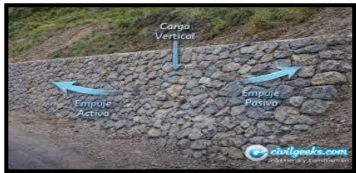
Figura 4: Muro de gaviones
