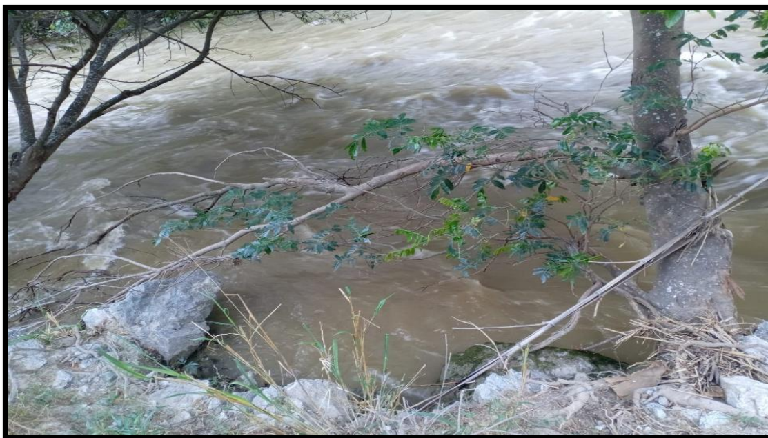
Figura 46: Socavación del pie del talud y desprendimiento de vegetación en el margen izquierdo del río Quiroz en el tramo 0+250 – 0+300.
