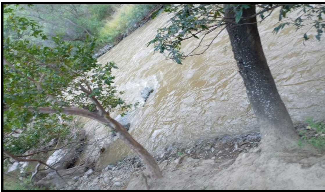
Figura 48: Descalce de raíces, erosión lateral alta e inestabilidad del talud ribereño en el río Quiroz en el tramo 0+350 – 0+400.
