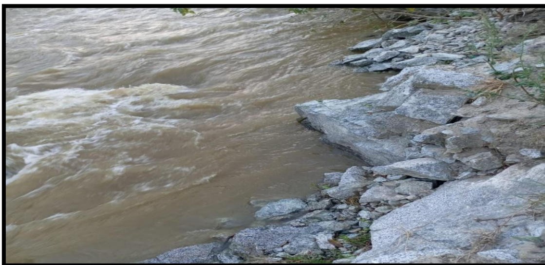
Figura 43: Socavación en la base del talud y erosión del margen del río Quiroz por acción del flujo en el tramo 0+200 – 0+250.
