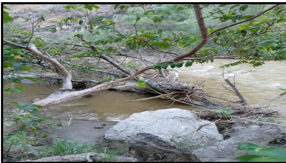
Figura 51: Colapso de vegetación, acumulación de palizada y descalce de talud en el río Quiroz en el tramo 0+350 – 0+400.
