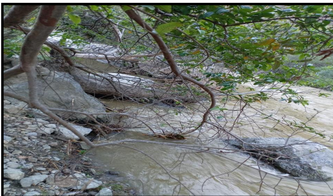
Figura 49: Descalce de raíces, exposición de vegetación y pérdida de soporte por socavación en el río Quiroz en el tramo 0+350 – 0+400.
