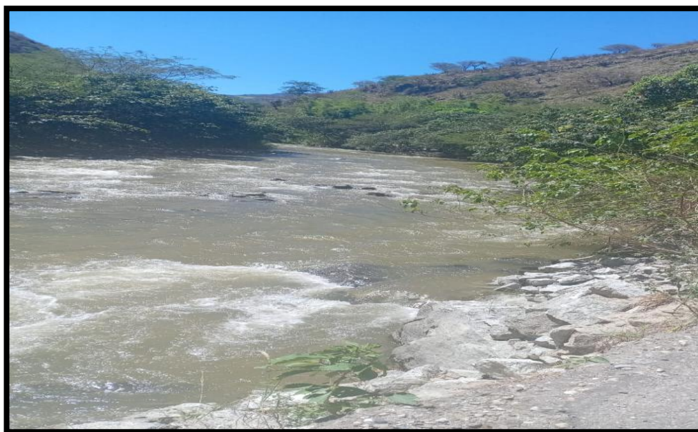
Figura 41: Erosión del margen izquierdo y deterioro del talud del río Quiroz en el tramo 0+200 – 0+250..
