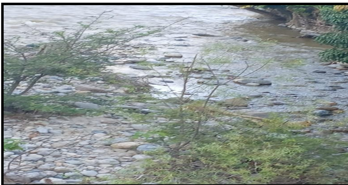
Figura 33: Estado del cauce y del margen ribereño, tramo 0+100–0+150.
