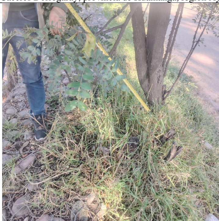
Foto 06: Observación de presencia masiva de vegetación en río Huatatas, tramo 0+555 - 0+605 C.P. Glorieta, distrito Andrés Avelino Cáceres Dorregaray, provincia de Huamanga, región Ayacucho.
