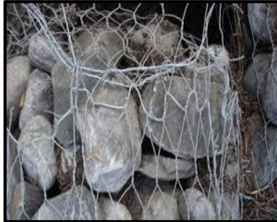
Figura 17: Rotura de malla
