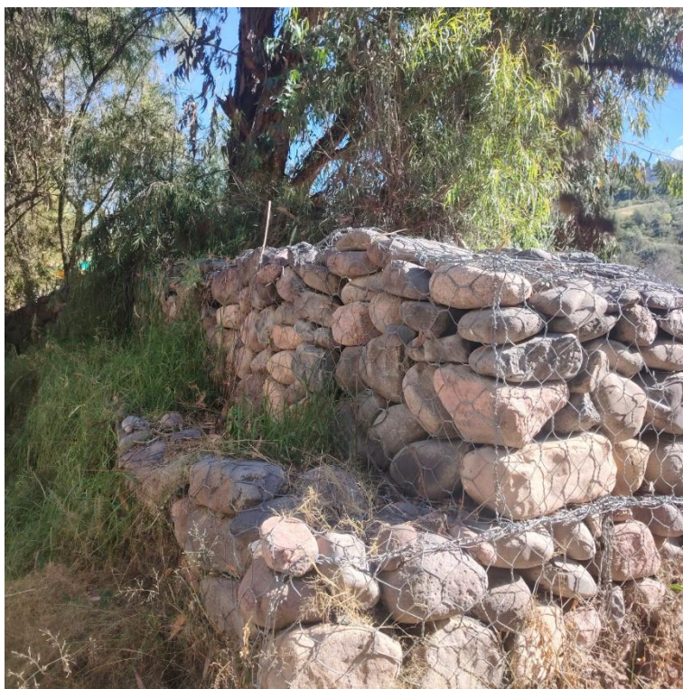
Foto 07: Vista de gavi3n en el r3o Huatatas, tramo 0+605 – 0+705 C.P. Glorieta, distrito Andr3s Avelino C3ceres Dorregaray, provincia de Huamanga, regi3n Ayacucho.
