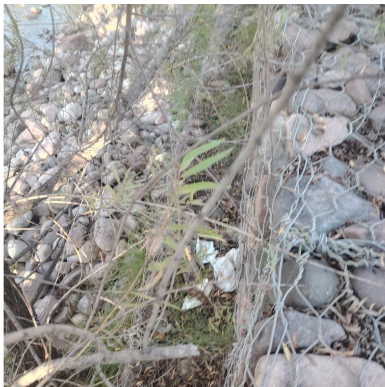
Foto 14: Deterioro de maya en muro de gavión río Huatatas, tramo 0+755 - 0+760 C.P. Glorieta, distrito Andrés Avelino Cáceres Dorregaray, provincia de Huamanga, región Ayacucho.
