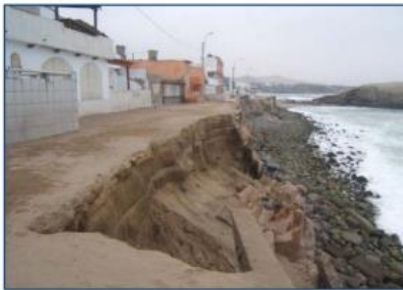
Figura 8. Sector Punta Hermosa (distrito Punta Hermosa), carretera afirmada afectada por la erosión marina.
