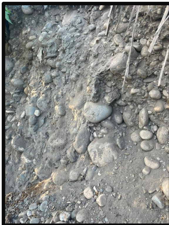
Fotografía 10: Evaluación del tramo 1 del enrocado donde se visualiza la falta de enrocado.
