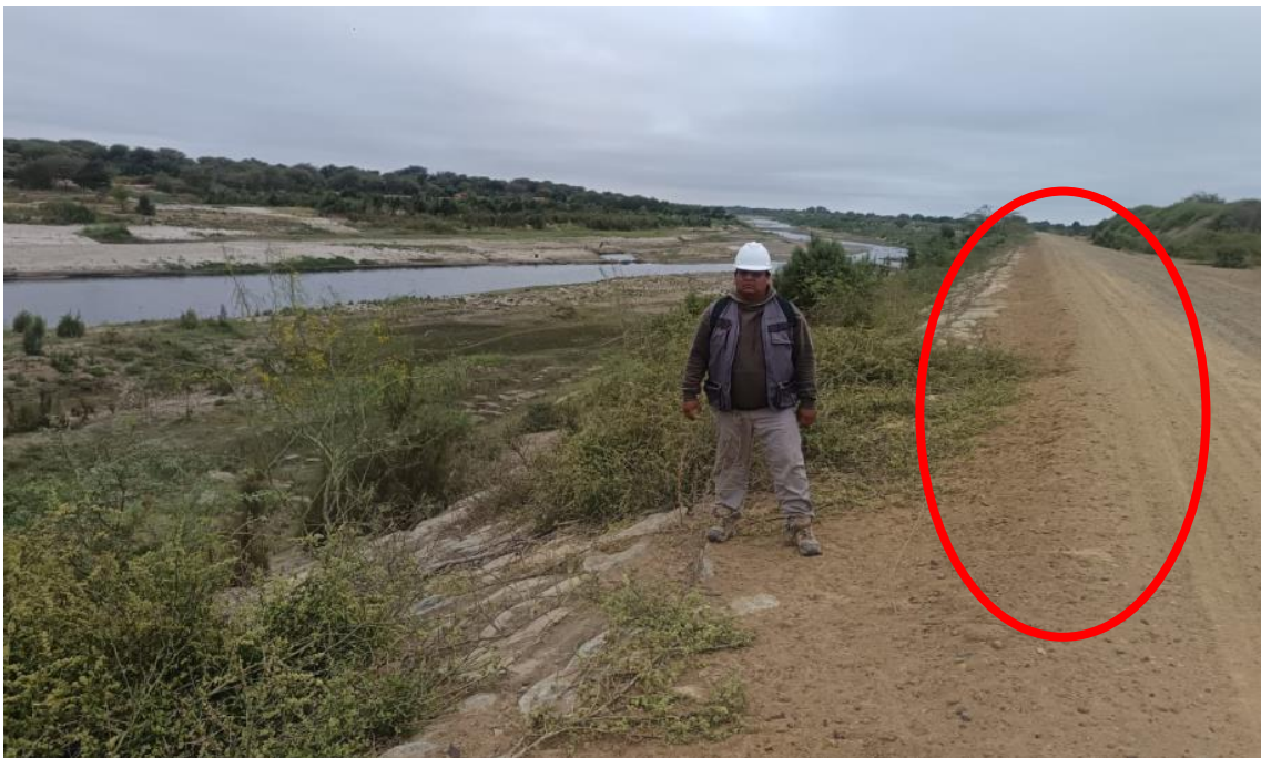
Fotografía 08: se determina desgaste de la capa de rodadura del dique Fuente: Propia
