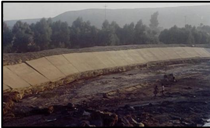
Figura 6: Socavación de defensa ribereña
