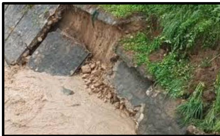
Figura 7: Erosión de defensa ribereña
