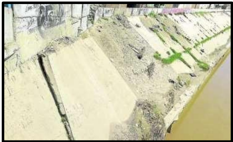
Figura 8: Defensa ribereña dañada
