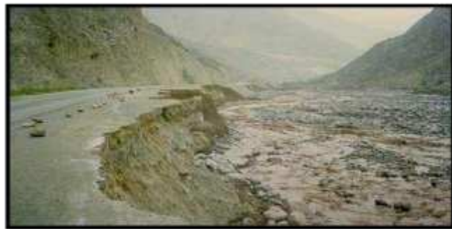
Figura 2: Socavación en la margen de un río. Fuente: Wikimedia (19)
