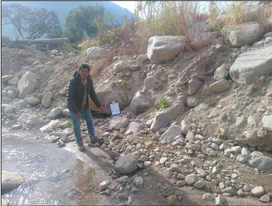
Figura 19. Observación y medición de evidencias de erosión y socavación en la margen del río Huarmamayo.
